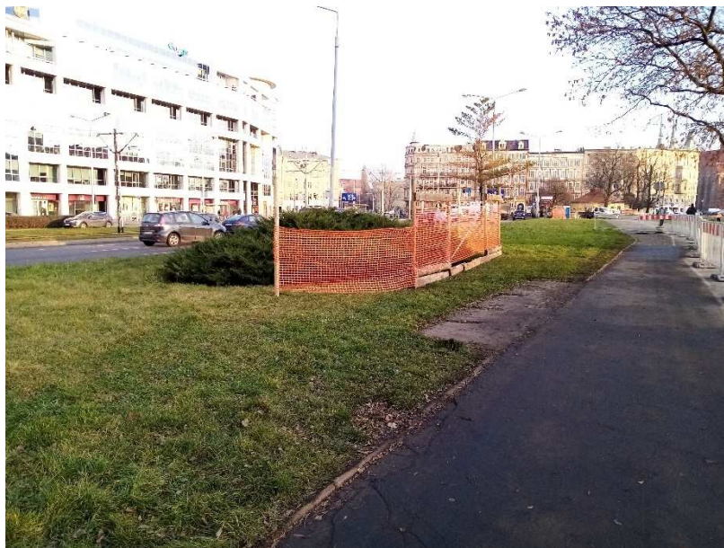
Fot. 1. Przykład wygradzenia chroniącego grupę krzewów przed zasypaniem (Wykonanie i fotografie K. Barski).
