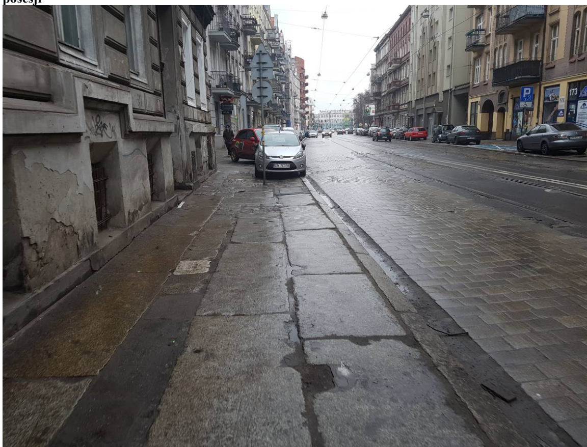
Rysunek 8 Chodnik przy ul. Kościuszki za skrzyżowaniem z ul. Więckowskiego po stronie parzystych nr posesji
