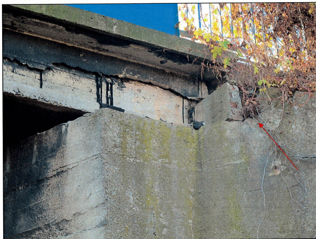
Rys. 5.9. Przesunięcie murku ceglanego oraz wykruszenie betonu skrzydełka podpory P1 od strony stacji Wrocław Główny
