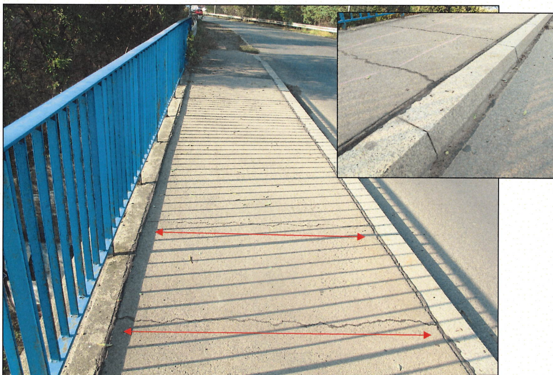
Rys. 5.12. Balustrada i chodnik od strony Kobierzyc. Spękania poprzeczne w nawierzchni chodnika, rozległe odspojenia nawierzchni
