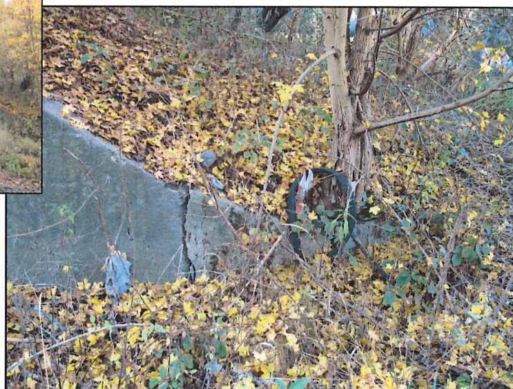
Rys. 5.16. Skrzydło przyczółka od strony Centrum/ Wrocław Centralny – przesunięcie murku oporowego na zakończeniu skrzydła oraz krzewy porastające w bezpośredniej bliskości skrzydła
