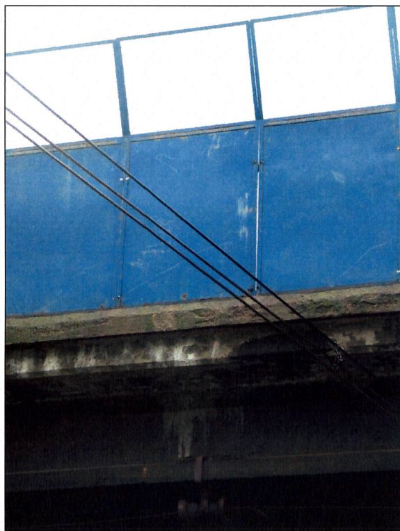
Rys. 5.5. Zacieki wapienne głównie na bocznej powierzchni wspornika podchodnikowego pod belką gzymsową – widok od strony wschodniej
