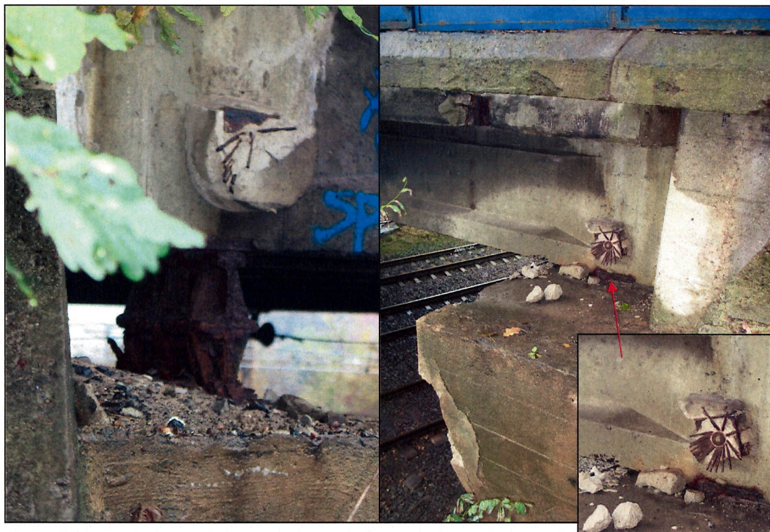
Rys. 5.11. Korozja powierzchniowa wahaczy na podporze P2 – widok od strony wschodniej. Zanieczyszczenia w postaci piasku i gruzu na ławie podłożyskowej
