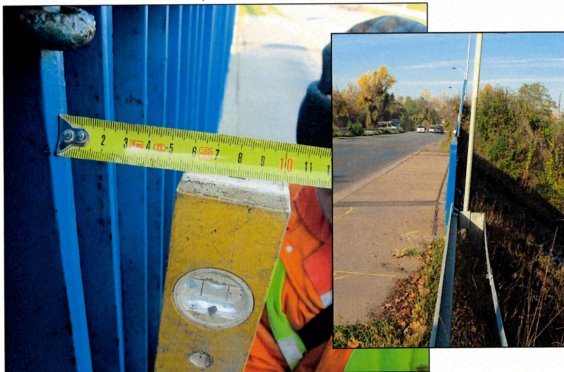
Rys. 5.14. Wychylenie balustrad i ekranów przeciwporażeniowych na zewnątrz obiektu
