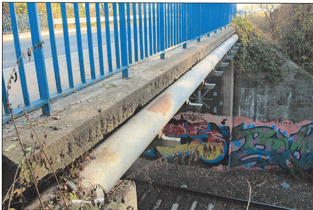
Rys. 5.14. Rurociąg oraz mocowanie rurociagu od strony Kobierzyc; miejscowe ogniska korozji powierzchniowej
