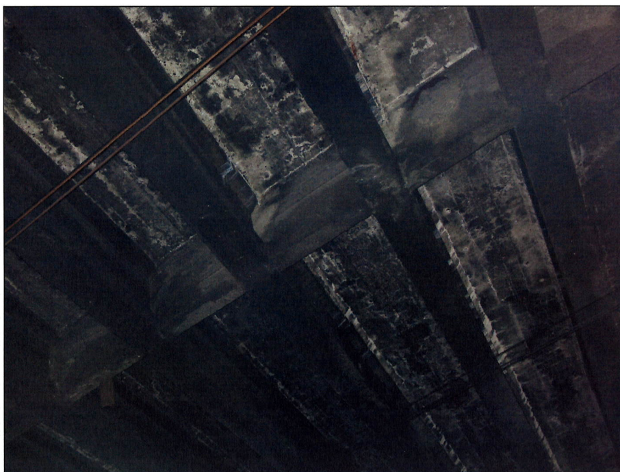
Rys. 5.3. Wykwity wapienne oraz rdzawe na spodzie płyty pomostowej oraz poprzecznicy przęsłowej pomiędzy belkami B2 ÷ B4. Zacieki wapienne na styku płyty pomostowej i belek prefabrykowanych
