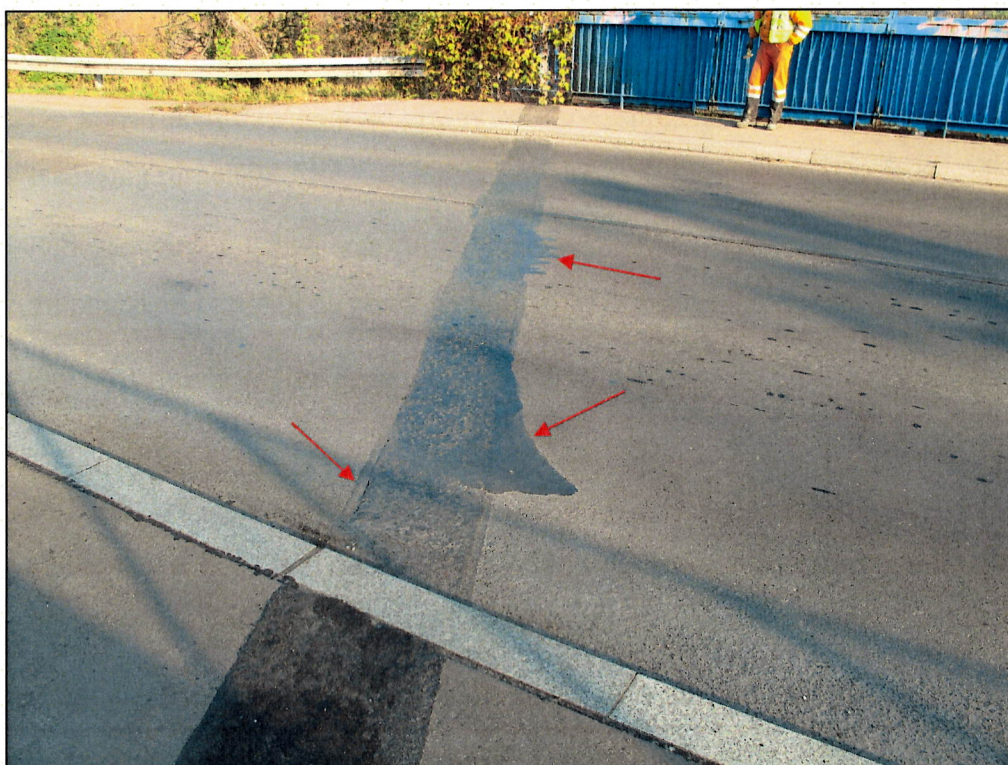
Rys. 5.17. Krawędziowe pęknięcie oraz lokalne wyciągnięcia masy bitumicznej z przekrycia dylatacyjnego na jezdni – widok od strony Centrum / Międzyzlesia
