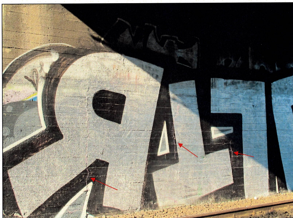
Rys. 5.11. Rysy z wapiennymi zaciekami oraz graffiti na podporze P1
