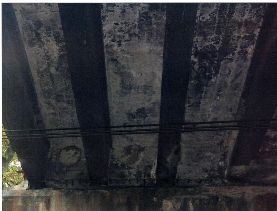
Rys. 5.2. Odbarwienia oraz wykwity wapienne na spodzie płyty pomocowej oraz poprzecznic podporowej – belki B1-B4 nad podporą P2
