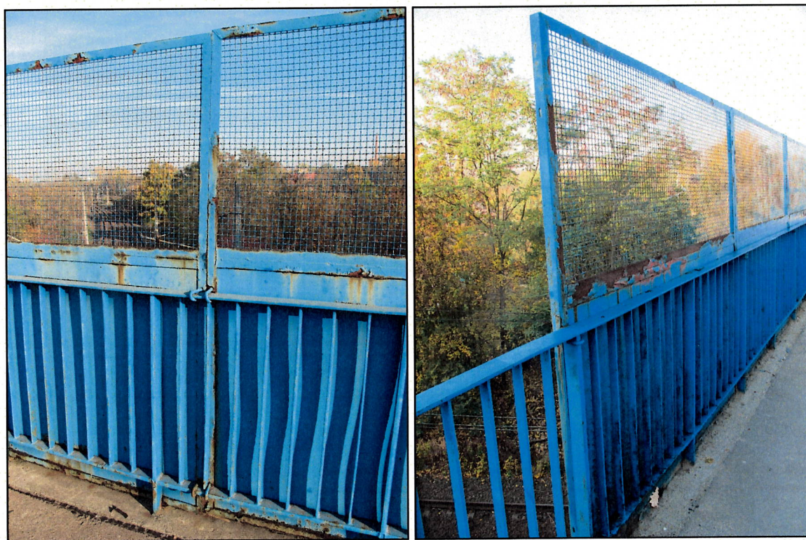
Rys. 5.15. Ubytki i łuszczenie się powłoki ochronnej oraz ogniska korozji powierzchniowej i wżerowej na ekranach przeciwporażeniowych
