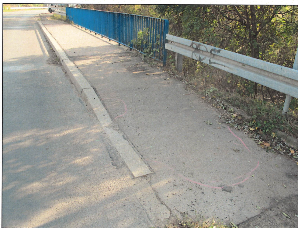
Rys. 5.20. Odspojenia nawierzchni bitumicznej wzdłuż zewnętrznych krawędzi chodnika (obrysowano kredą) – widok od strony Centrum
