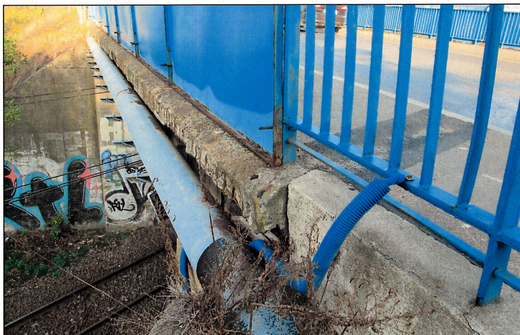
Rys. 5.20. Uziemienie obiektu – przyczółek od strony Brochowa
