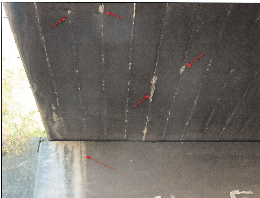
Rys. 5.3. Wykwity rdzawe i wapienne na spodzie belek. Zacieki na ścianie czołowej podpory P2
