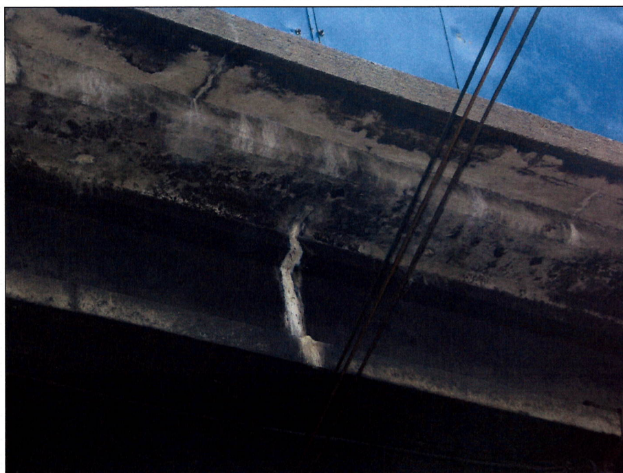
Rys. 5.4. Wykwity wapienne na spodzie wspornika podchodnikowego oraz zacieki na bocznej powierzchni belki prefabrykowanej – widok od strony zachodniej, okolice podpory P2
