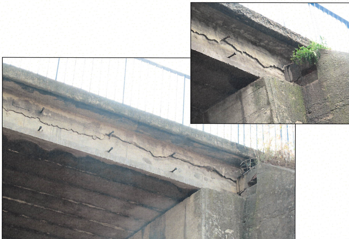
Rys. 5.4. Odspojenie nadbetonu i zawilgocenie spodu belki skrajnej, oraz ubytki betonu i korozja odsłoniętego zbrojenia belki gzymsowej – widok od strony Wrocławia (na górnym zdjęciu stan z roku 2007 – brak istotnych zmian)
