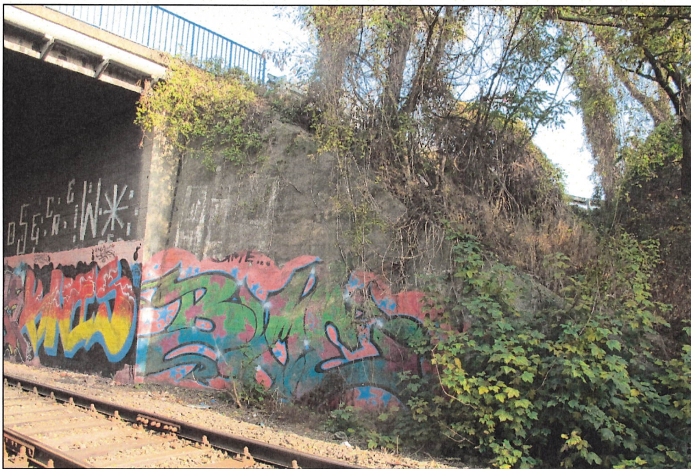
Rys. 5.7. Graffiti na skrzydle i ścianie czołowej podpory P2 od strony Kobierzyc oraz porastająca roślinność przy ścianie skrzydła
