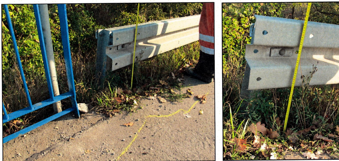
Rys. 5.21. Brak ciągłości między barierą a balustradą, prowadnica balustrady zamocowana zbyt nisko (górna krawędź 55 cm nad poboczem) – przyczółek Brochów / Wrocław Główny
