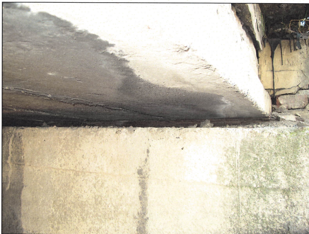
Rys. 5.9. Skorodowane zakończenie łożyska na podporze P1 od strony Wrocławia; zacieki wapienne na bocznej powierzchni belki i spodzie belki gzymsowej
