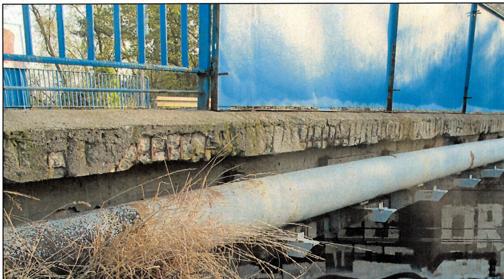
Rys. 5.19. Lokalne ogniska korozji na obudowie rurociągu i elementach wsporczych
