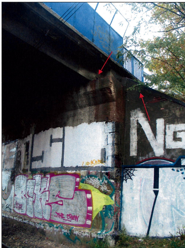
Rys. 5.10. Odsłonięcie muru ceglanego na skrzydle podpory P1 – widok od strony zachodniej. Zacieki wapienne i rdzawe oraz ubytki betonu na górnej części podpory
