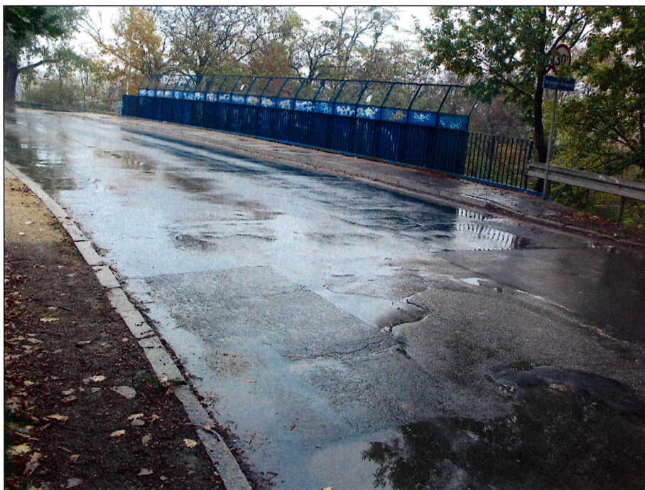
Rys. 5.13. Nierówności nawierzchni jezdni na dojeździe w postaci licznych łat – dojazd od strony Brochowa
