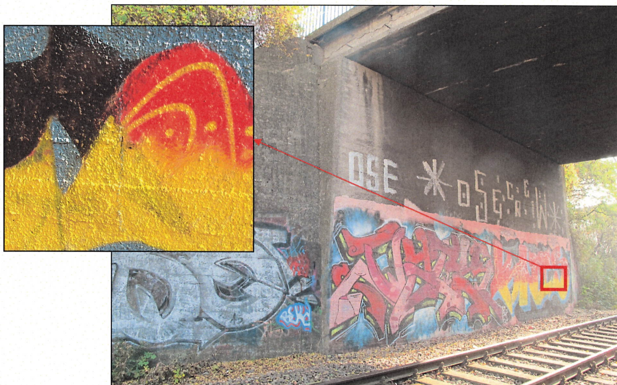
Rys. 5.8. Zacieki oraz lokalne zarysowania na ścianie czołowej przyczółka od strony Brochowa oraz graffiti na skrzydle i powierzchni czołowej podpory P2
