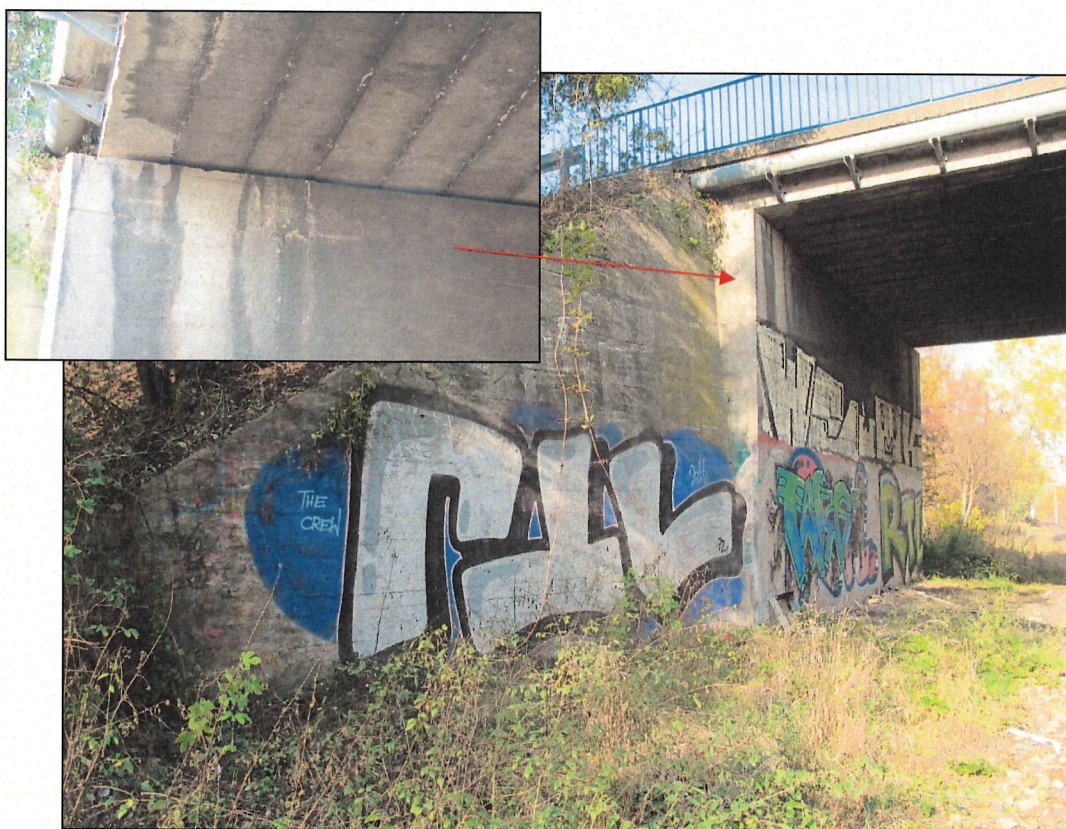
Rys. 5.6. Zacieki na ścianie czołowej przyczółka od strony Centrum oraz graffiti na skrzydłach i korpusie podpory P1
