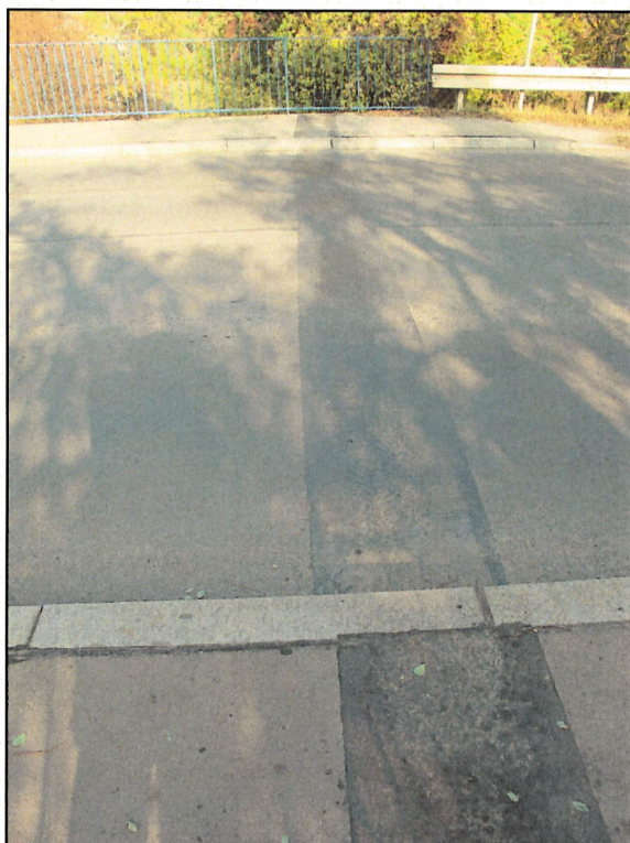
Rys. 5.10. Bitumiczne przekrycie dylatacyjne w poziomie nawierzchni jezdni bez uszkodzeń. Dylatacja chodnika od strony Brochowa z lokalnymi zaniżeniami masy bitumicznej
