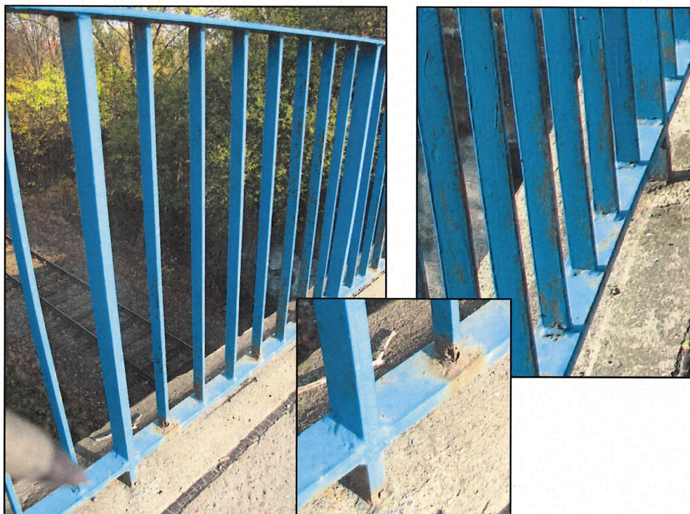
Rys. 5.13 Korozja na balustradach w postaci powierzchniowej korozji podpowłokowej oraz miejscowych ognisk korozji nawierzchni chodnika, rozległe odspojenia nawierzchni
