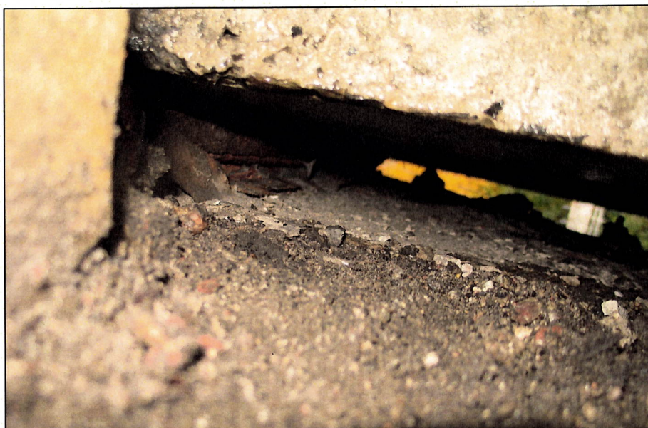
Rys. 5.12. Zaawansowana korozja łożyska oraz zanieczyszczenia ławy podłożyskowej podpory P2
