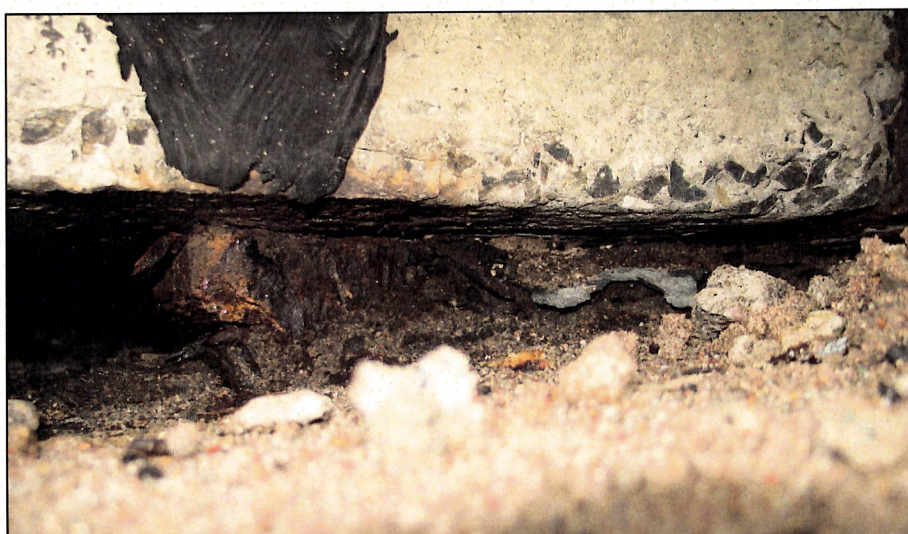
Rys. 5.13. Zaawansowana korozja łożyska oraz zanieczyszczenia ławy podłożyskowej podpory P1
