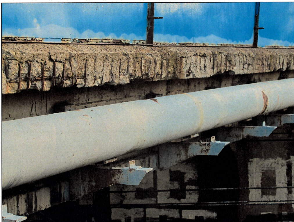
Rys. 5.3. Ubytki betonu oraz korozja odsłoniętego zbrojenia – belka gzymsowa od strony Międzyzlesia
