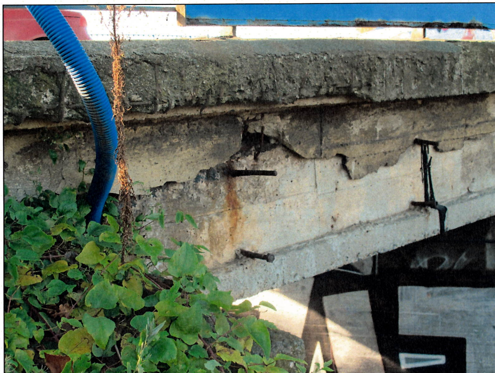
Rys. 5.5 Ubytki betonu oraz korozja odsłoniętego zbrojenia na belce gzymsowej od strony stacji Wrocław Główny / Brochów. Odspojenia fragmentów nadlanego betonu, rdzawe zacieki i wycieki bitumu na bocznej powierzchni skrajnej belki
