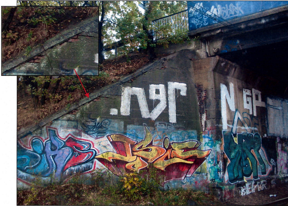
Rys. 5.9. Ubytki tynku, odsłonięcie muru ceglanego, spękania ściany skrzydła odwzorowujące układ cegieł. Liczne graffiti na podporze P2
