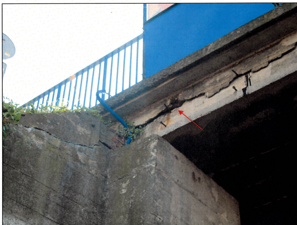
Rys. 5.4. Odspojenia fragmentów nadbetonu do których doszło jeszcze przed remontem wiaduktu w roku 2007, rdzawe zacieki i wycieki bitumu na bocznej powierzchni skrajnej belki od strony Wrocławia
