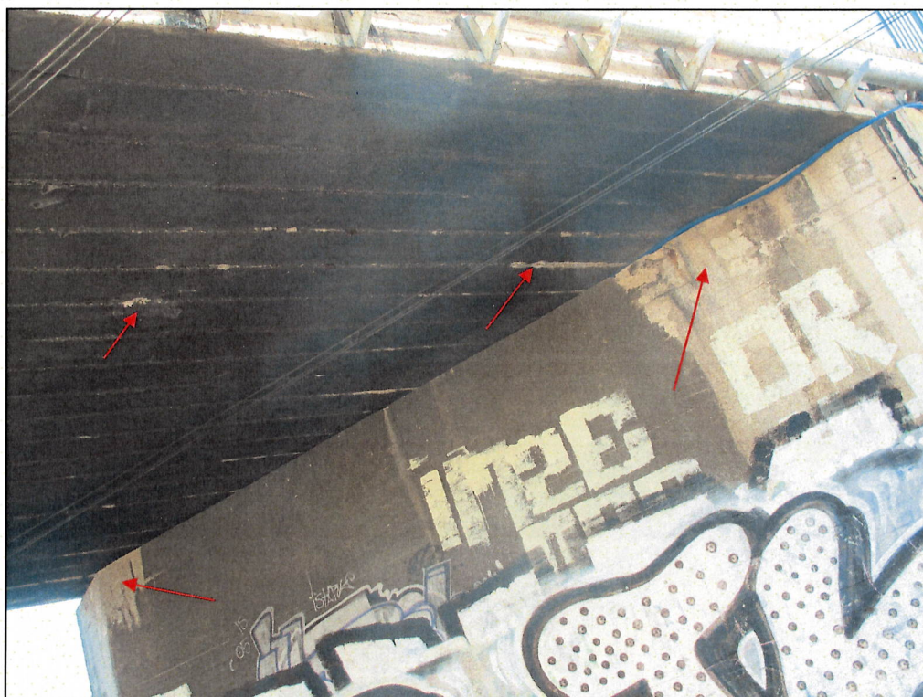
Rys. 5.2. Wykwity wapienne na spodniej stronie belek. Zacieki na ścianie czołowej przyczółka P2 w obrębie chodników
