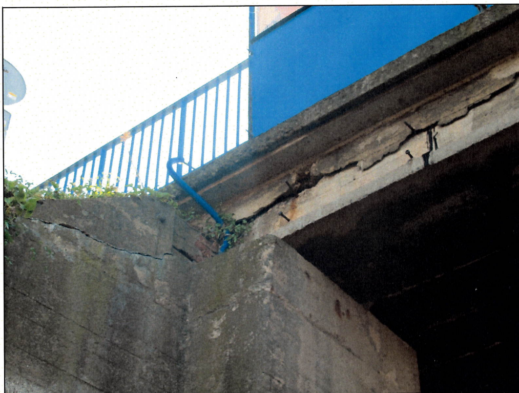
Rys. 5.8. Spękania, ubytki betonu oraz lokalne wykwity wapienne na skrzydle i ścianie czołowej przyczółka P2 od strony Wrocławia
