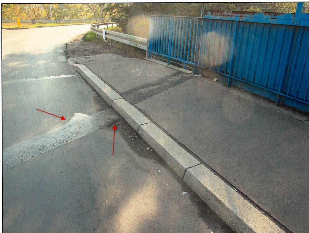
Rys. 5.18. Lokalne wyciągnięcia masy bitumicznej i deformacja przekrycia dylatacyjnego w jezdni wzdłuż krawężnika od strony Brochowa / Międzyzylesia. Miejscowe zaniżenia przekrycia dylatacyjnego w chodniku
