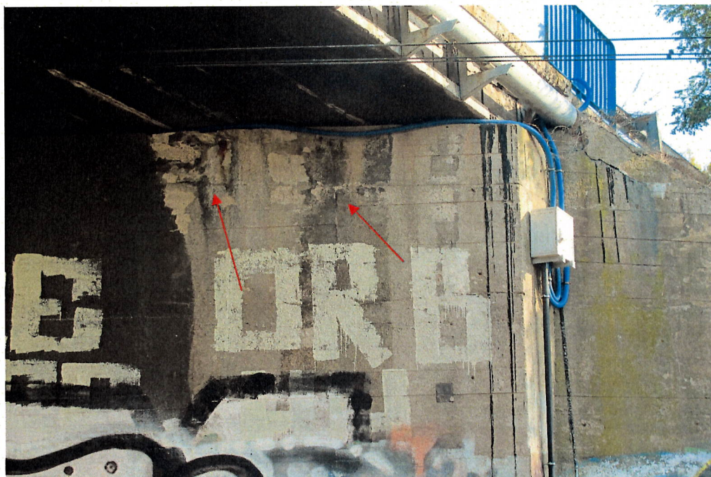
Rys. 5.6. Zarysowania pionowe i poziome z wykwitami wapiennymi na ścianie czołowej przyczółka P2
