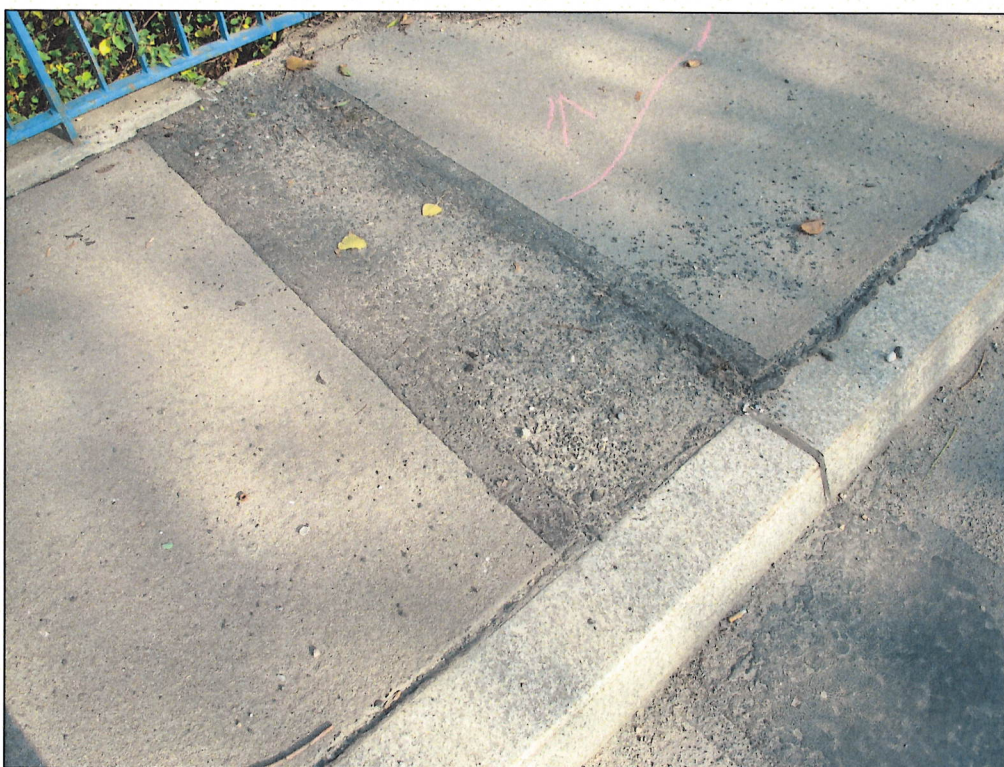
Rys. 5.11. Bitumiczne przekrycie dylatacyjne w poziomie nawierzchni chodnika z drobnymi spękaniami i lokalnymi deformacjami w postaci zapadnięć masy bitumicznej
