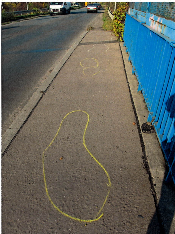
Rys. 5.16 Miejscowe odspojenia nawierzchni chodnika od strony Wrocław Główny (obrysowano żółtymi liniami)
