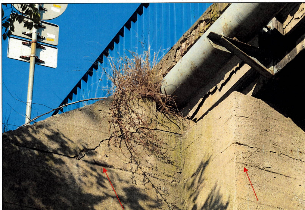
Rys. 5.7. Pęknięcie na skrzydle i na ścianie czołowej przyczółka P1 od strony Międzylesia
