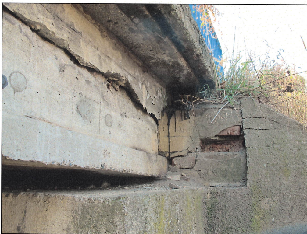
Rys. 5.5. Odspojone fragmenty nadlanego betonu oraz wykwyty wapienne na bocznej po wierzchni belki oraz spodzie wspornika – widok od strony Wrocławia
