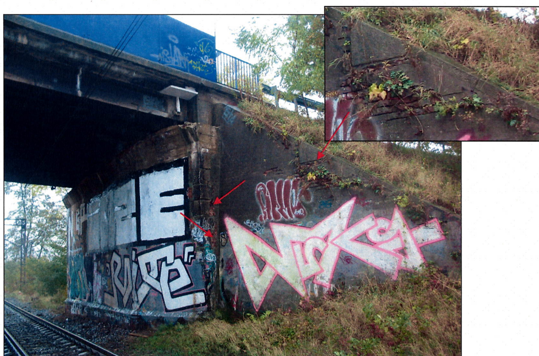
Rys. 5.8. Odsłonięty mur ceglany, wegetacja roślin oraz rysa na skrzydle podpory P2 od strony zachodniej. Ubytki tynku w okolicach okładziny z kamieni na narożu ściany przedniej.
