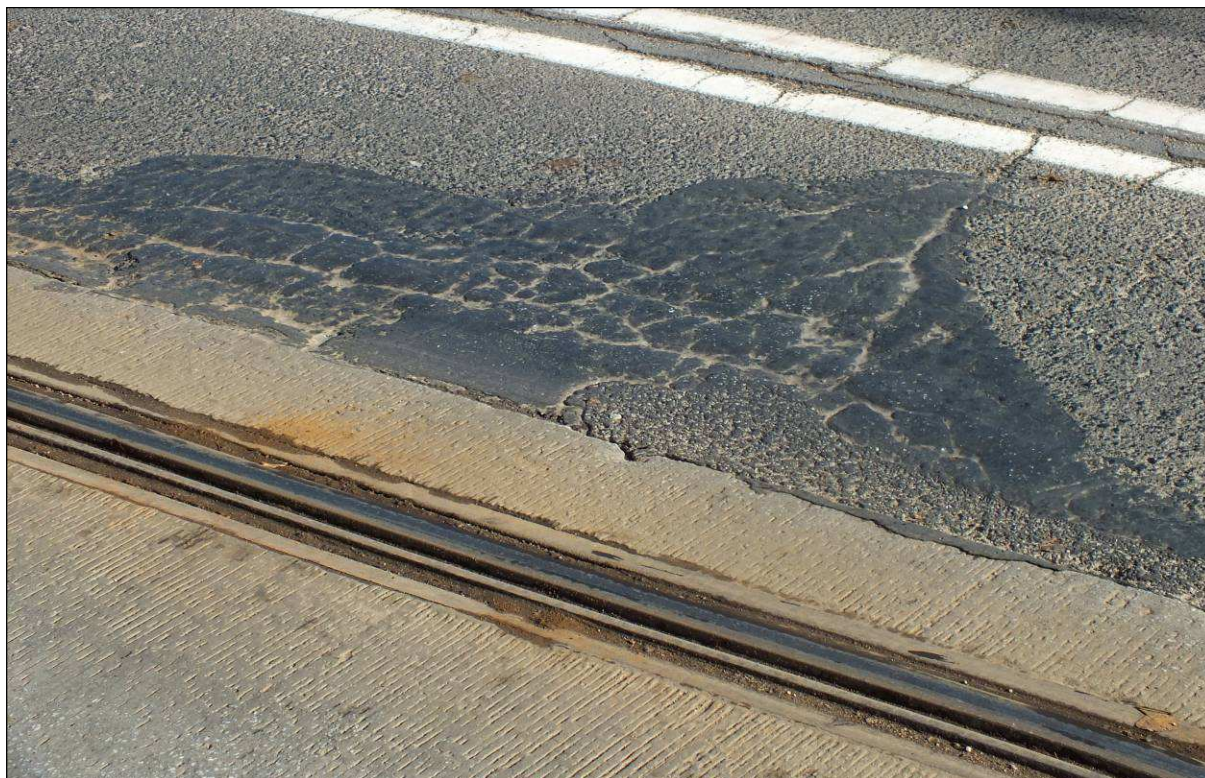
Rys. 5.111 Na zdjęciu powyżej widoczna siatka spękań na powierzchni łaty naprawczej bitumicznej nawierzchni jezdni pomiędzy torowiskami tramwajowymi na obiekcie
