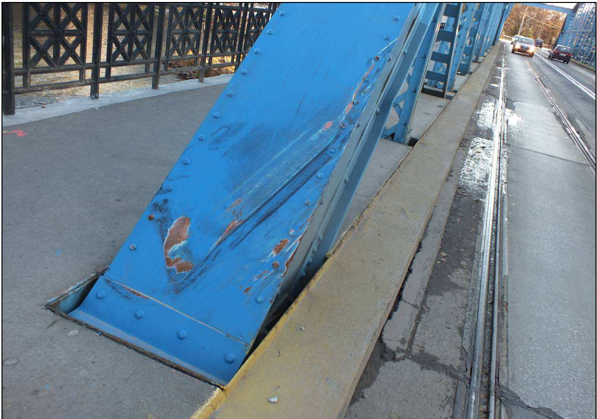
Rys. 5.16 Na zdjęciu powyżej widoczne uszkodzenie powłok ochronnych na powierzchni pasa górnego dźwigara kratownicowego od strony wody górnej, uszkodzenie od strony jezdni nastąpiło w wyniku uderzenia przejeżdżającego pojazdu
