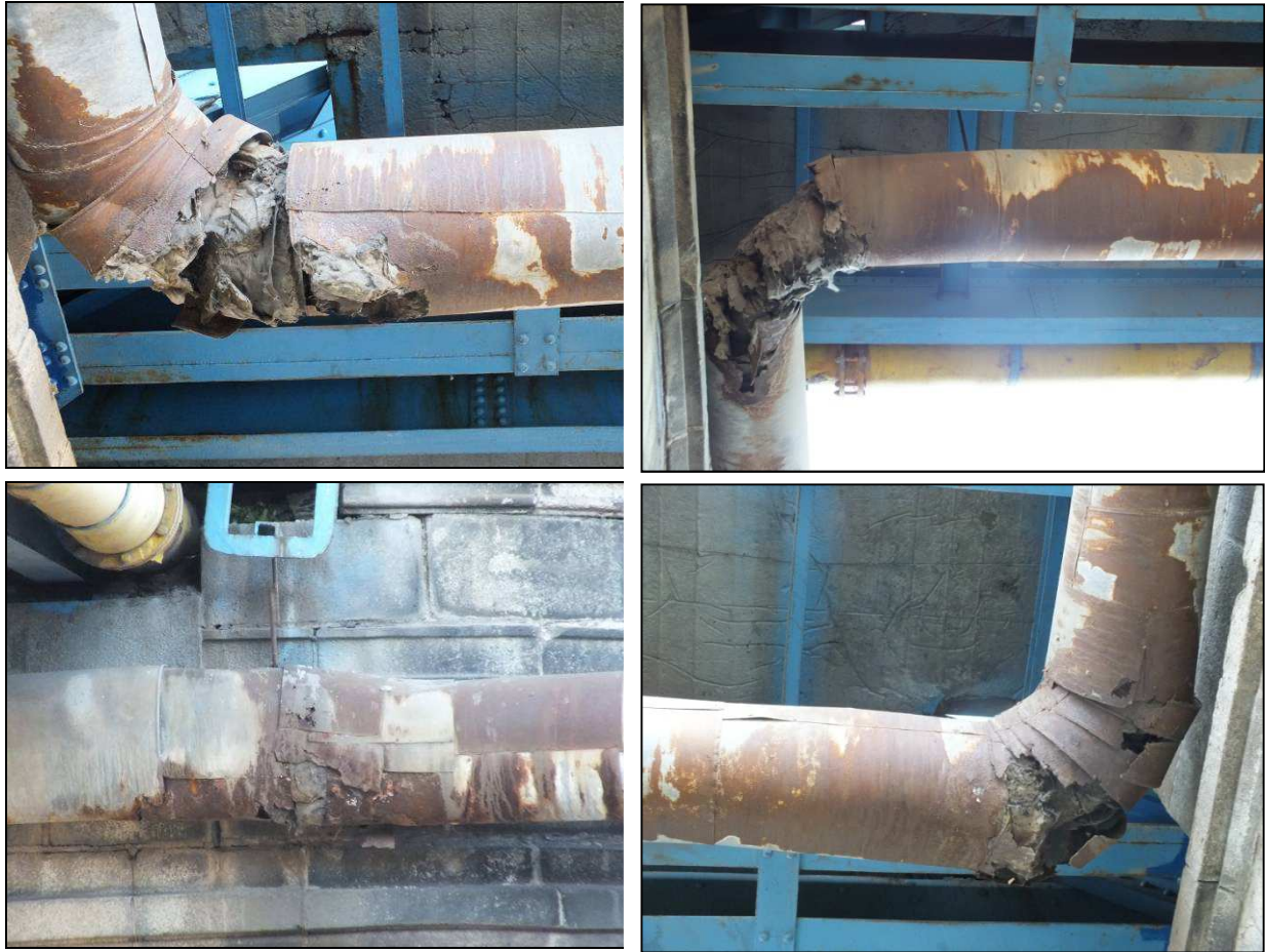
Rys. 5.183 Na zdjęciach powyżej widoczne liczne przykłady intensywnej korozji powierzchniowej i wżerowej wraz z towarzyszącymi rozległymi perforacjami stalowych blach osłonowych instalacji obcej podwieszanej pod obiektem od strony wody górnej
