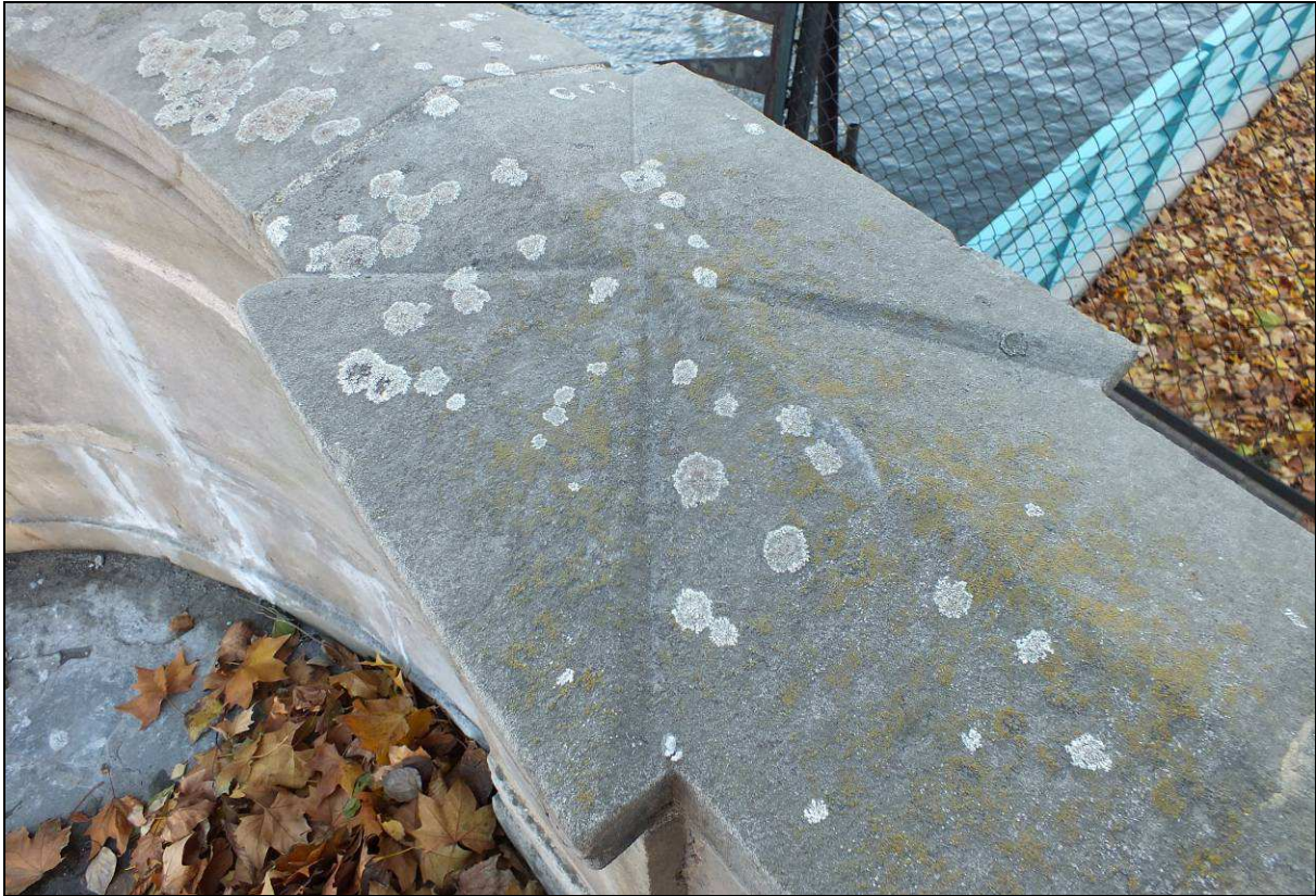
Rys. 5.142 Na zdjęciu powyżej widoczne rozległe zanieczyszczenia zielonymi nalotami organicznymi na górnej powierzchni kamiennych elementów zwieńczających balustradę w obrębie przyczółka od strony wody dolnej od strony ul. Mostowej
