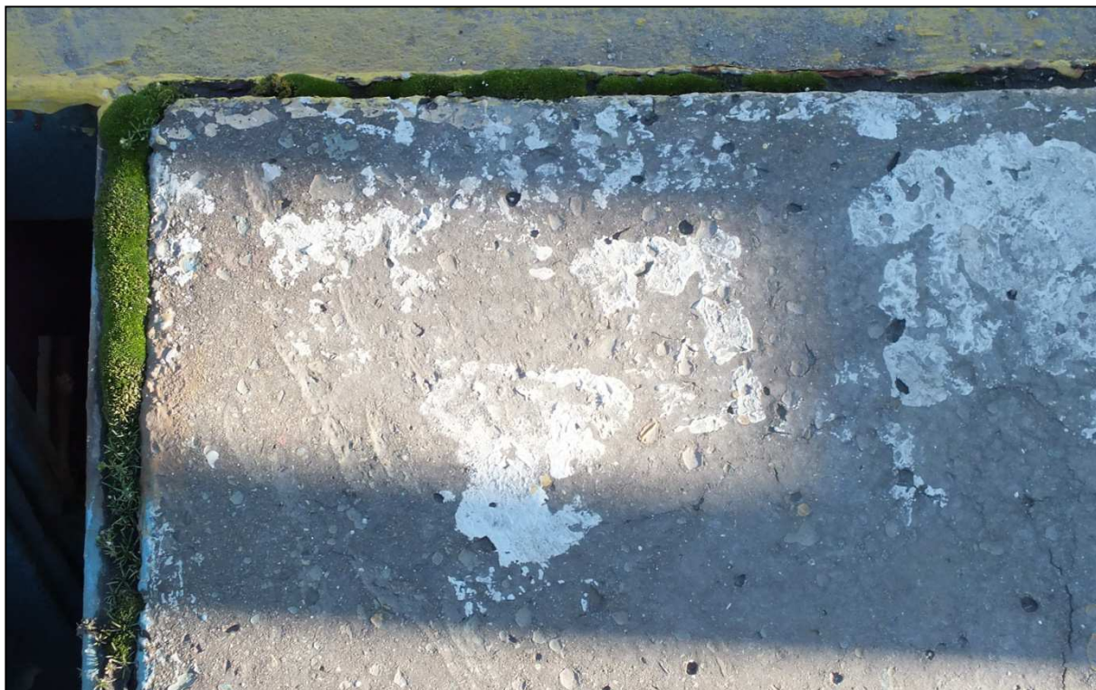
Rys. 5.115 Na zdjęciu powyżej widoczne zanieczyszczenia na powierzchni bitumicznej nawierzchni chodnika oraz wegetacja mchów w obrębie szczeliny pomiędzy nawierzchnią chodnika i stalowym okuciem otworu na przeprowadzenia elementów dźwigarów kratownicowych
