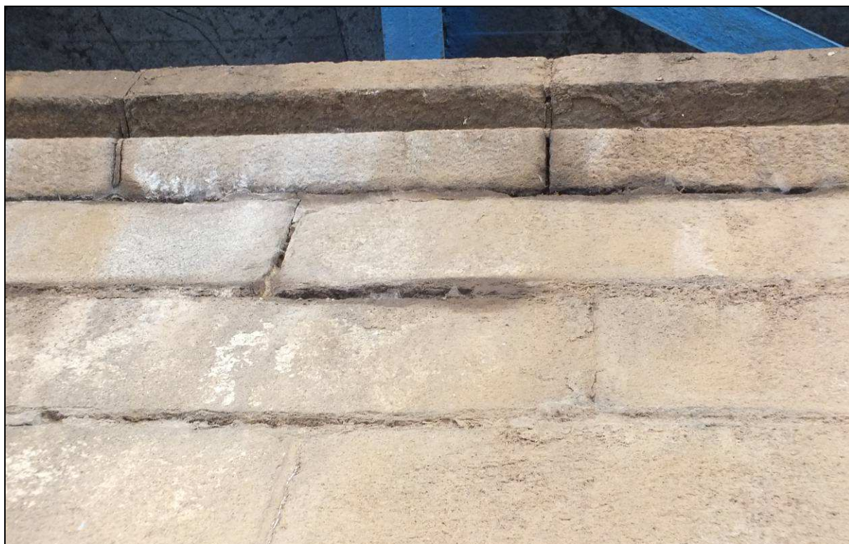
Rys. 5.88 Na zdjęciu powyżej widoczne zanieczyszczenia materiałem ziemnym na powierzchni oraz ubytki materiału i zawilgocenia w obrębie spoinowania kamiennych elementów niszy podłożyskowej filara
