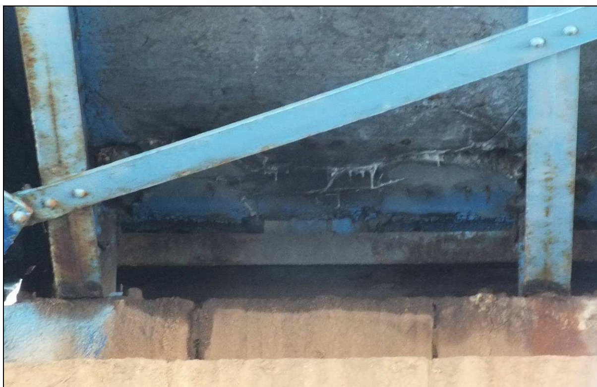
Rys. 5.46 Na zdjęciu powyżej widoczne zarysowania, wapienne wylugowania, wykruszenia betonu oraz korozyjne wykwity świadczące o postępującej korozji zbrojenia na spodzie płyty pomostowej w obrębie przerwy dylatacyjnej, widoczna również intensywna korozja powierzchniowa na elementach stalowego rusztu
