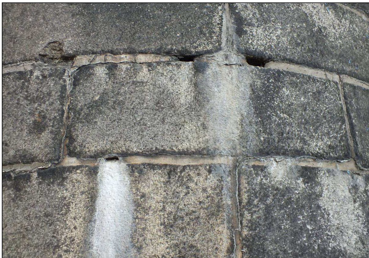
Rys. 5.87 Na zdjęciu powyżej widoczne powierzchniowe zanieczyszczenia, ubytki materiału i wapienne wylugowania w obrębie spoinowania oraz wykruszenia materiału na powierzchni kamiennej okładziny filara
