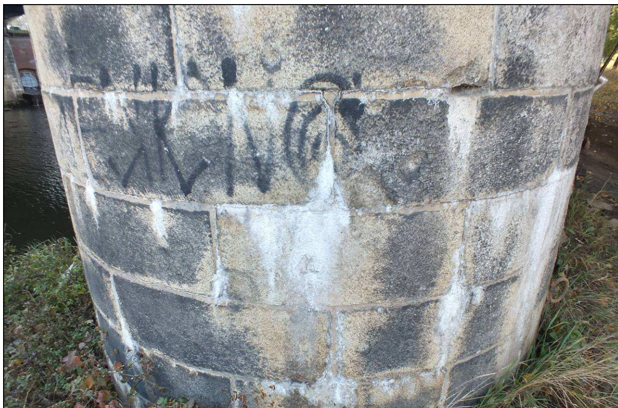
Rys. 5.81 Na zdjęciu powyżej widoczne zanieczyszczenia w postaci graffiti oraz liczne wyługowania w obrębie spoinowania kamiennej okładziny filara
