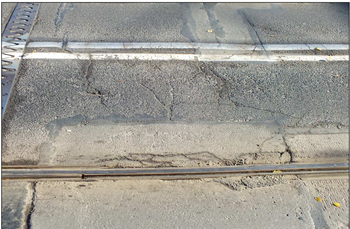
Rys. 5.101 Na zdjęciu powyżej widoczne spękania i powierzchniowe wykruszenia betonowej płyty torowiska tramwajowego w obrębie szyny jezdnej
