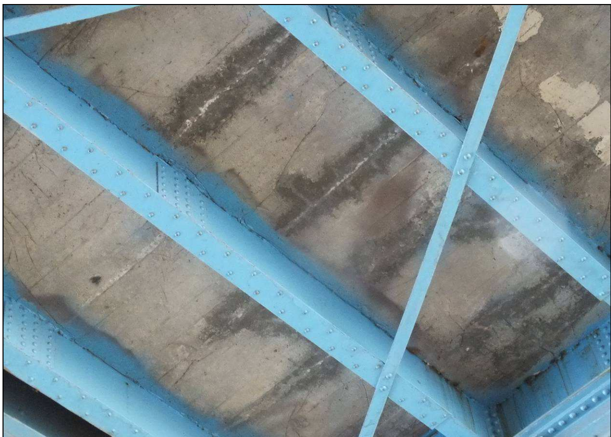
Rys. 5.38 Na zdjęciu powyżej widoczne liczne zawilgocenia oraz towarzyszące wykwyty i wylugowania wapienne w obrębie poprzecznych zarysowań żelbetowej płyty pomostowej pod jezdnią
