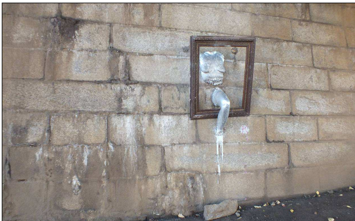
Rys. 5.84 Na zdjęciu powyżej widoczne zanieczyszczenia, liczne zacieki i wyługowania w obrębie spoinowania oraz wykruszenia i ubytki na powierzchni kamiennej okładziny filara
