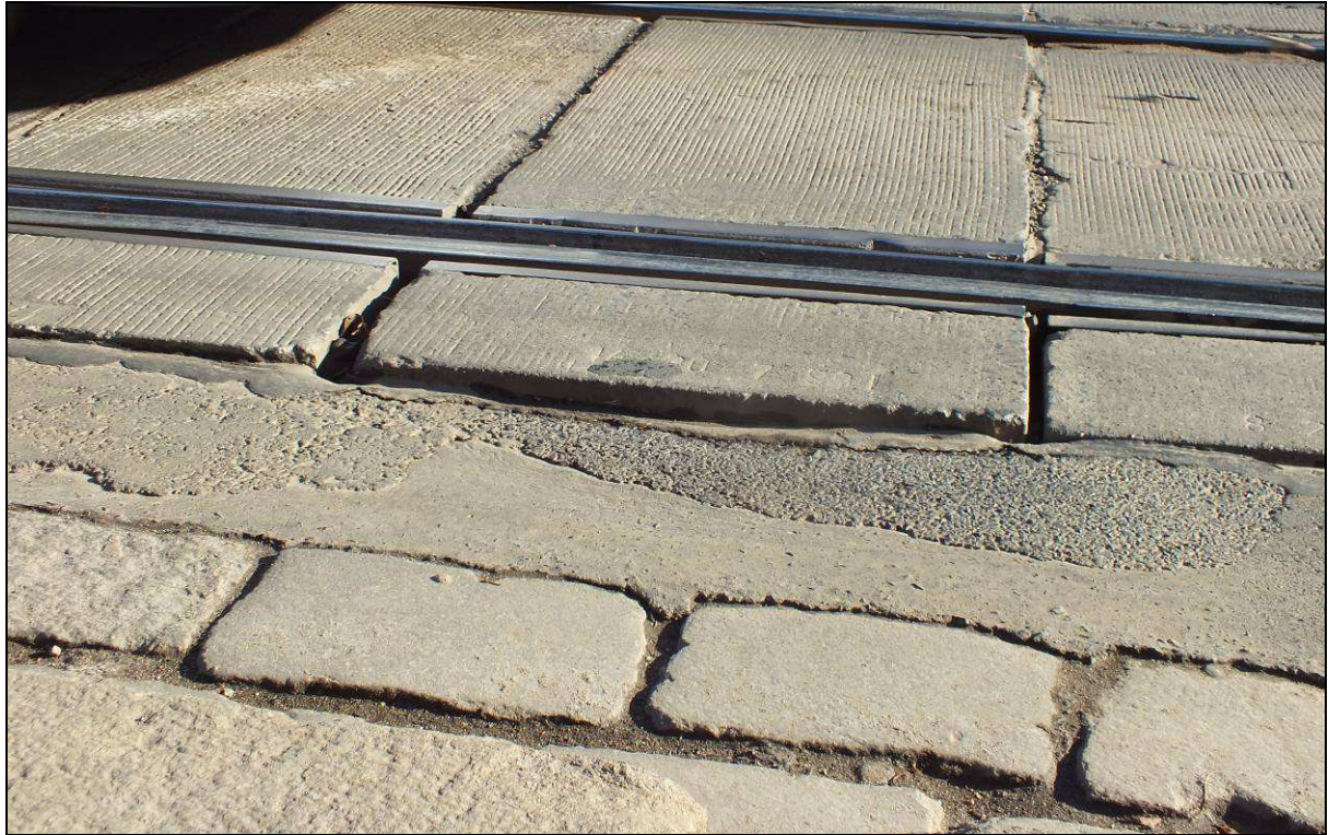
Rys. 5.4 Na zdjęciu powyżej widoczny ubytek bitumicznej nawierzchni jezdni w obrębie płyt torowiska tramwajowego na dojeździe do obiektu
