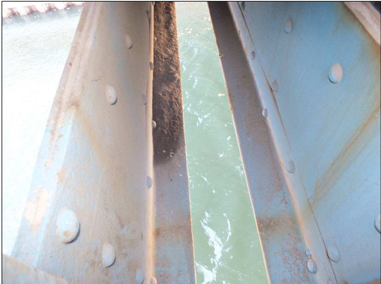
Rys. 5.27 Na zdjęciu powyżej widoczne rozległe zanieczyszczenia materiałem ziemnych pasów dolnych dźwigarów kratownicowych
