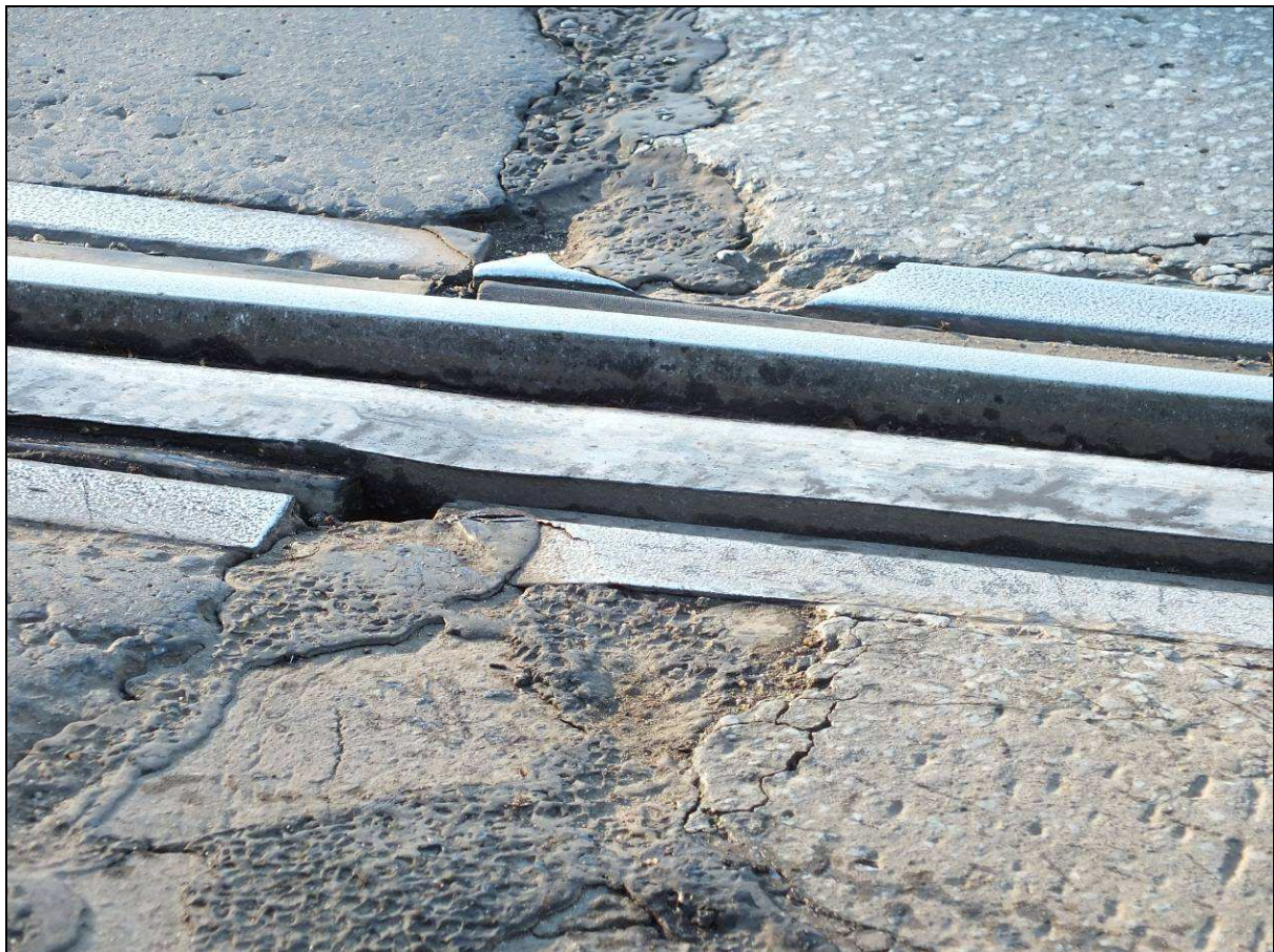
Rys. 5.9 Na zdjęciu powyżej widoczna miejscowa deformacja szyny torowiska tramwajowego na dojeździe do obiektu od strony ul. Mostowej
