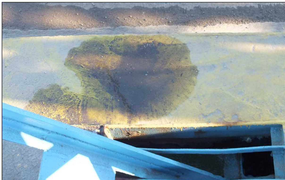
Rys. 5.124 Na zdjęciu powyżej widoczne zastoisko wód opadowych na górnej powierzchni krawężnika na obiekcie
