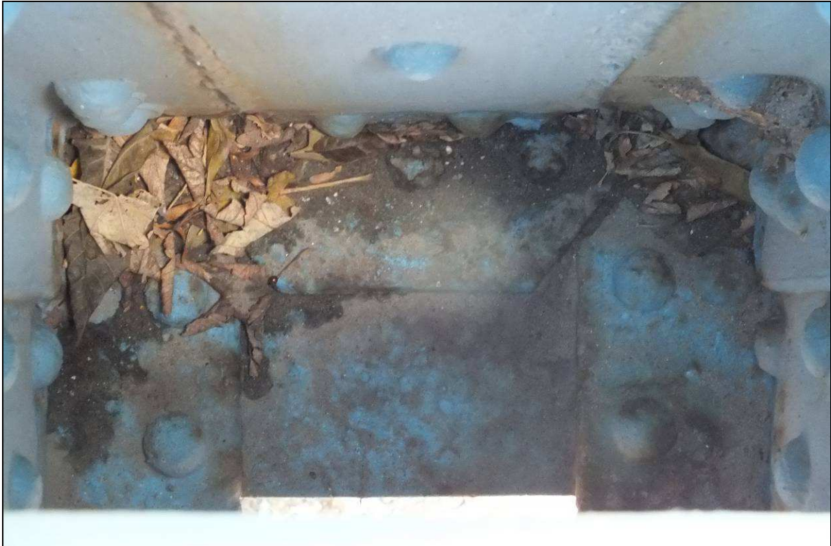
Rys. 5.13 Na zdjęciu powyżej widoczne rozległe zanieczyszczenia materiałem ziemnym i organicznym w węźle dźwigara kratownicowego w miejscu przejścia przez płytę wspornika pochodnikowego, zanieczyszczenia przyczyniają się do uszkodzenia powłok antykorozyjnych i korozji stali. Zanieczyszczenia charakterystyczne dla wszystkich węzłów konstrukcji nośnej na wysokości pomostu
