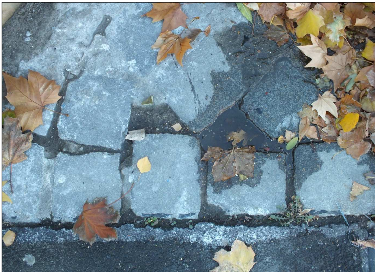
Rys. 5.120 Na zdjęciu powyżej widoczne ubytki w spoinowaniu, zanieczyszczenia materiałem ziemnym oraz towarzysząca wegetacja roślinności i zastoiska wód opadowych pomiędzy kamiennymi elementami brukowanej nawierzchni galerii widokowej nad podporą
