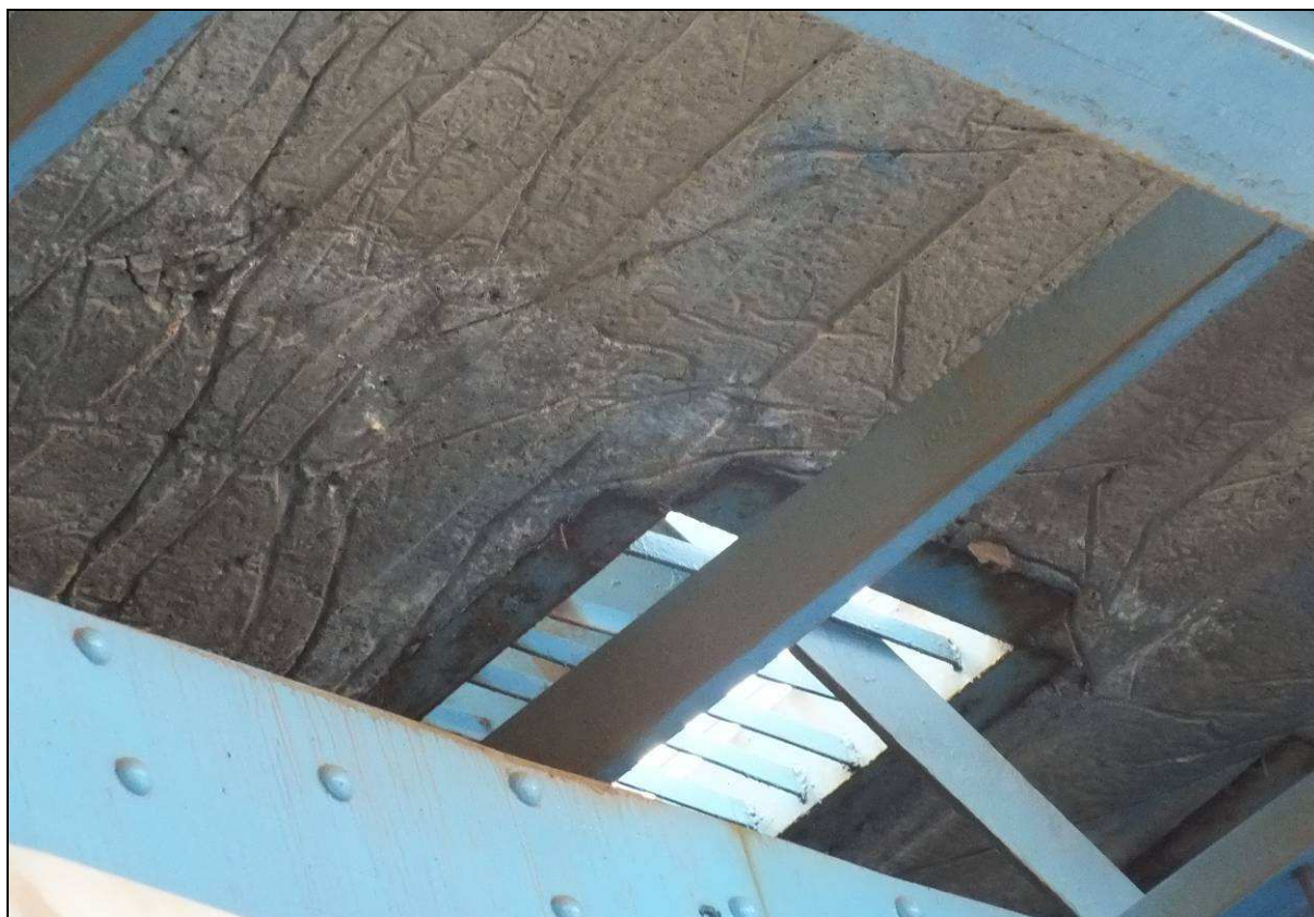
Rys. 5.55 Na zdjęciu powyżej widoczne miejscowe wyługowania wapienne, widoczna również nierówna powierzchnia betonu na spodzie płyty chodnikowej, prawdopodobną przyczyną są błędy wykonawcze na etapie budowy
