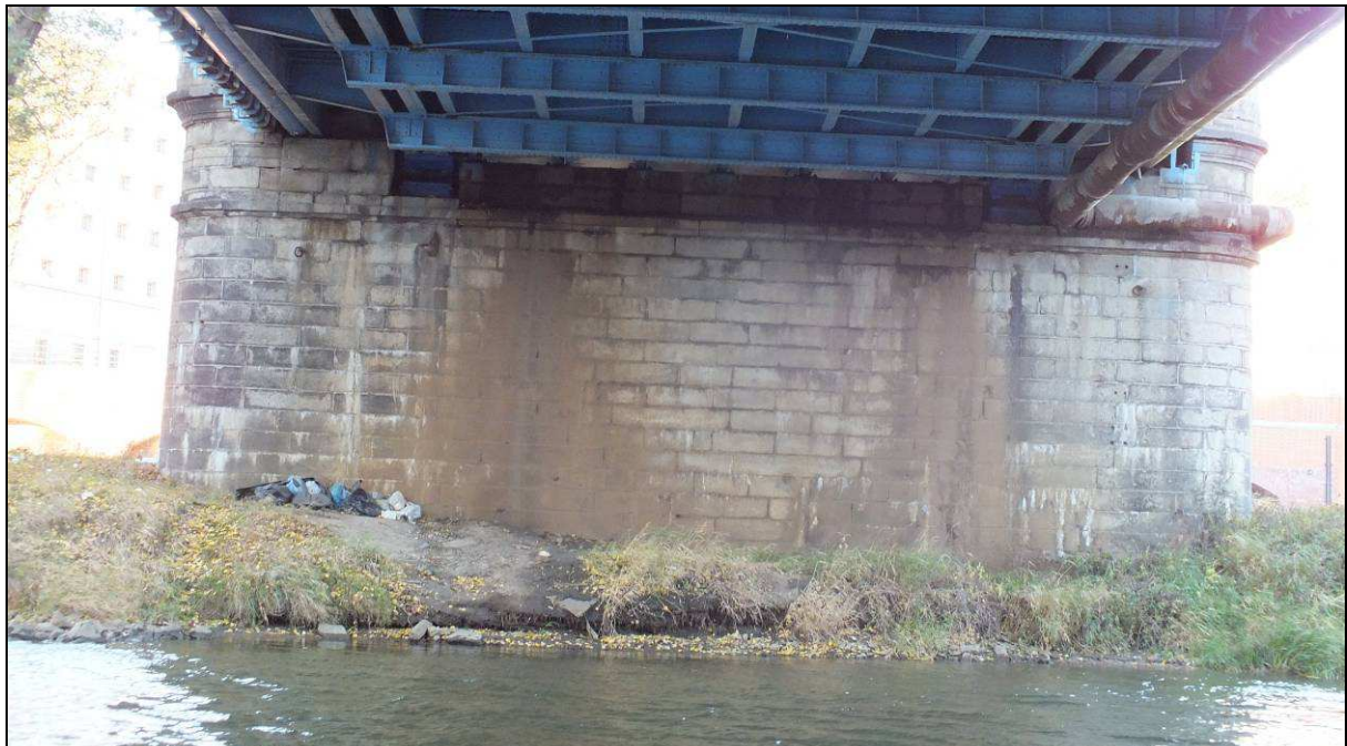
Rys. 5.80 Na zdjęciu powyżej widoczne rozległe zanieczyszczenia na powierzchni filara w postaci zacieków
