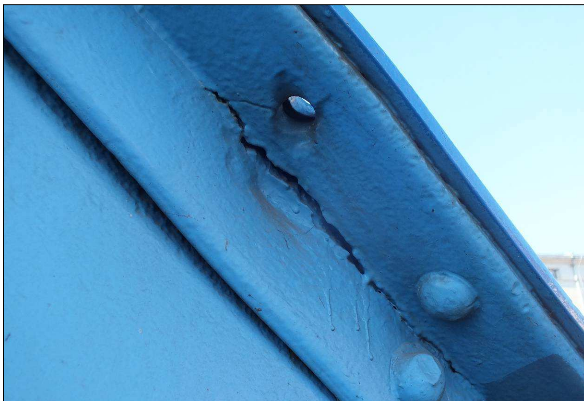
Rys. 5.22 Na zdjęciu powyżej widoczny ubytek łącznika oraz lokalne rozerwanie kątownika pasa górnego dźwigara kratownicowego
