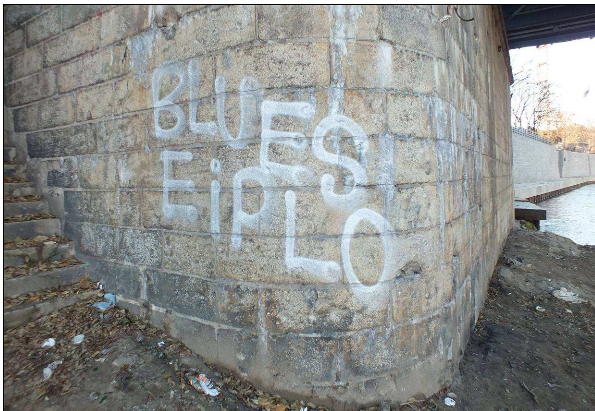
Rys. 5.59 Na zdjęciu powyżej widoczne zanieczyszczenia w postaci graffiti na powierzchni kamiennej okładziny ściany bocznej od strony wody górnej przyczółka od strony ul. Podwale
