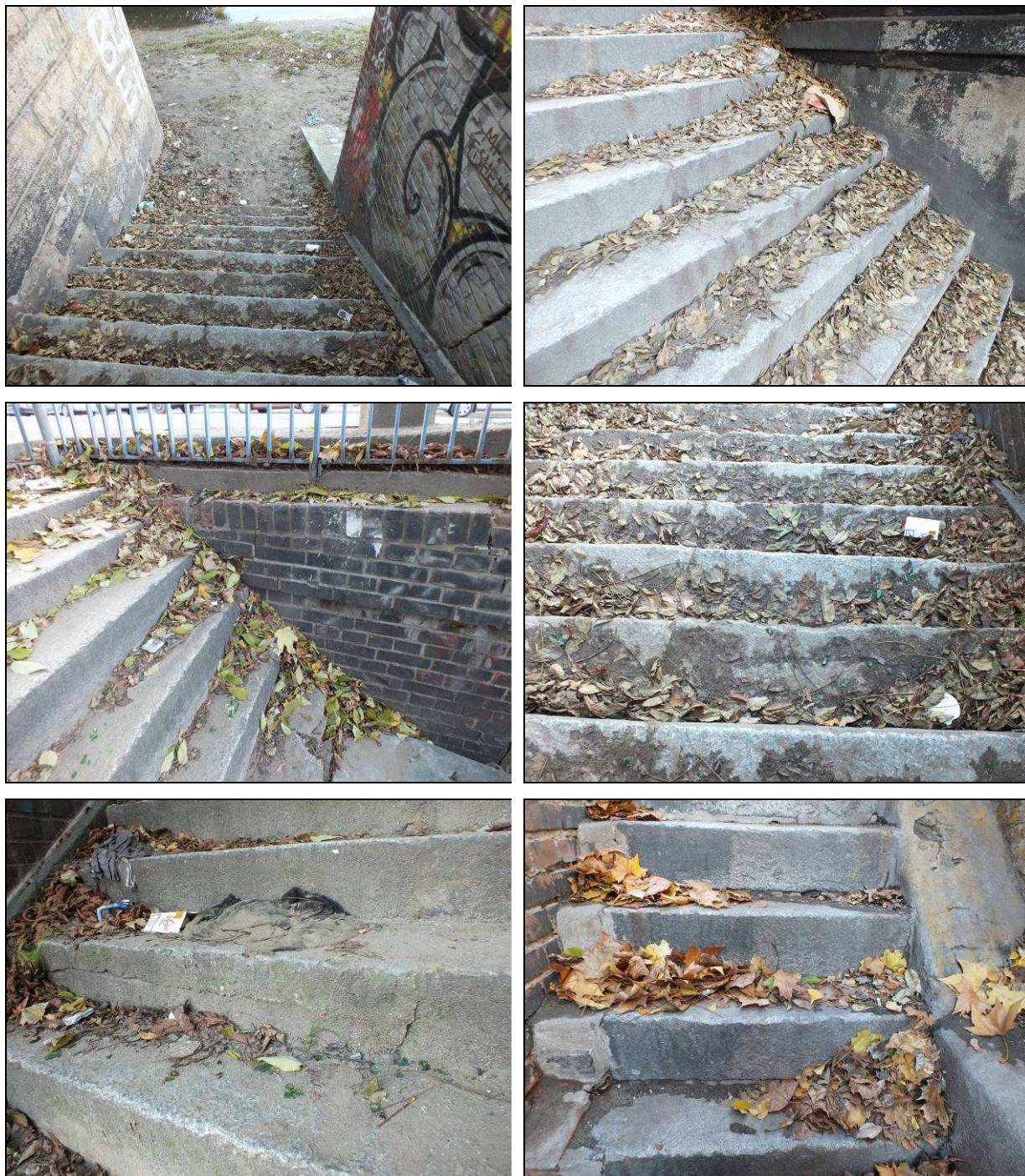
Rys. 5.167 Na zdjęciach powyżej widoczne liczne przykłady rozległe zanieczyszczeń materiałem ziemnym, biologicznym i odpadami komunalnymi schodów skarpowych obiektu
