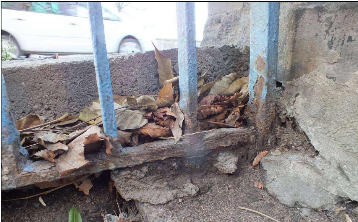
Rys. 5.140 Na zdjęciu powyżej widoczna intensywna korozja powierzchniowa i wżerowa wraz z towarzyszącymi ubytkami przekroju i rozwarstwieniami materiału stalowej balustrady w obrębie schodów skarpowych od strony wody górnej od strony ul. Podwale
