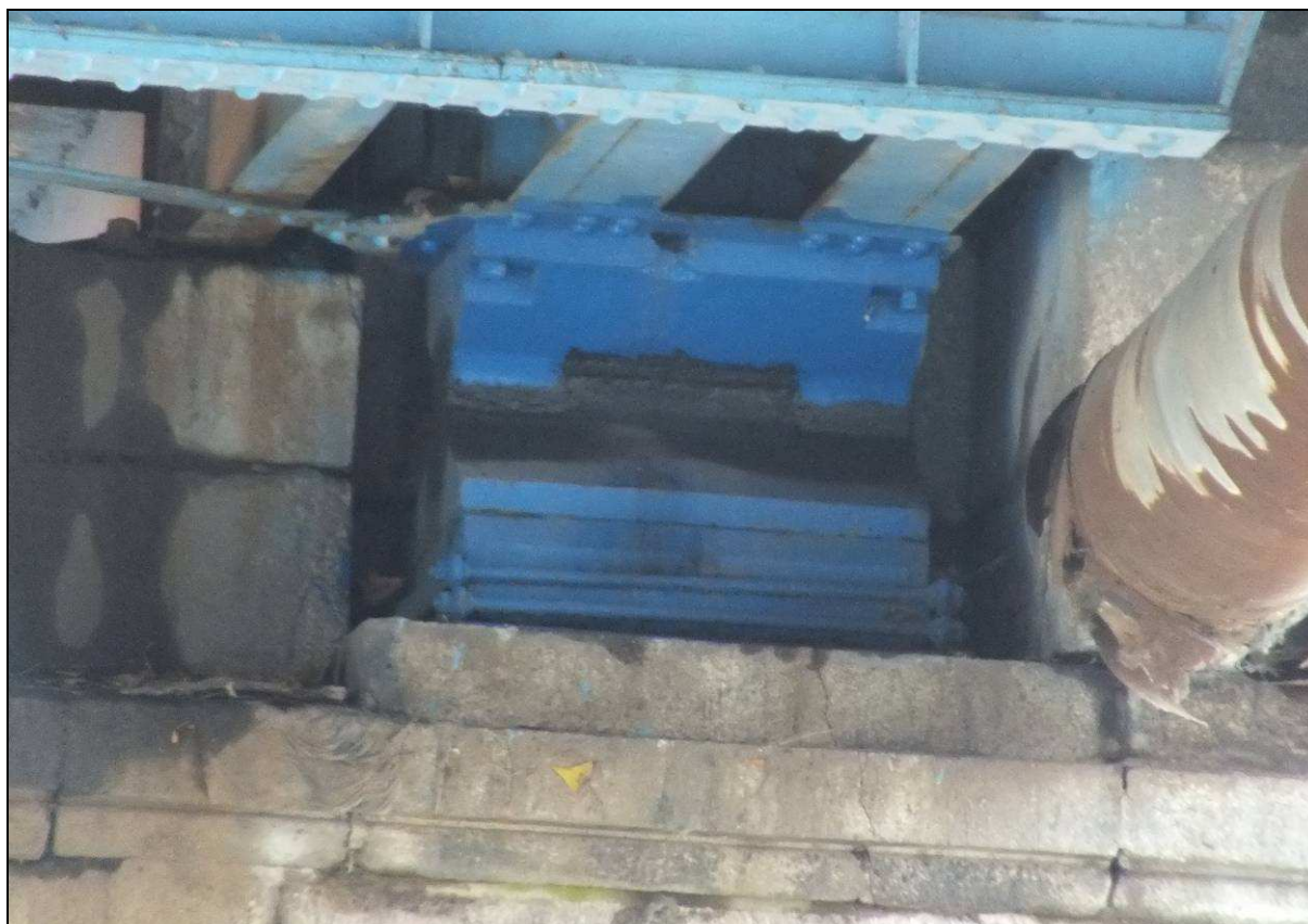
Rys. 5.92 Na zdjęciu powyżej widoczne ubytki spoinowania oraz rozległe zawilgocenia w obrębie niszy podłożyskowej, widoczne również pionowe pęknięcia ciosu podłożyskowego od strony ul. Podwale od strony wody górnej
