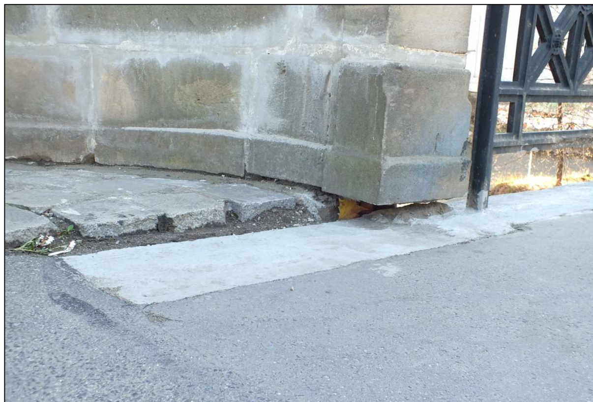
Rys. 5.151 Na zdjęciu powyżej widoczna przerwa pomiędzy kamienną balustradą na przyczółku i betonowym gzymsem na obiekcie
