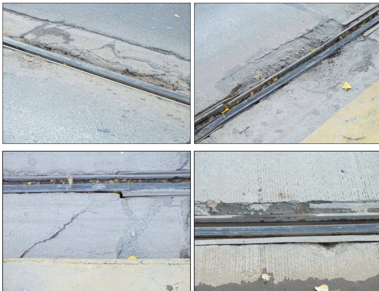
Rys. 5.103 Na zdjęciach powyżej widoczne liczne przykłady spękań, wykruszeń i ubytków materiału na powierzchni betonowych płyt torowiska tramwajowego głównie w obrębie szyn jezdnych
