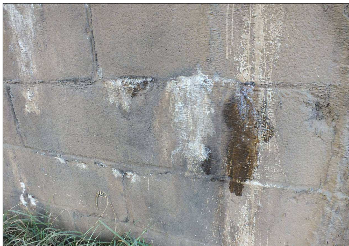
Rys. 5.82 Na zdjęciu powyżej widoczne liczne wyługowania oraz zawilgocenia i zacieki w obrębie spoinowania kamiennej okładziny filara
