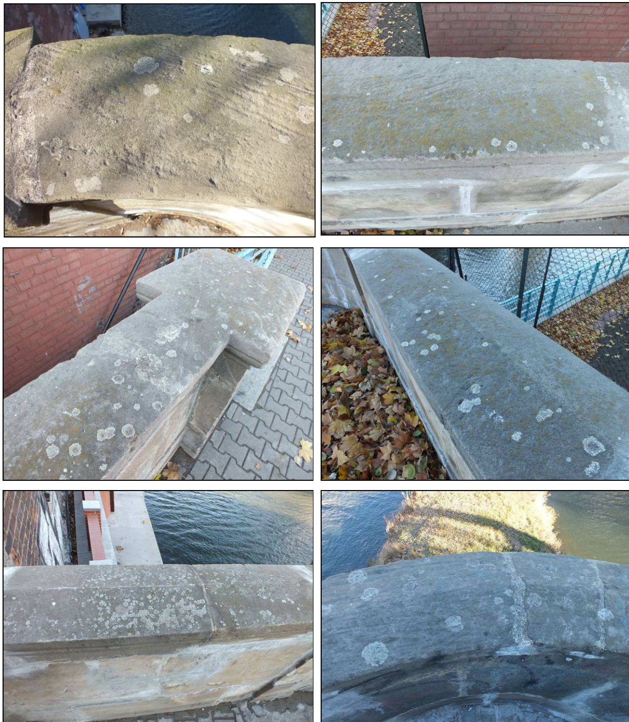
Rys. 5.144 Na zdjęciach powyżej widoczne liczne przykłady powierzchniowych wykruszeń materiału oraz rozległych zanieczyszczeń zielonymi nalotami organicznymi na górnej powierzchni kamiennych elementów zwieńczających balustrady w obrębie przyczółków
