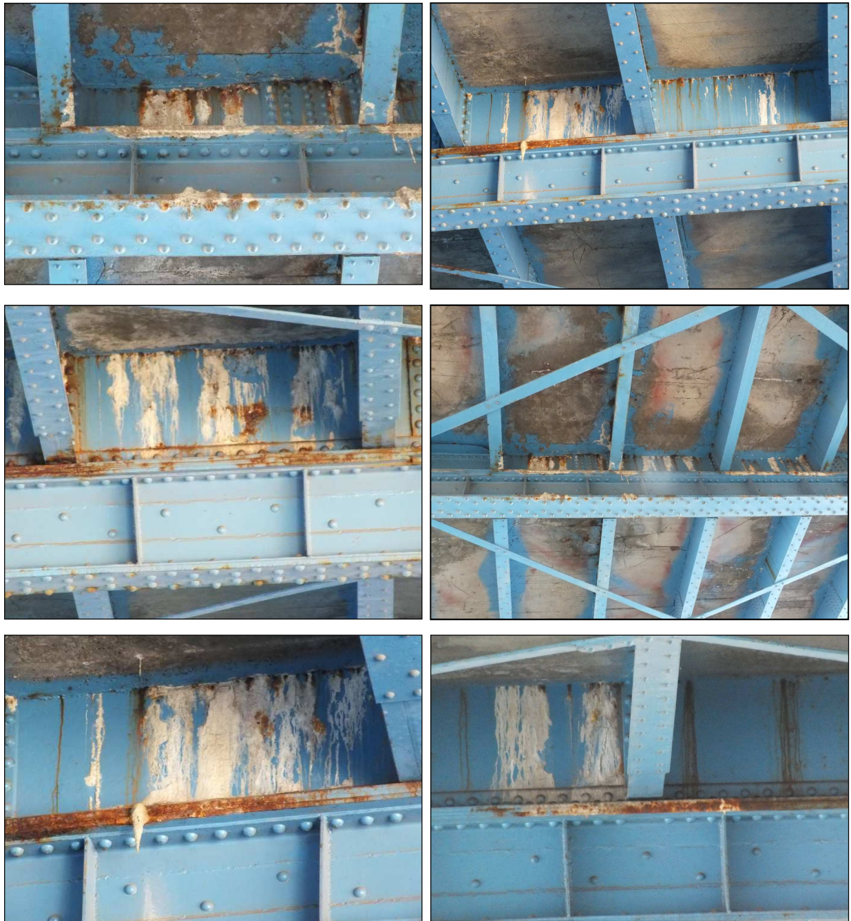
Rys. 5.34 Na zdjęciach powyżej widoczne liczne przykłady rozległych wapiennych zacieków oraz intensywnej korozji na powierzchni stalowych poprzecznic i podłużnic, zacieki świadczą o nieszczelnej izolacji
