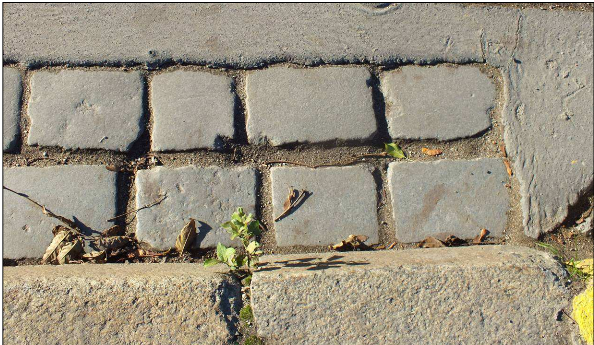
Rys. 5.1 Na zdjęciu powyżej widoczne ubytki w spoinowaniu dwu rzędowego ścieku z kostki granitowej wzdłuż krawędzi jezdni na dojazdach do obiektu
