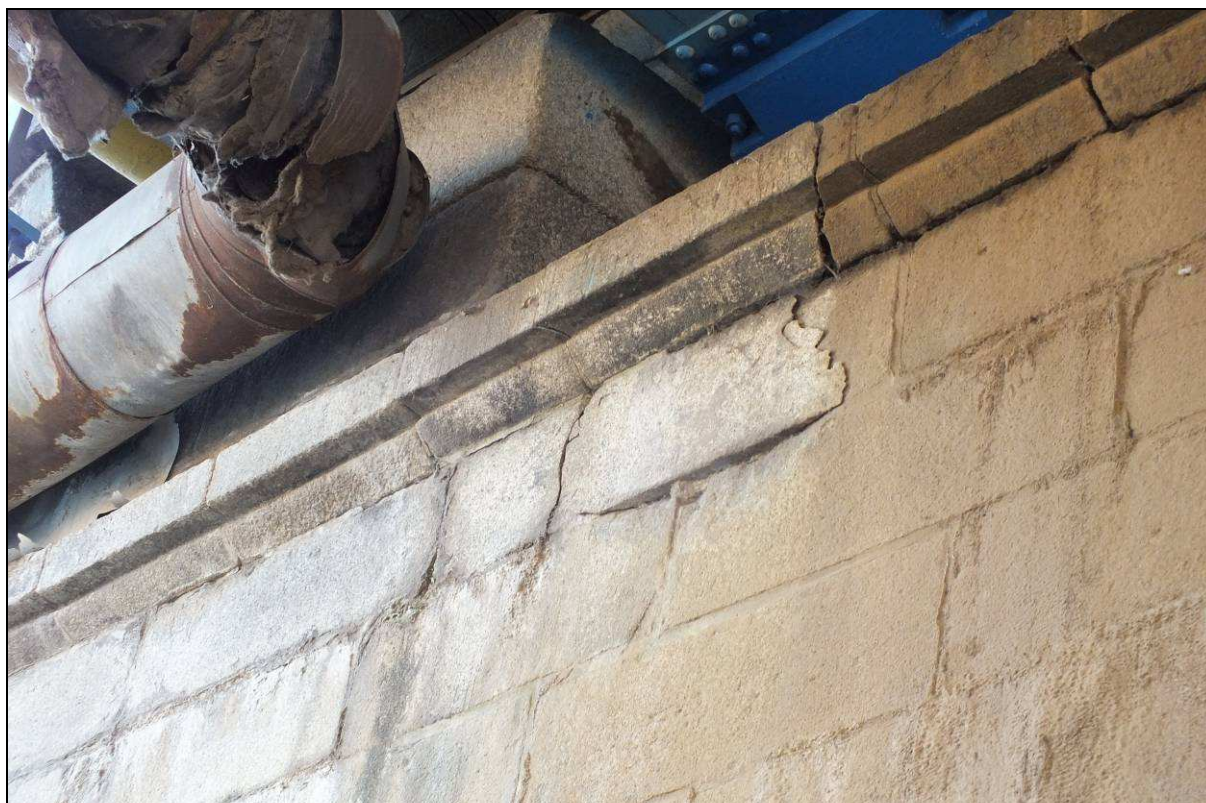
Rys. 5.89 Na zdjęciu powyżej widoczne rozległe zanieczyszczenia na powierzchni, ubytki spoinowania oraz miejscowe spękania, wykruszenia i ubytki na powierzchni kamiennej okładziny filara w obrębie ciosu podłożyskowego
