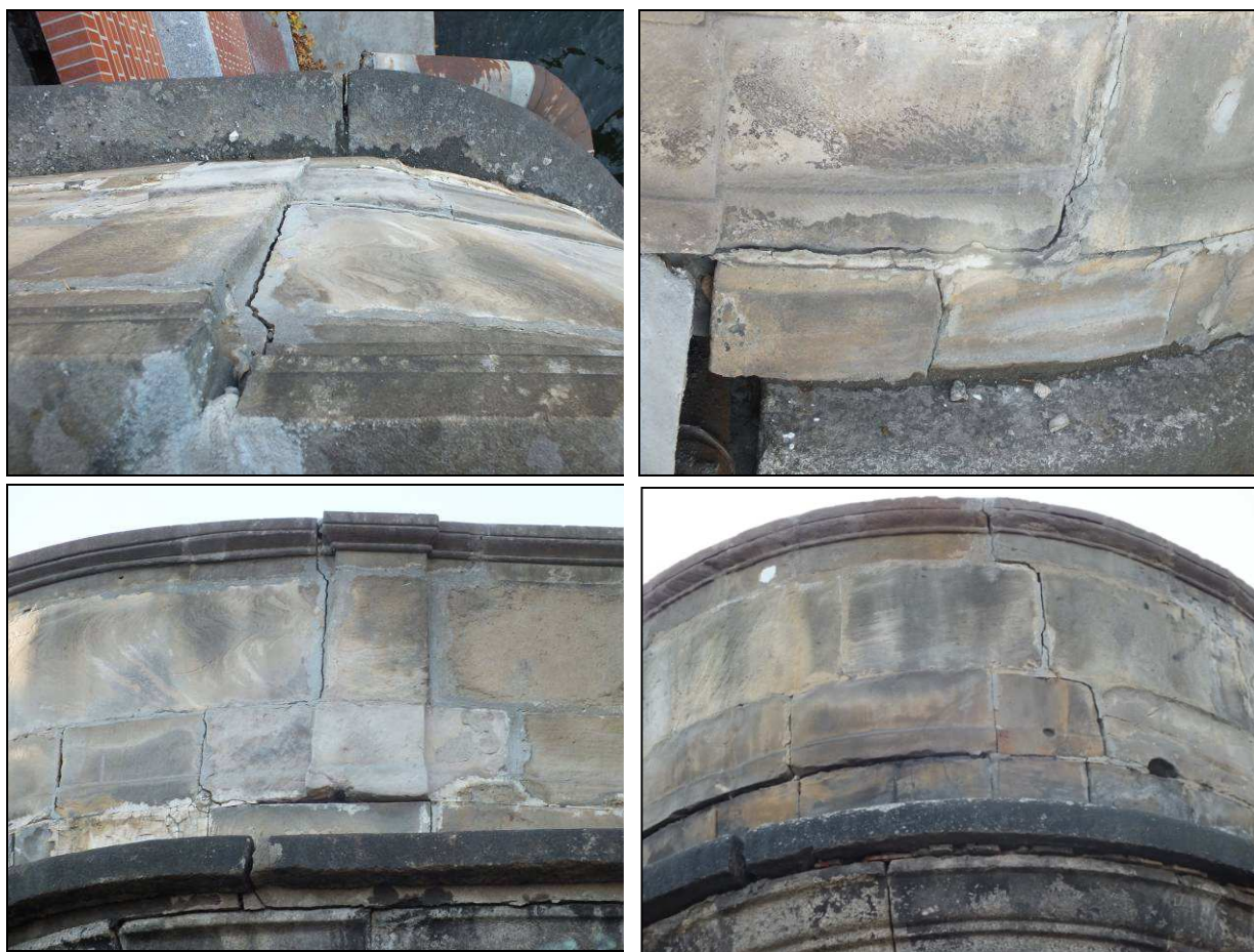
Rys. 5.149 Na zdjęciach powyżej widoczne liczne przykłady spękań wzdłuż spoinowania oraz przemieszczeń elementów kamiennych balustrad w obrębie przyczółków i galerii widokowych nad podporą pośrednią
