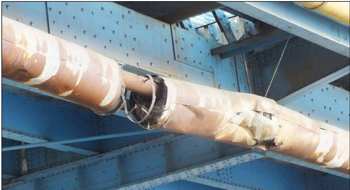
Rys. 5.184 Na zdjęciu powyżej widoczna rozległa korozja powierzchniowa oraz miejscowe ubytki stalowych blach osłonowych instalacji obcej podwieszanej pod obiektem od strony wody górnej
