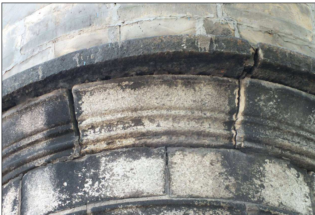
Rys. 5.86 Na zdjęciu powyżej widoczne rozległe zanieczyszczenia na powierzchni, spękania i ubytki w obrębie spoinowania oraz przemieszczenia kamiennych elementów gzymsu filara od strony wody górnej
