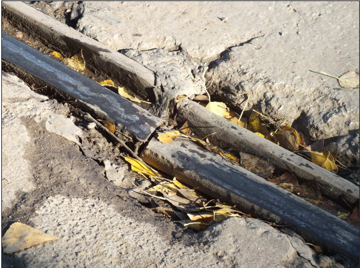
Rys. 5.108 Na zdjęciu powyżej widoczne przerwanie ciągłości w postaci pęknięcia szyny jezdnej nad przyczółkiem torowiska tramwajowego na obiekcie. Pęknięta szyna zagraża bezpieczeństwu poruszających się tramwajów oraz potęguje oddziaływania dynamiczne na obiekt przekazywane przez poruszający się tabor tramwajowy
