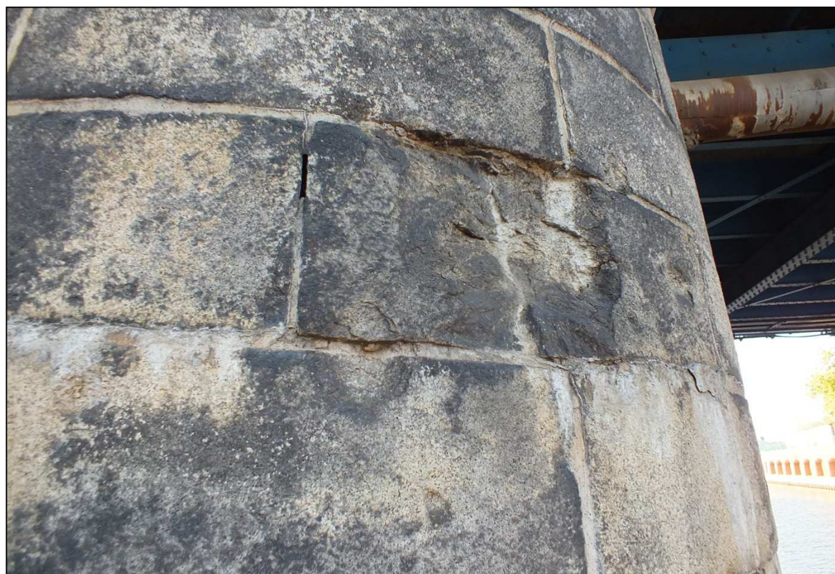
Rys. 5.90 Na zdjęciu powyżej widoczne powierzchniowe wykruszenia materiału kamiennej okładziny filara
