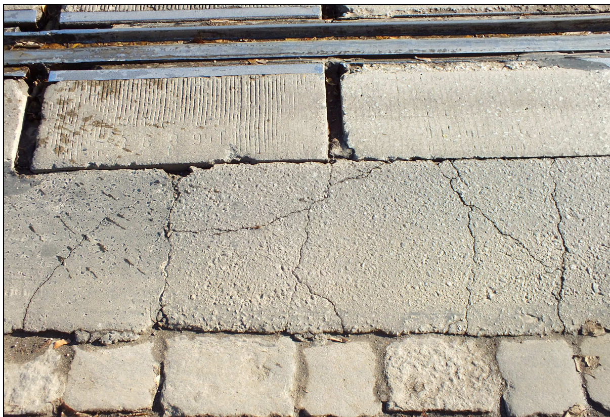
Rys. 5.6 Na zdjęciu powyżej widoczne liczne spękania na powierzchni bitumicznej nawierzchni jezdni pomiędzy torowiskiem tramwajowym i ściekiem z kostki granitowej
