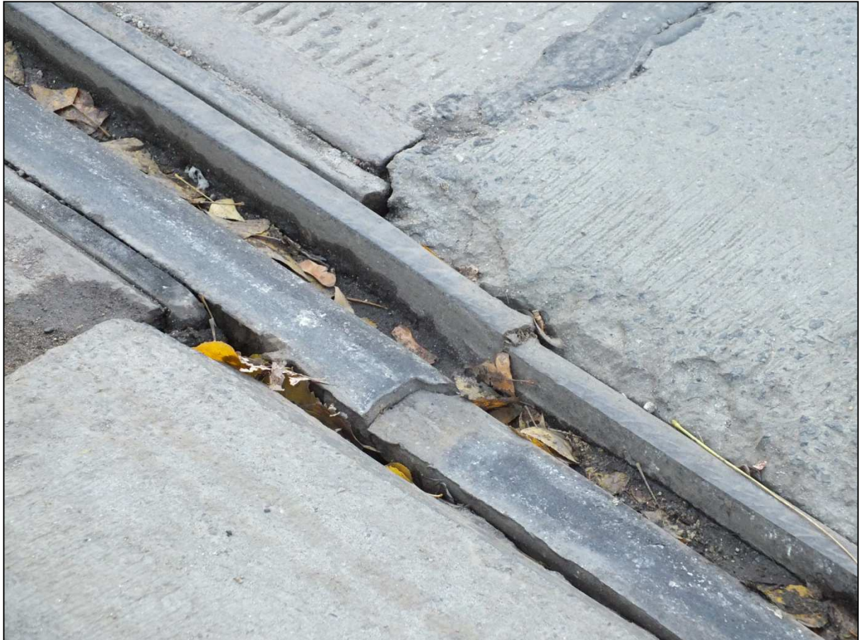
Rys. 5.107 Na zdjęciu powyżej widoczne przerwanie ciągłości w postaci pęknięcia szyny jezdnej nad podporą pośrednią torowiska tramwajowego na obiekcie. Pęknięta szyna zagraża bezpieczeństwu poruszających się tramwajów oraz potęguje oddziaływania dynamiczne na obiekt przekazywane przez poruszający się tabor tramwajowy
