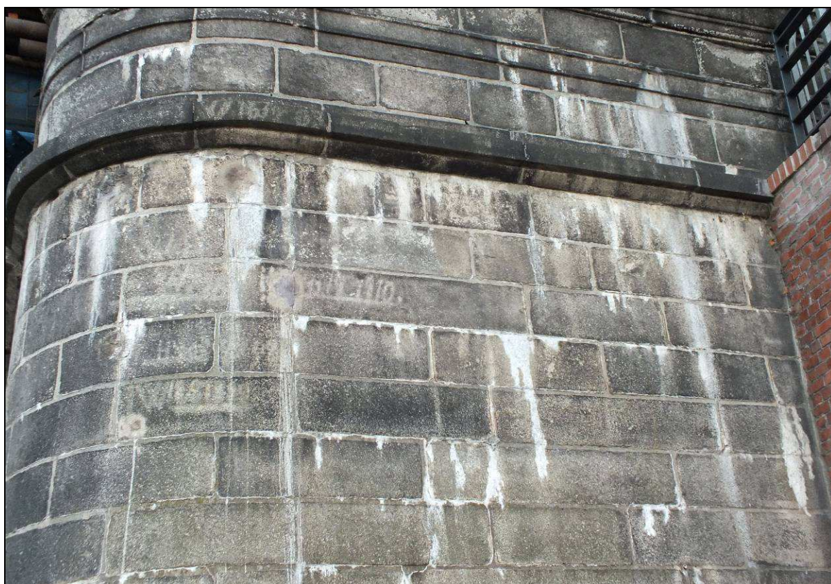
Rys. 5.60 Na zdjęciu powyżej widoczne liczne wylugowania w obrębie spoinowania kamiennej okładziny ściany bocznej od strony wody dolnej przyczółka od strony ul. Podwale
