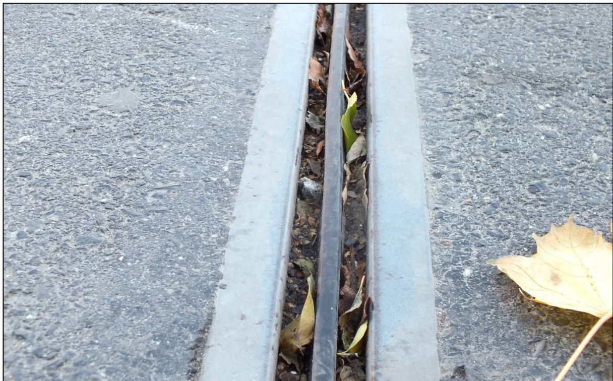
Rys. 5.152 Na zdjęciu powyżej widoczne zanieczyszczenia materiałem ziemnym i biologicznym w obrębie modułowego urządzenia dylatacyjnego w ciągu chodnika na obiekcie
