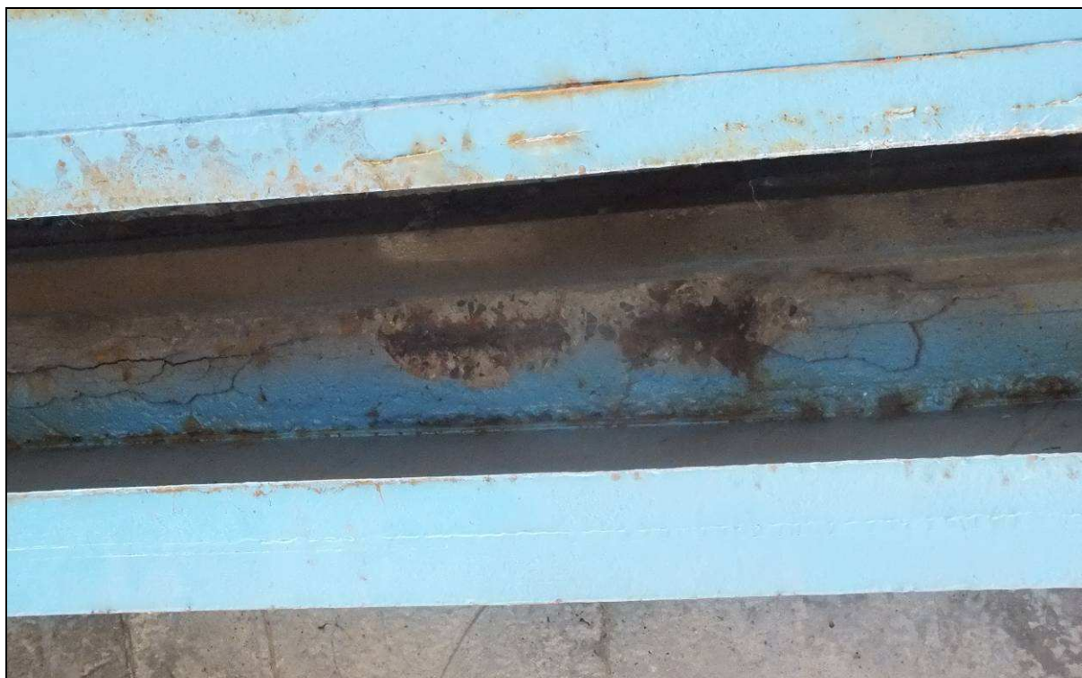
Rys. 5.43 Na zdjęciu powyżej widoczne liczne spękania i odspojenia betonu, korozyjne wykwyty oraz odsłonięte korodujące pręty zbrojenia wzdłuż krawędzi żelbetowej płyty pomostowej pod jezdnią
