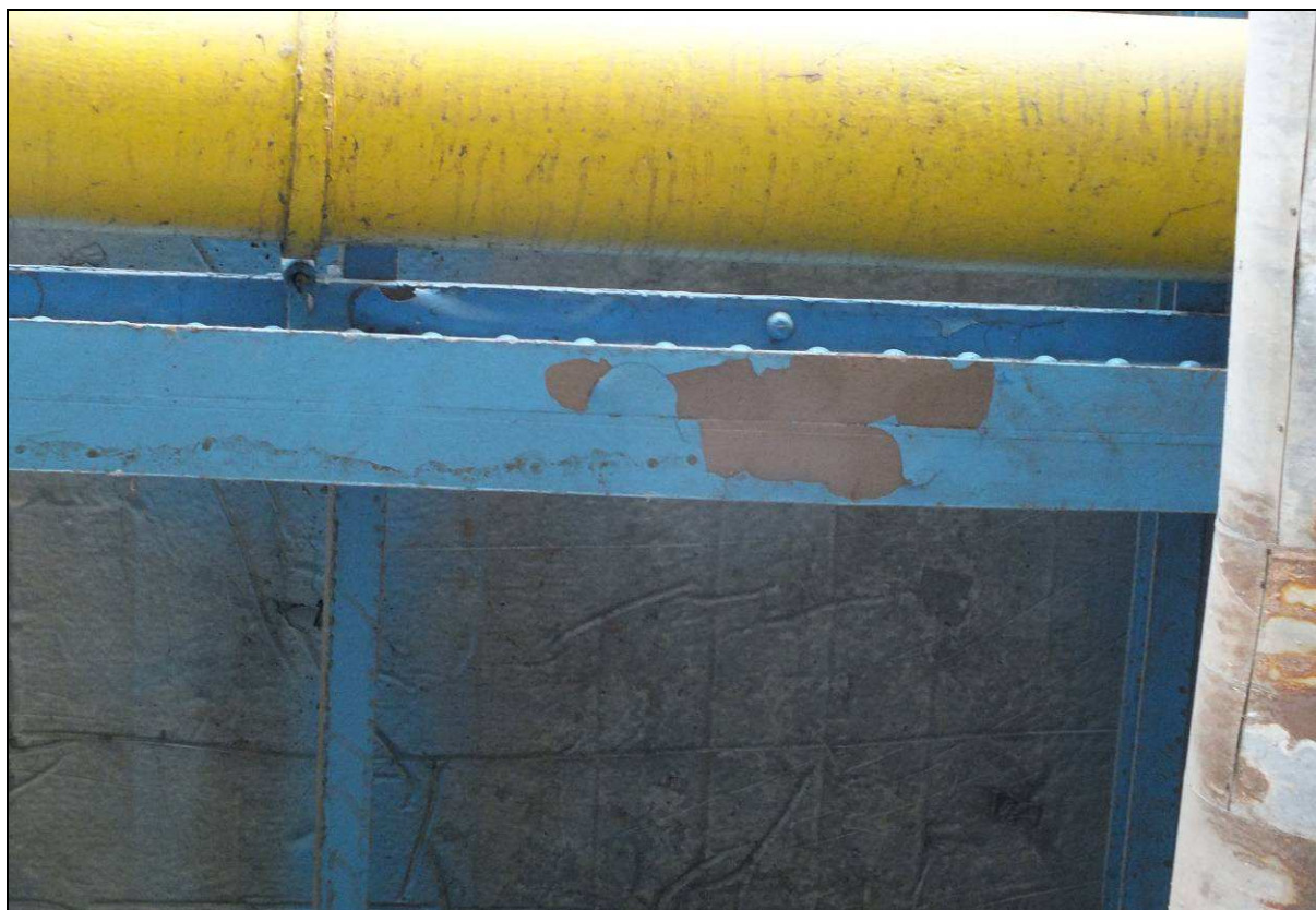
Rys. 5.28 Na zdjęciu powyżej widoczne odspojenia i ubytki powłok antykorozyjnych na powierzchni stalowej podłużnicy
