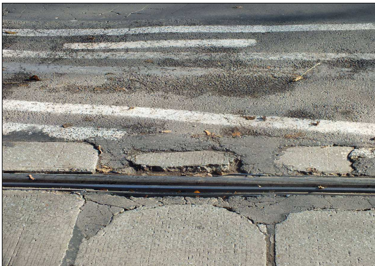
Rys. 5.3 Na zdjęciu powyżej widoczne ubytki wypełnione asfaltem w obrębie betonowych płyt torowiska tramwajowego na dojeździe do obiektu
