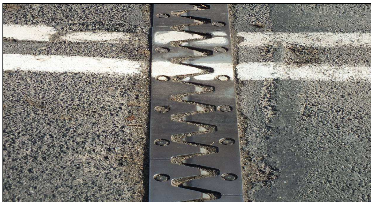
Rys. 5.154 Na zdjęciu powyżej widoczne zanieczyszczenia materiałem ziemnym ograniczające swobodę przemieszczeń stalowego urządzenia dylatacyjnego w ciągu jezdni na obiekcie
