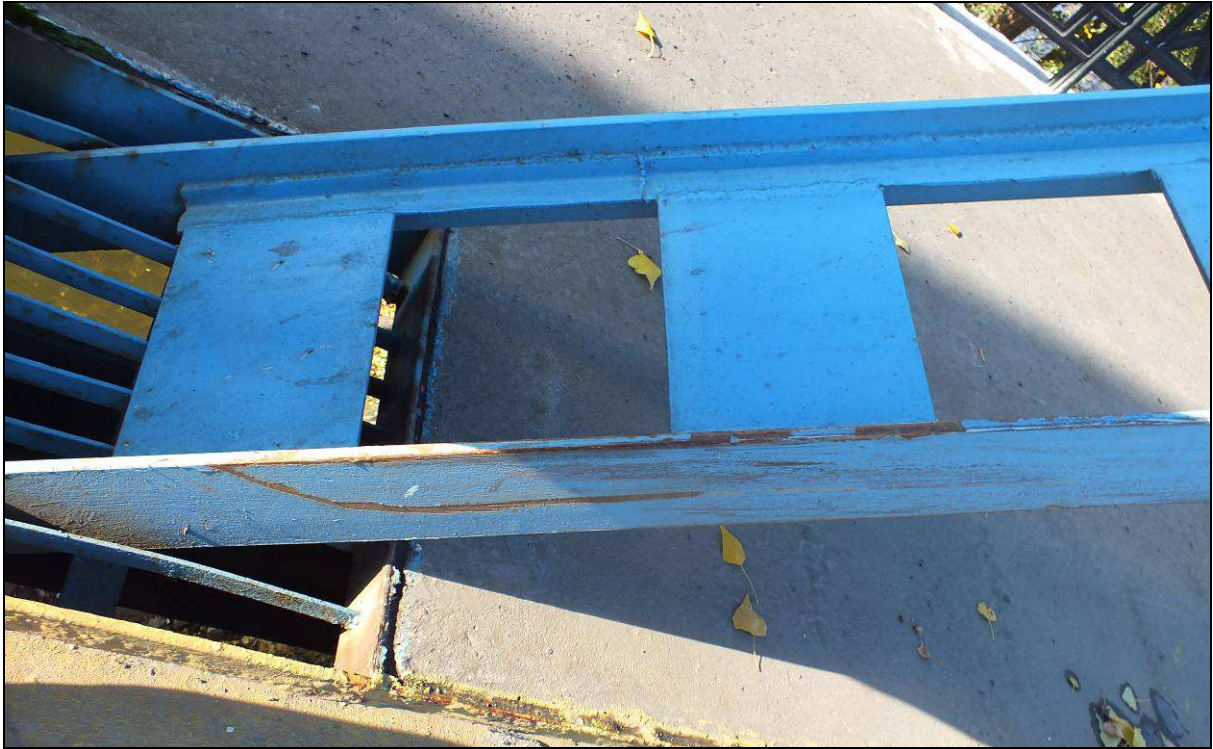
Rys. 5.15 Na zdjęciu powyżej widoczne uszkodzenie powłok ochronnych na powierzchni krzyżulca dźwigara kratownicowego od strony wody dolnej, uszkodzenie od strony jezdni nastąpiło w wyniku uderzenia przejeżdżającego pojazdu
