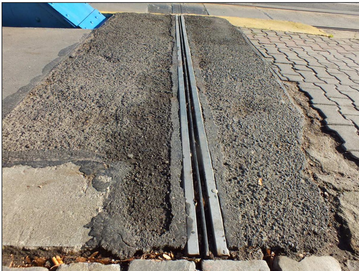
Rys. 5.158 Na zdjęciu powyżej widoczne wykruszenia i ubytki bitumicznej nawierzchni w obrębie modułowego urządzenia dylatacyjnego w ciągu chodnika na obiekcie
