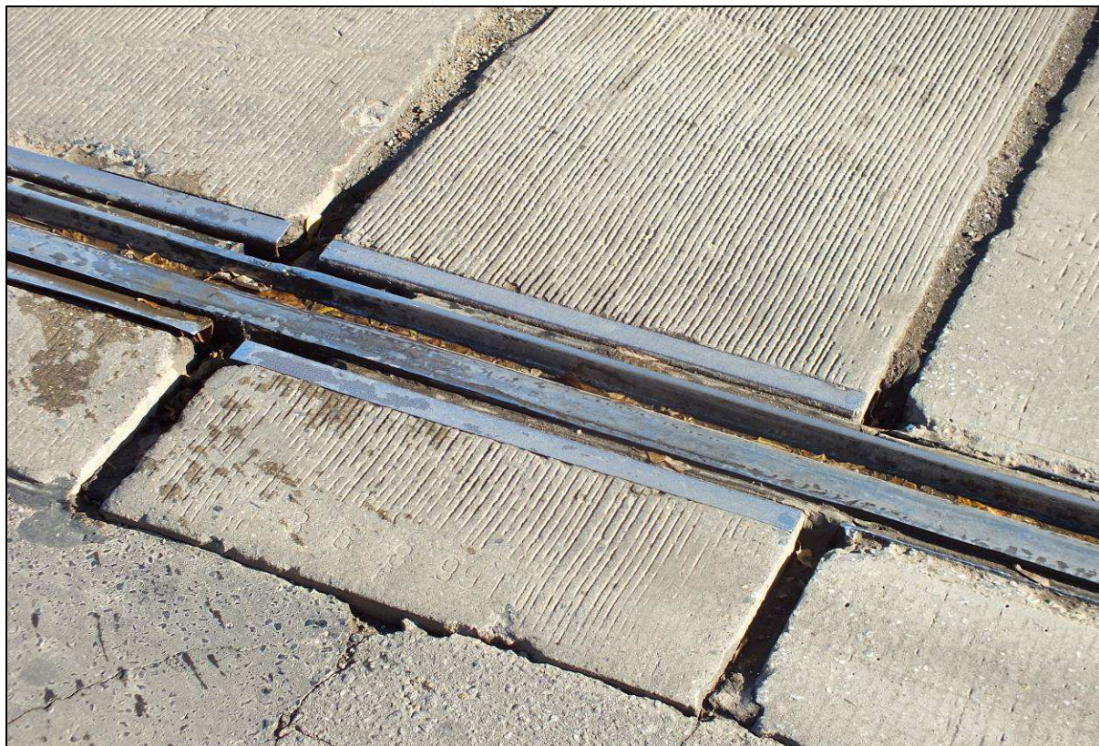
Rys. 5.2 Na zdjęciu powyżej widoczne ubytki w spoinowaniu pomiędzy betonowymi płytami torowiska tramwajowego na dojeździe do obiektu
