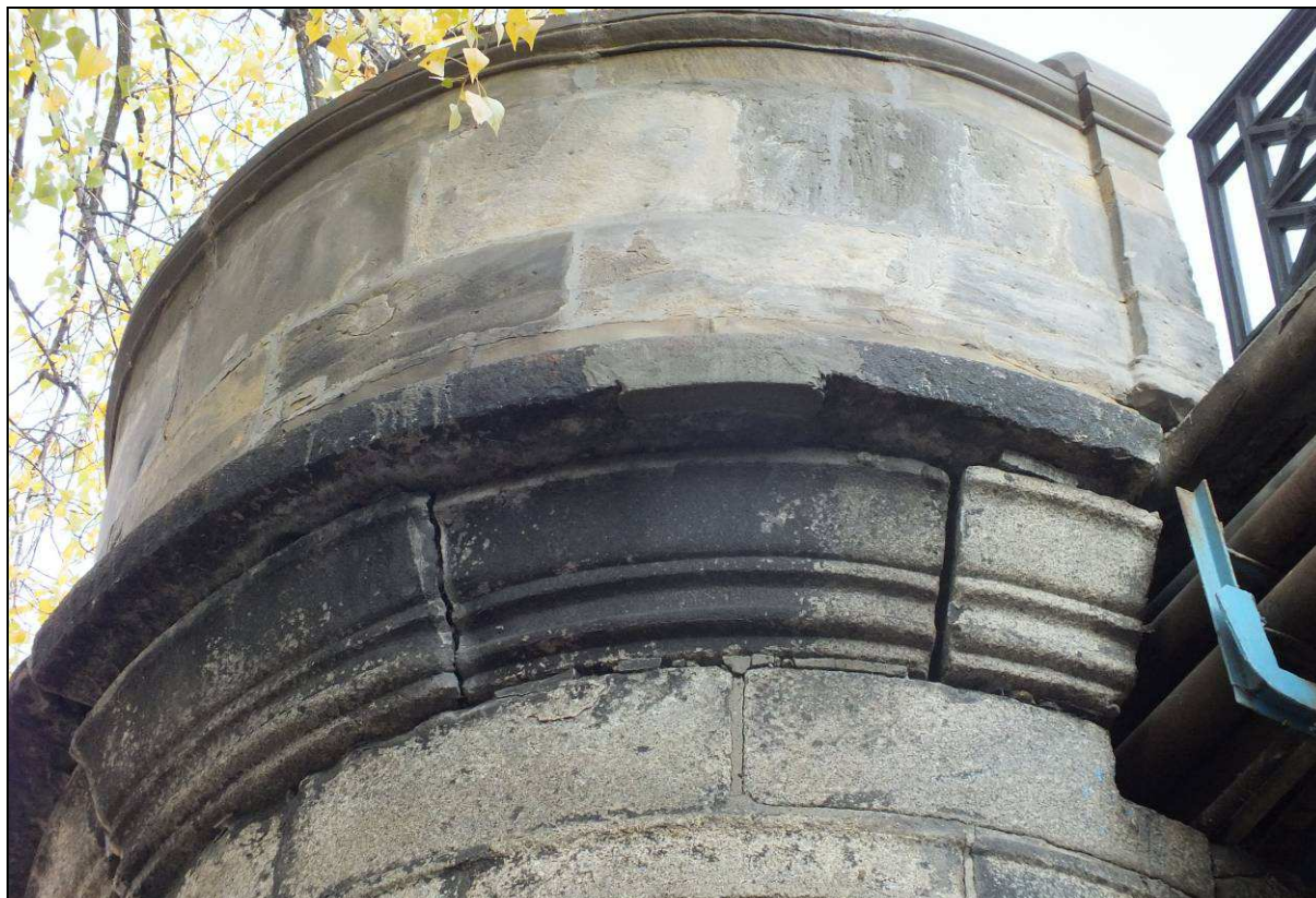
Rys. 5.85 Na zdjęciu powyżej widoczne spękania i ubytki w obrębie spoinowania oraz przemieszczenia kamiennych elementów gzymsu filara od strony wody dolnej
