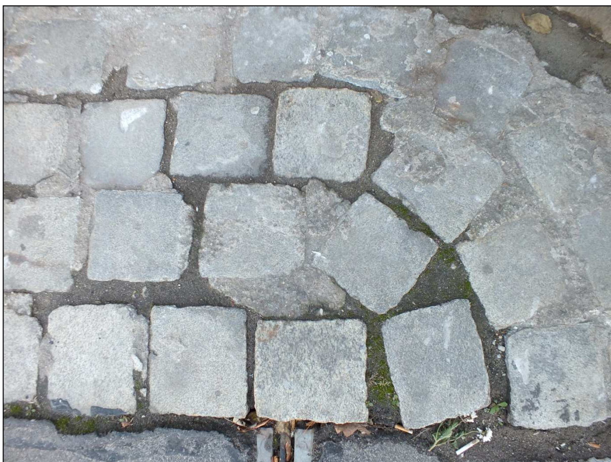
Rys. 5.119 Na zdjęciu powyżej widoczne ubytki w spoinowaniu, zanieczyszczenia materiałem ziemnym oraz towarzysząca wegetacja mchów pomiędzy kamiennymi elementami brukowanej nawierzchni galerii widokowej nad podporą
