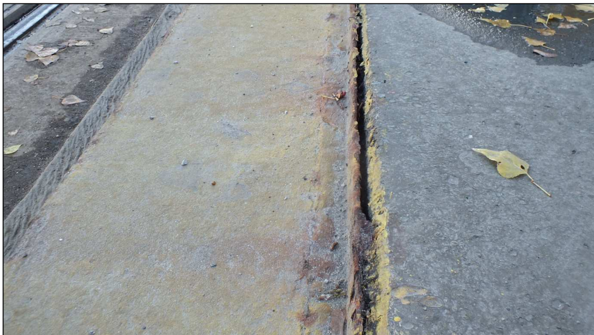
Rys. 5.126 Na zdjęciu powyżej widoczna powierzchniowa korozja stalowego okucia oraz szczelina pomiędzy okuciem a bitumiczną nawierzchnią chodnika na obiekcie
