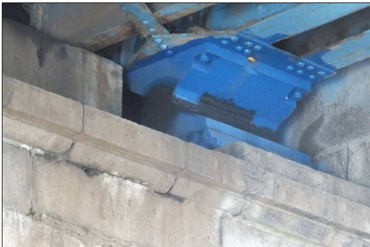
Rys. 5.97 Na zdjęciu powyżej widoczny stan techniczny stalowego łożyska ruchomego oraz oparcia podłużnicy
