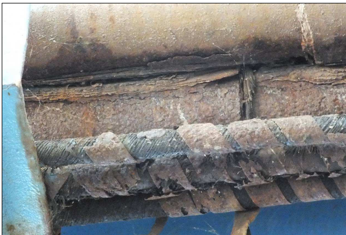
Rys. 5.180 Na zdjęciu powyżej widoczna intensywna korozja powierzchniowa wraz z towarzyszącymi wżerami, perforacjami i rozwarstwieniami materiału rur osłonowych sieci obcych podwieszonych pod obiektem od strony wody dolnej
