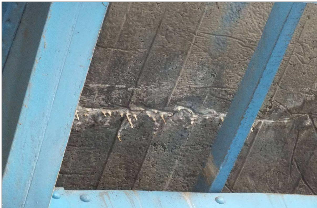
Rys. 5.54 Na zdjęciu powyżej widoczne miejscowe wykwyty i wyługowania wapienne w obrębie poprzecznego zarysowania żelbetowej płyty chodnikowej
