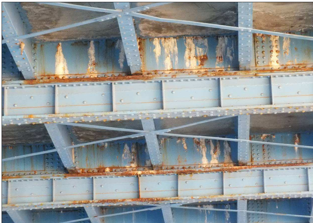
Rys. 5.32 Na zdjęciu powyżej widoczne liczne, rozległe wapienne zacieki oraz intensywną korozję na powierzchni stalowych poprzecznic i podłużnic, zacieki świadczą o nieszczelnej izolacji
