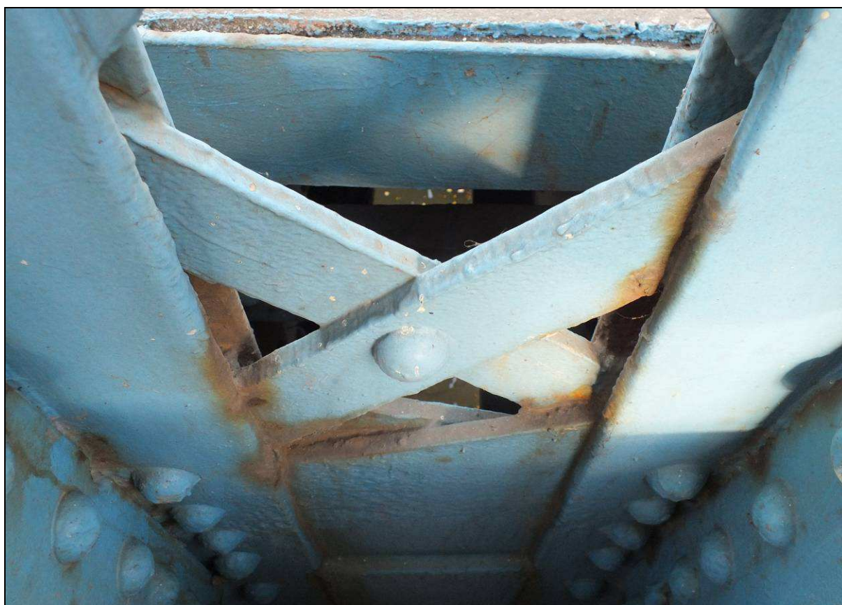
Rys. 5.18 Na zdjęciu powyżej widoczne liczne ogniska korozji na powierzchni elementów słupka dźwigara kratownicowego w obrębie przejścia elementu przez płytę wspornika podchodnikowego
