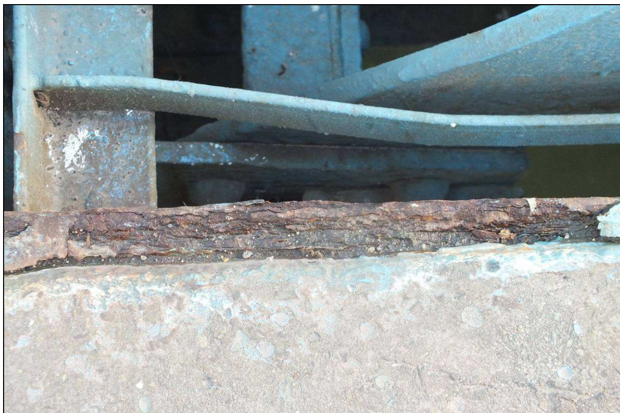
Rys. 5.26 Na zdjęciu powyżej widoczna intensywna korozja wżerowa wraz z towarzyszącymi rozwarstwieniami materiału stalowego okucia w miejscu przejścia krzyżulca dźwigara kratownicowego przez płytę chodnikowa
