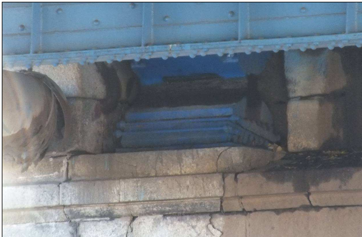
Rys. 5.98 Na zdjęciu powyżej widoczny stan techniczny stalowego łożyska ruchomego
