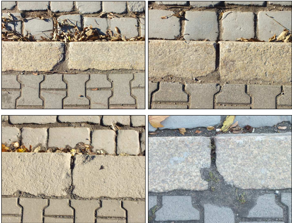
Rys. 5.130 Na zdjęciach powyżej widoczne liczne przykłady braku spoinowania pomiędzy segmentami oraz powierzchniowych wykruszeń materiału kamiennych krawężników na dojazdach, głównie w obrębie naroży i przerw pomiędzy poszczególnymi segmentami
