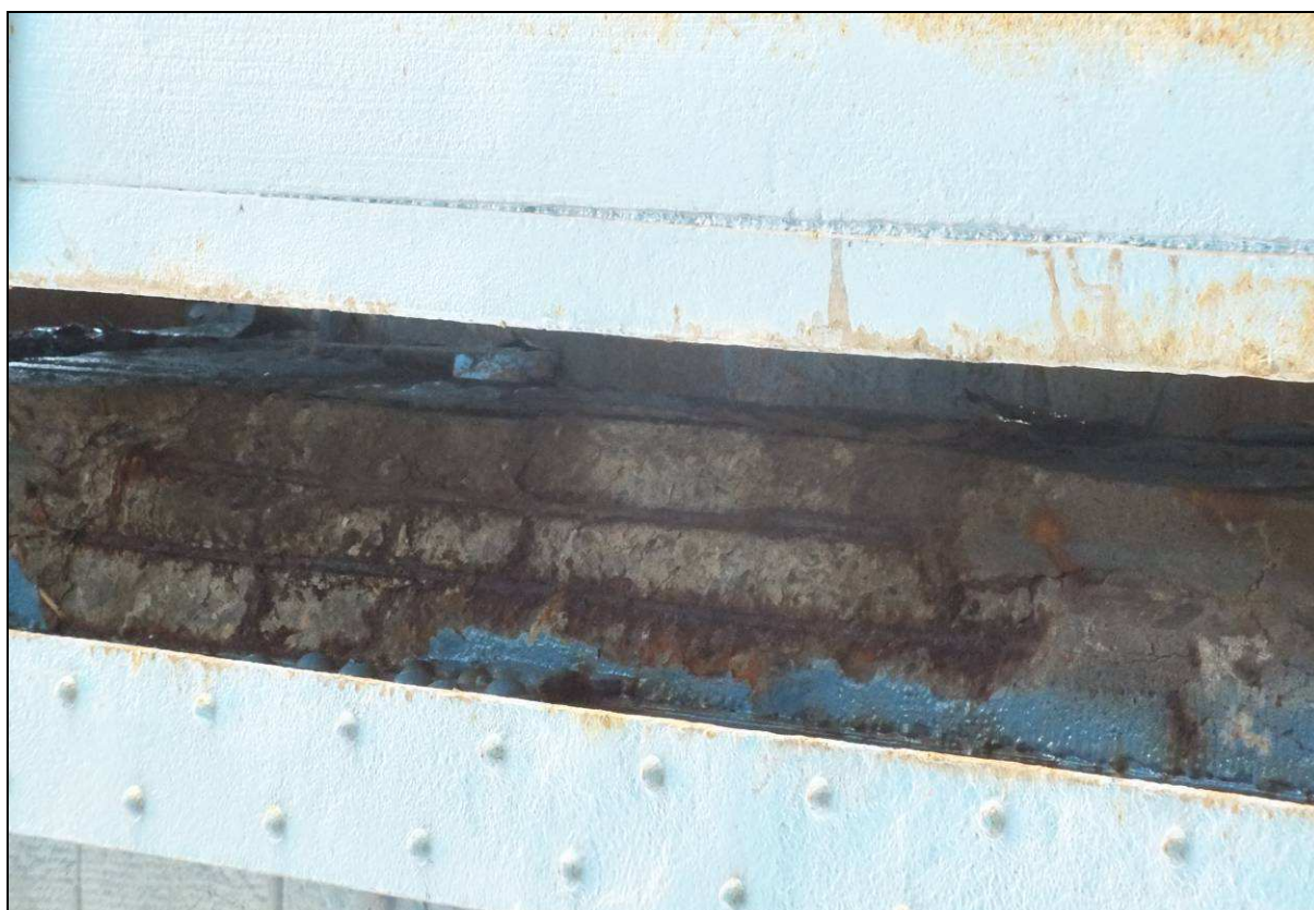
Rys. 5.44 Na zdjęciu powyżej widoczne rozległe ubytki betonu oraz odsłonięte korodujące pręty zbrojenia w dwóch warstwach wzdłuż krawędzi żelbetowej płyty pomostowej pod jezdnią, widoczne jest zniszczenie struktury materiału
