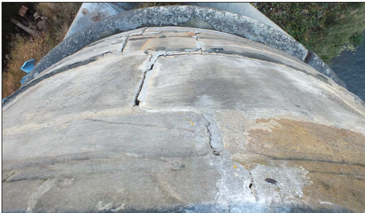
Rys. 5.148 Na zdjęciu powyżej widoczne spękania wzdłuż spoinowania oraz przemieszczenia elementów kamiennej balustrady w obrębie galerii widokowej nad podporą pośrednią
