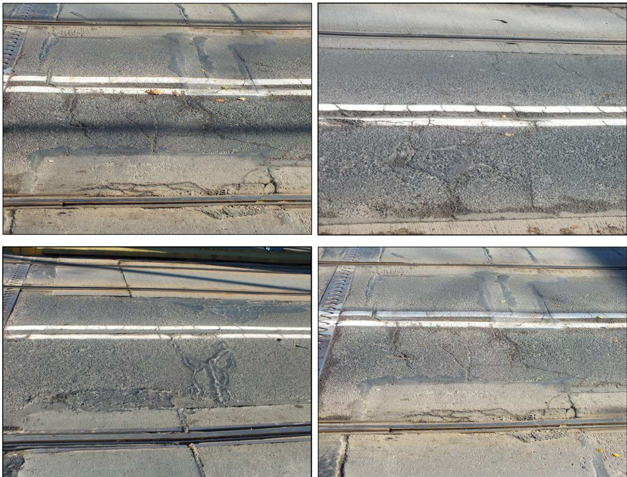
Rys. 5.109 Na zdjęciach powyżej widoczne liczne przykłady rozległych siatek spękań oraz powierzchniowych wykruszeń bitumicznej nawierzchni jezdni pomiędzy torowiskami tramwajowymi na obiekcie
