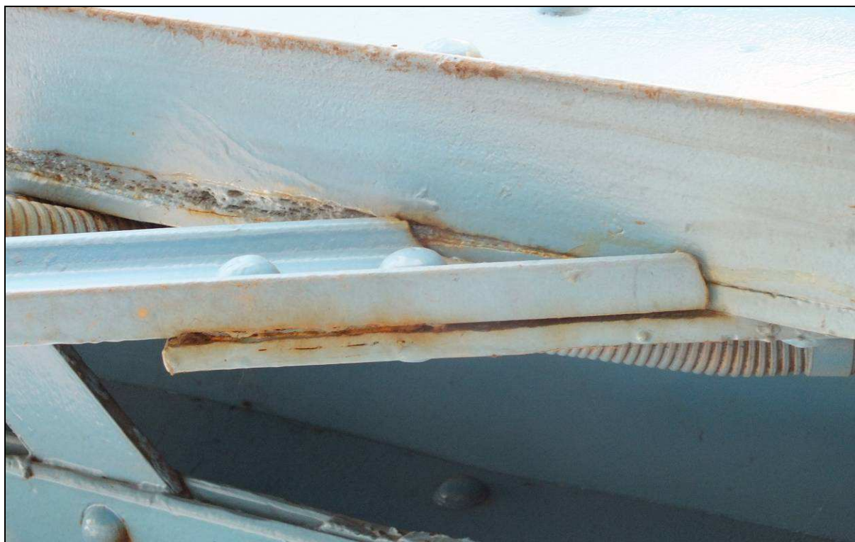
Rys. 5.17 Na zdjęciu powyżej widoczne ogniska korozji szczelinowej w obrębie połączeń stalowych elementów dźwigara kratownicowego
