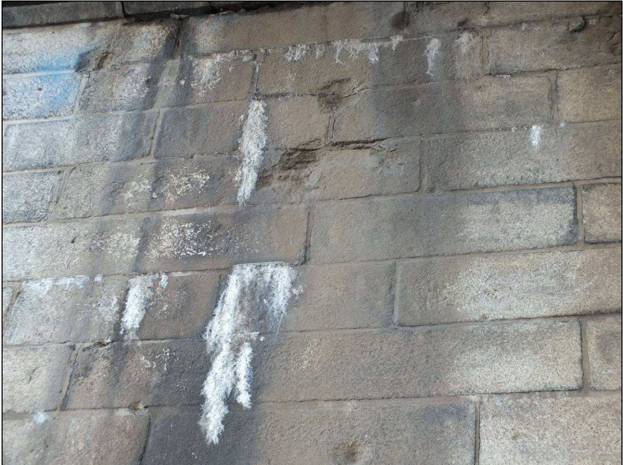
Rys. 5.65 Na zdjęciu powyżej widoczne liczne wyługowania w obrębie spoinowania oraz miejscowe wykruszenia i ubytki na powierzchni kamiennej okładziny ściany czołowej przyczółka od strony ul. Mostowej
