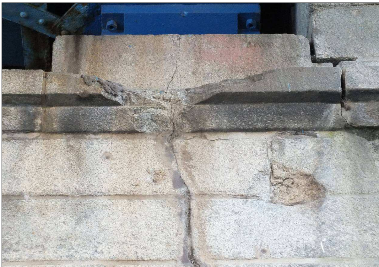
Rys. 5.72 Na zdjęciu powyżej widoczne miejscowe wykruszenie kamiennego gzymsu oraz pionowe pęknięcie kamiennego ciosu podłożyskowego, przechodzące dalej w pęknięcie ściany czołowej przyczółka od strony ul. Podwale od strony wody dolnej
