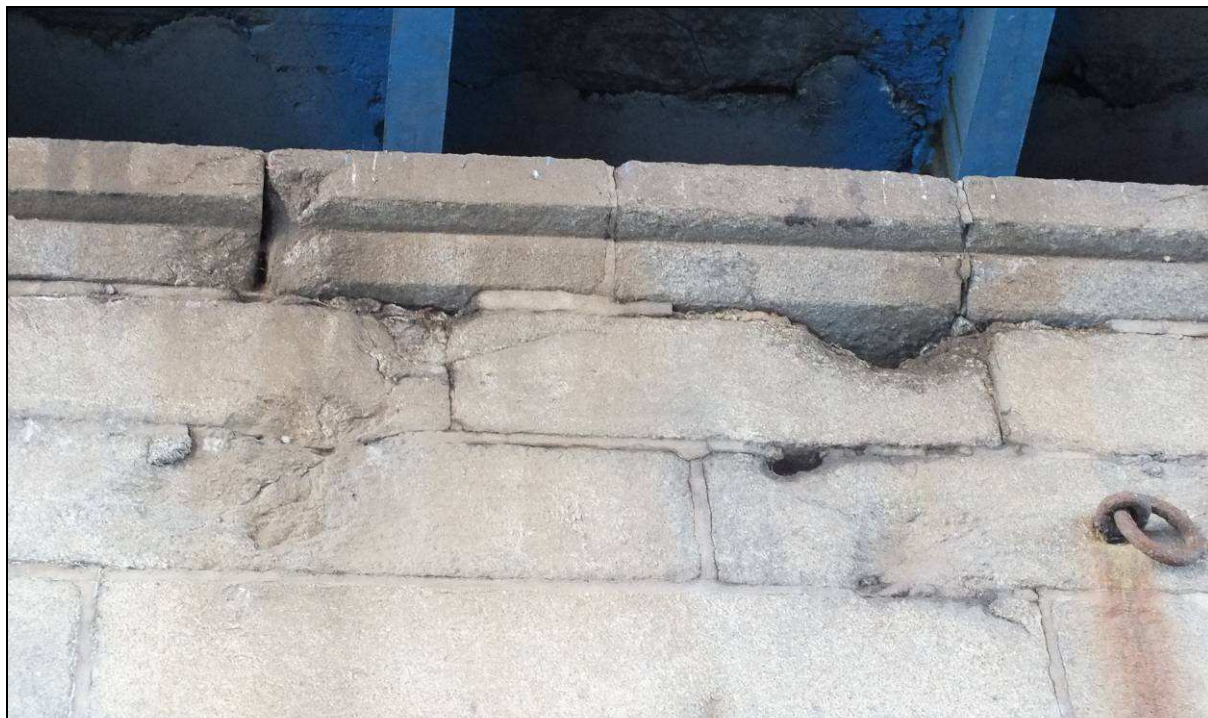
Rys. 5.67 Na zdjęciu powyżej widoczne ubytki spoinowania oraz spękania, wykruszenia i ubytki materiału kamiennych elementów okładziny przyczółka w obrębie niszy podłożyskowej
