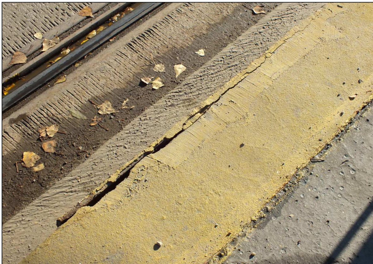
Rys. 5.128 Na zdjęciu powyżej widoczne odspojenia stalowego płaskownika ograniczającego beton krawężnika
