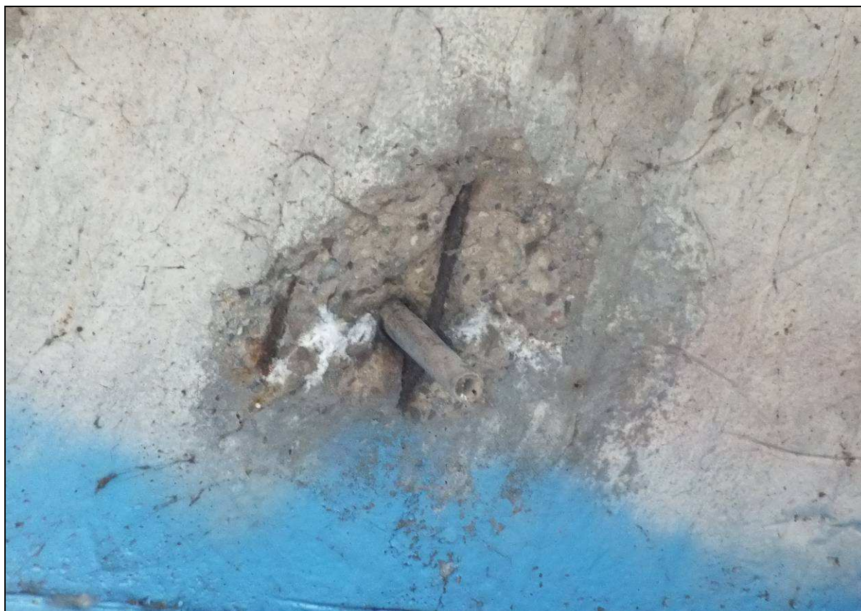
Rys. 5.42 Na zdjęciu powyżej widoczny miejscowy ubytek betonu, wapienne wyługowania oraz odsłonięte, korodujące pręty zbrojeniowe
