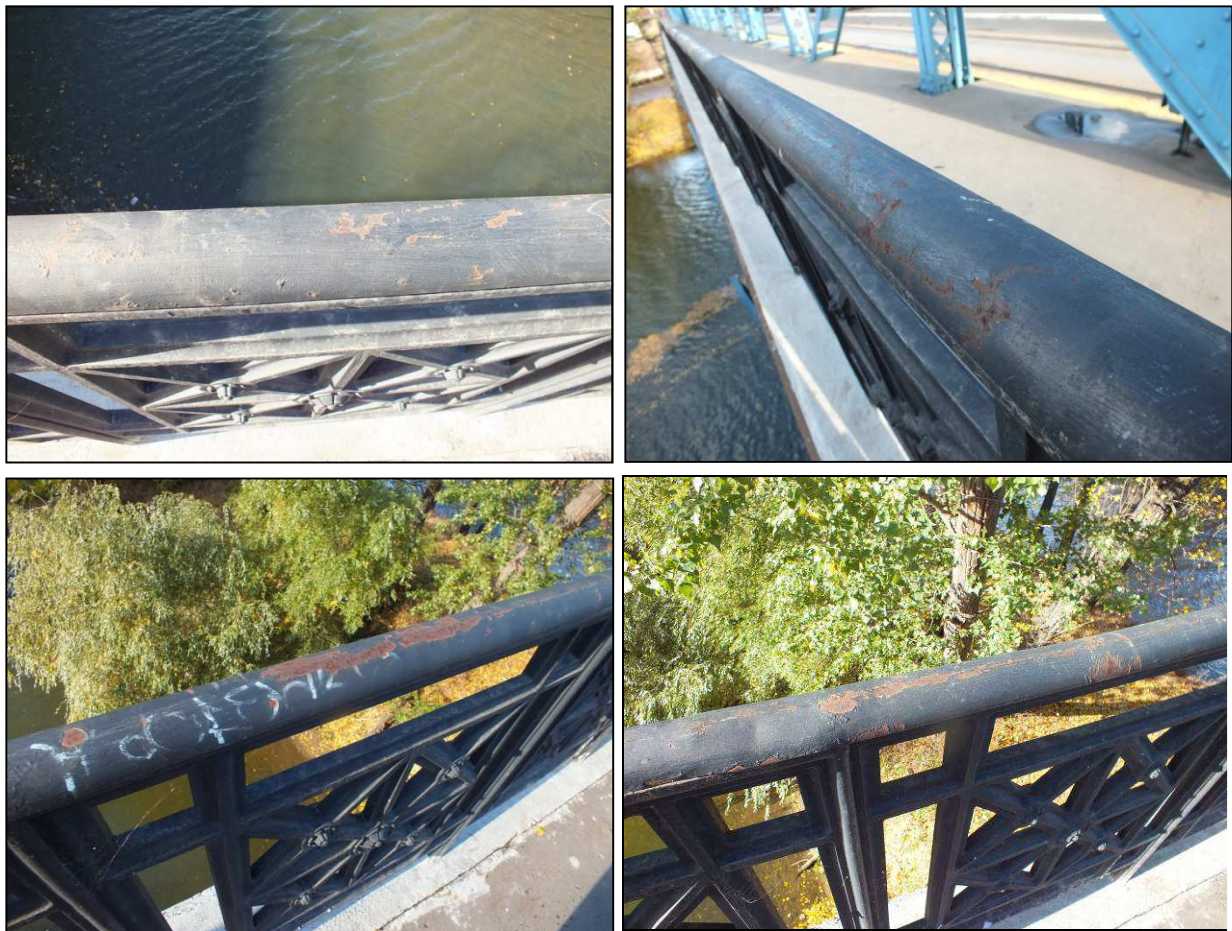
Rys. 5.132 Na zdjęciach powyżej widoczne liczne przykłady rozległej destrukcji powłok antykorozyjnych oraz licznych towarzyszących ognisk korozji na górnej powierzchni stalowych pochwyków balustrad na obiekcie
