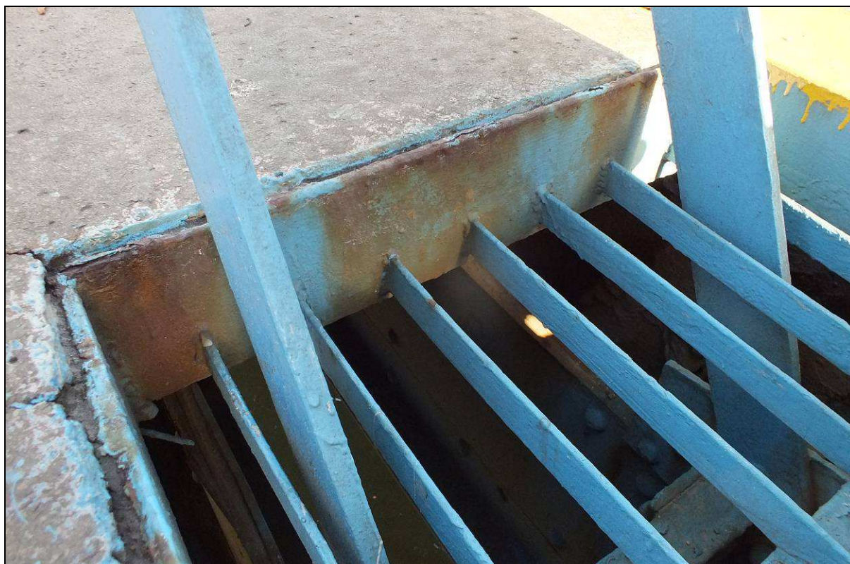
Rys. 5.25 Na zdjęciu powyżej widoczna intensywna korozja powierzchniowa i wżerowa wraz z towarzyszącymi wżerami materiału stalowego okucia w miejscu przejścia krzyżulca dźwigara kratownicowego przez płytę chodnikowa
