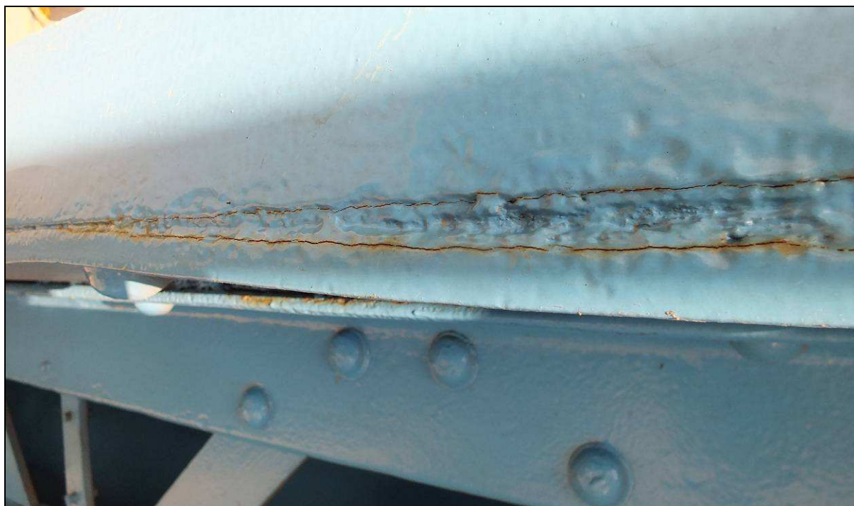
Rys. 5.23 Na zdjęciu powyżej widoczna korozja szczelinowa na połączeniu elementów dźwigara kratownicowego wraz z towarzyszącą deformacją elementów stalowych w wyniku gromadzenia się produktów korozji na połączeniu
