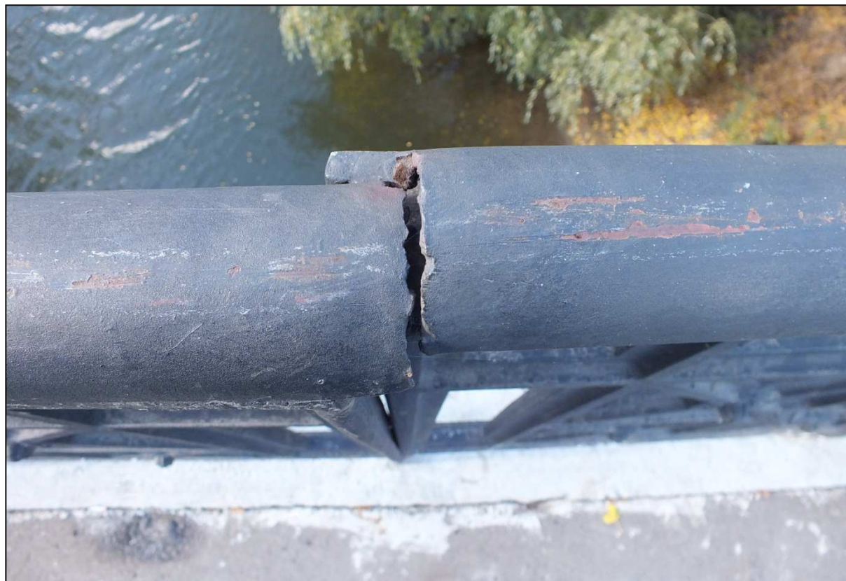
Rys. 5.137 Na zdjęciu powyżej widoczne miejscowe pęknięcie pochwyty oraz towarzyszące przemieszczenie segmentów stalowej balustrady na obiekcie od strony wody dolnej
