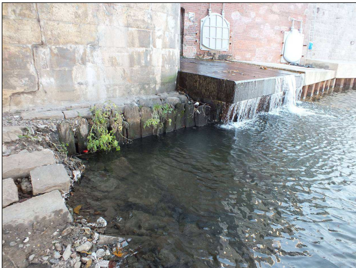
Rys. 5.79 Na zdjęciu powyżej widoczny rozległy ubytek umocnienia fundamentów przyczółka od strony ul. Podwale od strony wody dolnej w obrębie wypadu z kanałów ściekowych
