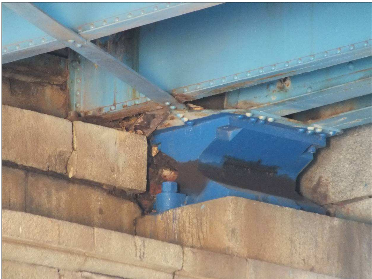
Rys. 5.95 Na zdjęciu powyżej widoczny stan techniczny stalowego łożyska stałego oraz oparcia podłużnicy
