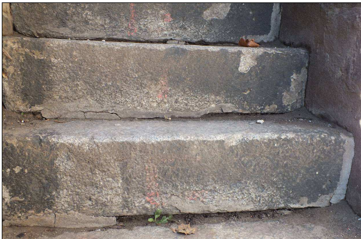
Rys. 5.168 Na zdjęciu powyżej widoczne ubytki spoinowania pomiędzy kamiennymi stopniami schodów skarpowych od strony ul. Mostowej od strony wody dolnej, widoczne również powierzchniowe zanieczyszczenia i wykruszenia materiału
