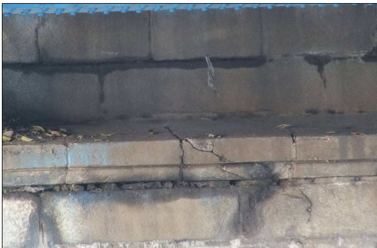
Rys. 5.62 Na zdjęciu powyżej widoczne liczne ubytki spoinowania oraz spękania i wykruszenia na powierzchni kamiennych elementów niszy podłożyskowej przyczółka, widoczne również zawilgocenia w obrębie spoinowania ścianki zapleczej
