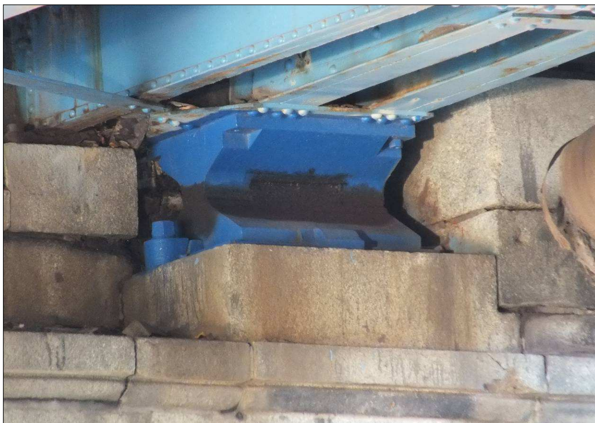
Rys. 5.96 Na zdjęciu powyżej widoczny stan techniczny stalowego łożyska stałego oraz oparcia podłużnicy
