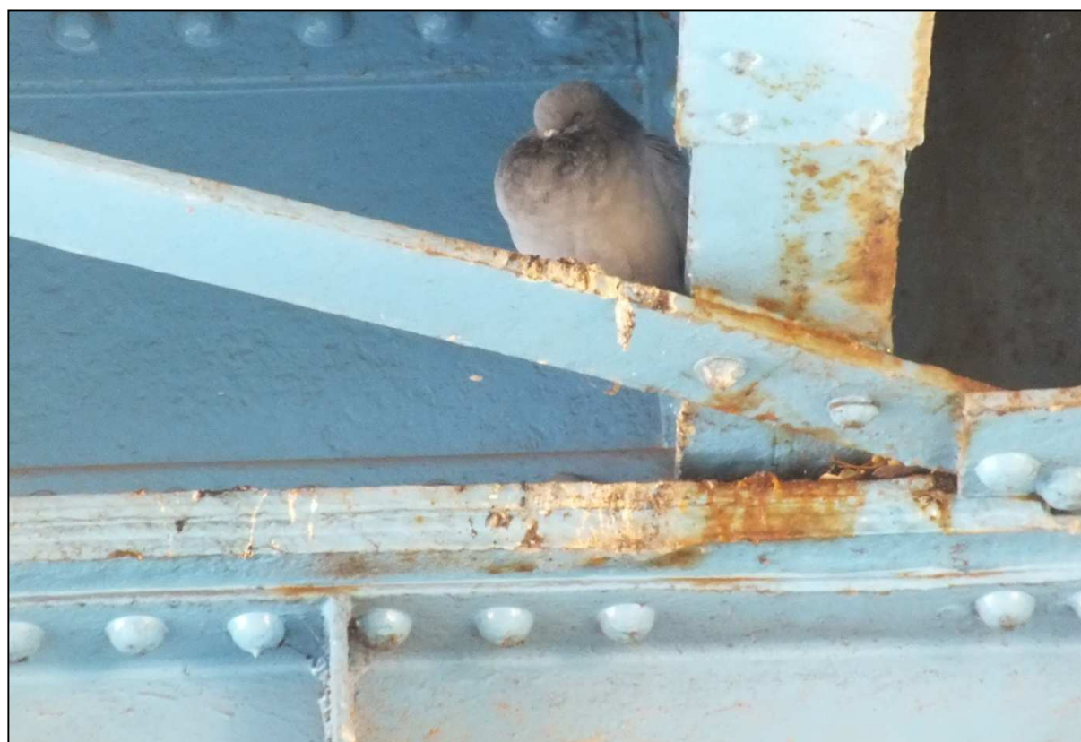
Rys. 5.29 Na zdjęciu powyżej widoczne zanieczyszczenia ptasimi odchodami oraz rozległe ogniska korozji powierzchniowej w obrębie węzła konstrukcji stalowej
