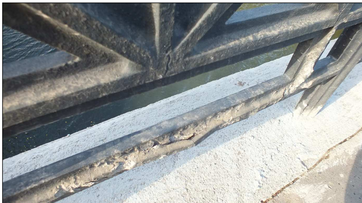
Rys. 5.133 Na zdjęciu powyżej widoczne rozległe wykruszenia i ubytki na powierzchni elementów wypełnienia stalowej balustrady na obiekcie od strony wody dolnej
