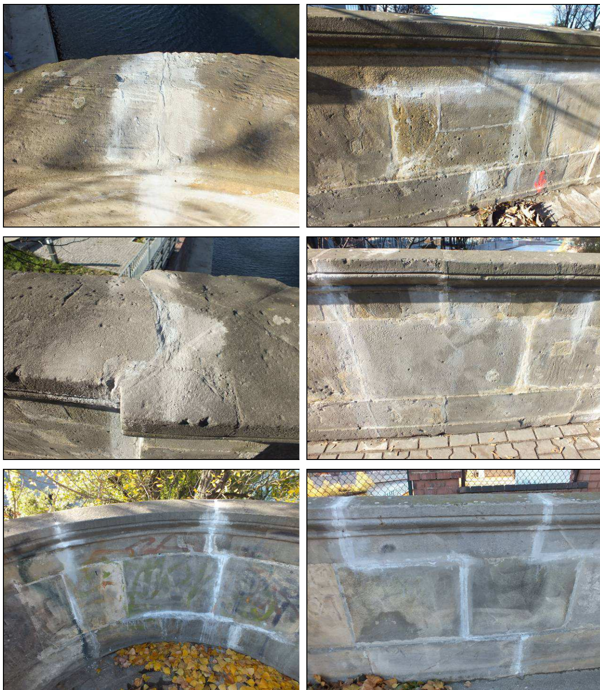
Rys. 5.147 Na zdjęciach powyżej widoczne liczne przykłady śladów po wcześniejszych naprawach kamiennych balustrad w obrębie galerii widokowych i przyczółków
