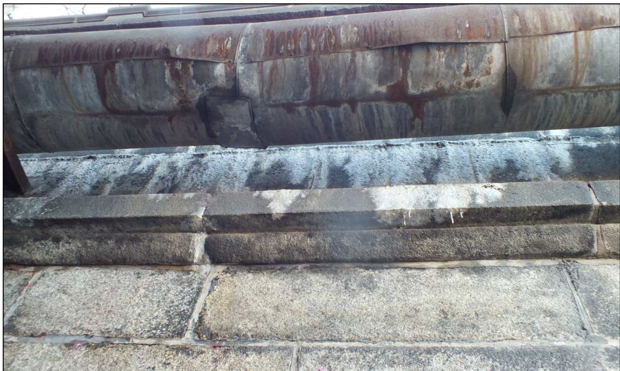
Rys. 5.66 Na zdjęciu powyżej widoczne liczne wyługowania w obrębie spoinowania na powierzchni kamiennej okładziny skrzydła przyczółka
