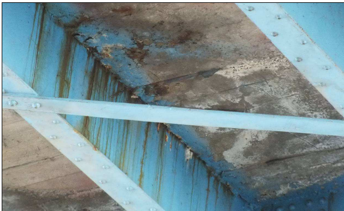
Rys. 5.39 Na zdjęciu powyżej widoczne liczne korozyjne wykwyty i zacieki na spodzie żelbetowej płyty pomostowej, intensywne zacieki występują wzdłuż stalowych podłużnic i poprzecznic
