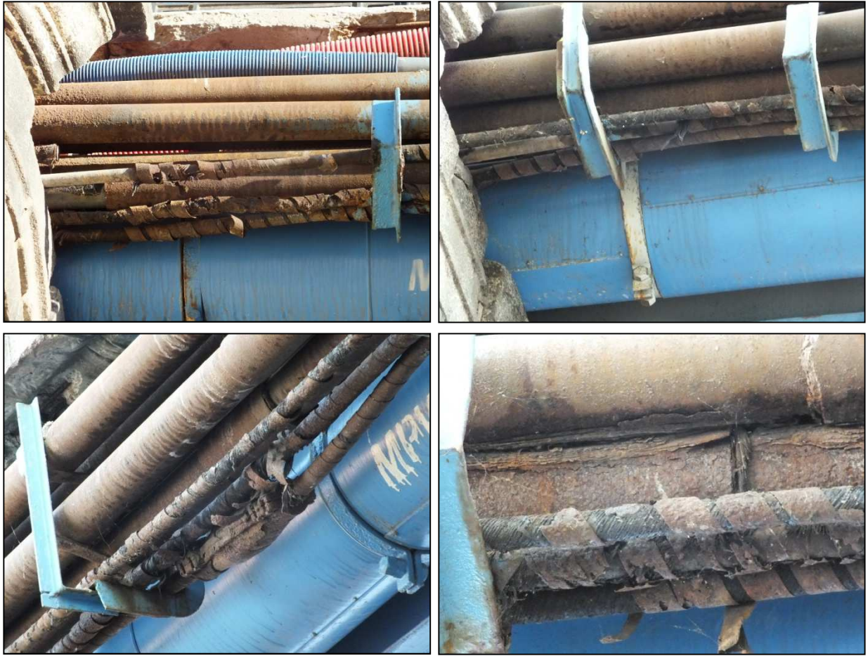
Rys. 5.181 Na zdjęciach powyżej widoczne liczne przykłady intensywnej korozji powierzchniowej wraz z towarzyszącymi wżerami, perforacjami i rozwarstwieniami materiału rur osłonowych sieci obcych podwieszonych pod obiektem od strony wody dolnej
