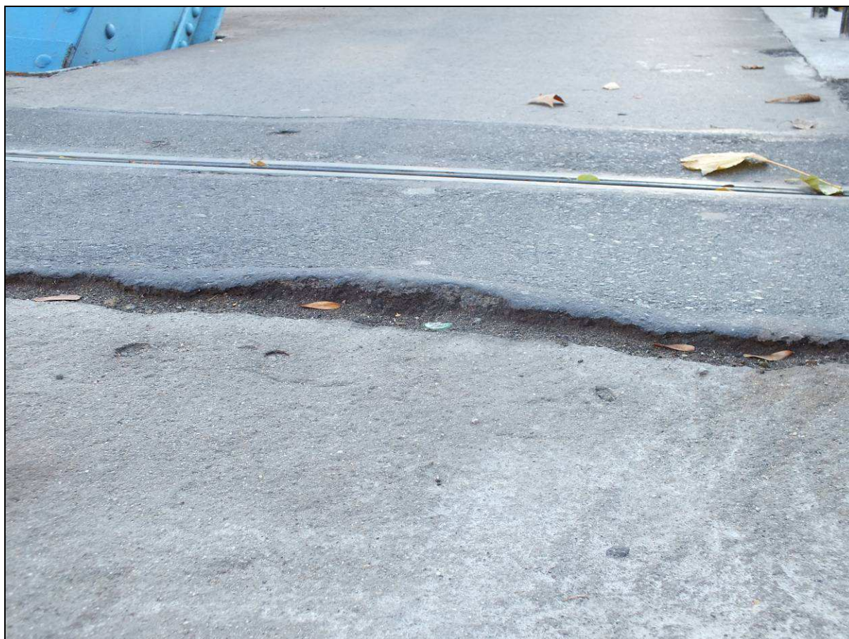
Rys. 5.159 Na zdjęciu powyżej widoczny uskok w ciągu chodnika w obrębie modułowego urządzenia dylatacyjnego
