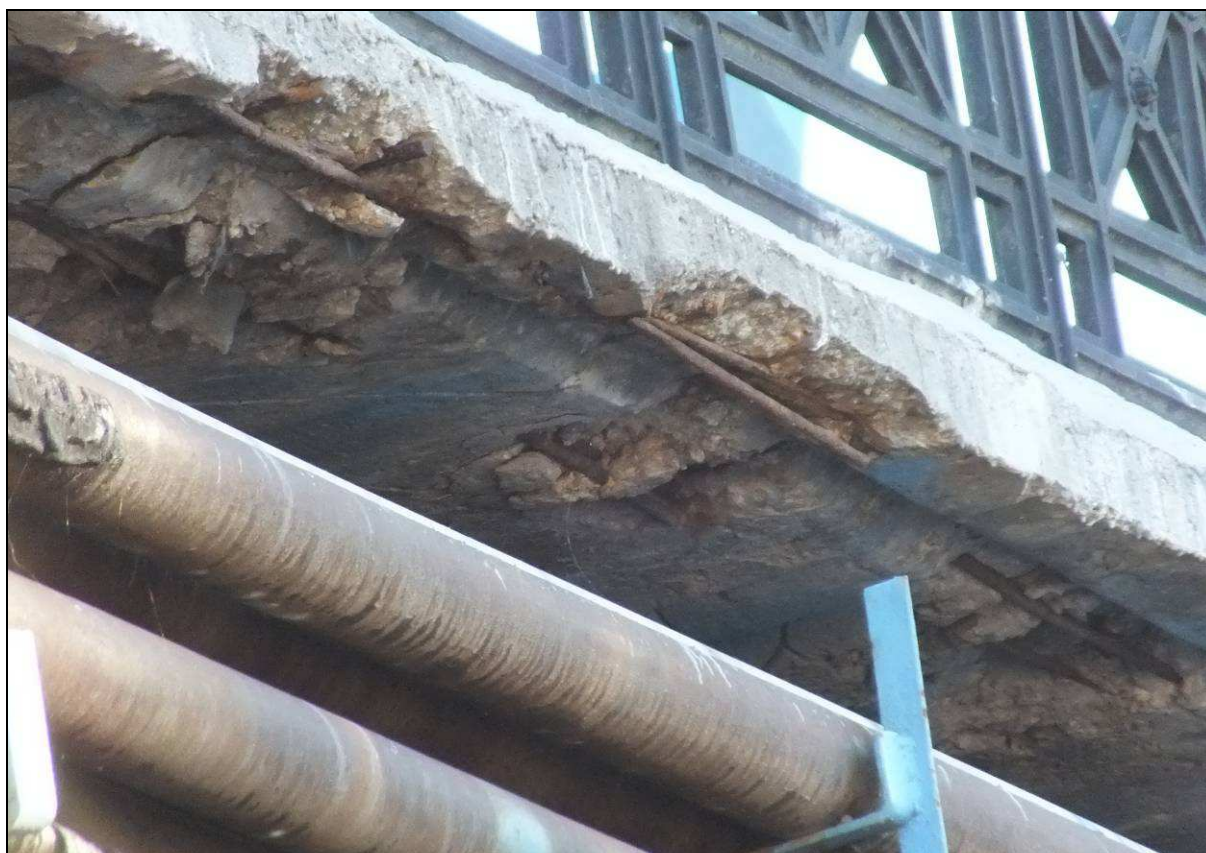
Rys. 5.50 Na zdjęciu powyżej widoczne rozległe ubytki betonu na spodzie żelbetowej płyty chodnikowej wraz z towarzyszącymi odsłoniętymi korodującymi prętami zbrojeniowymi w dwóch warstwach, widoczne jest zniszczenie struktury materiału
