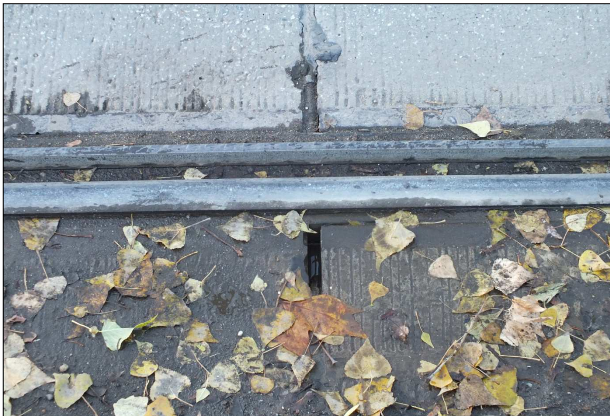
Rys. 5.104 Na zdjęciu powyżej widoczny miejscowy ubytek spoinowania pomiędzy betonowymi płytami torowiska tramwajowego na obiekcie
