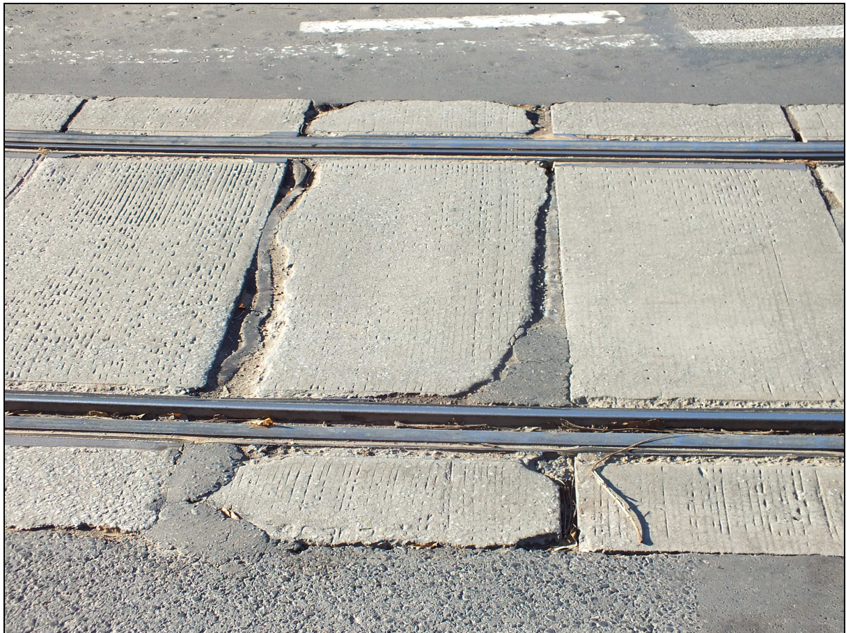
Rys. 5.5 Na zdjęciu powyżej widoczne ubytki w obrębie betonowych płyt torowiska tramwajowego na dojeździe do obiektu
