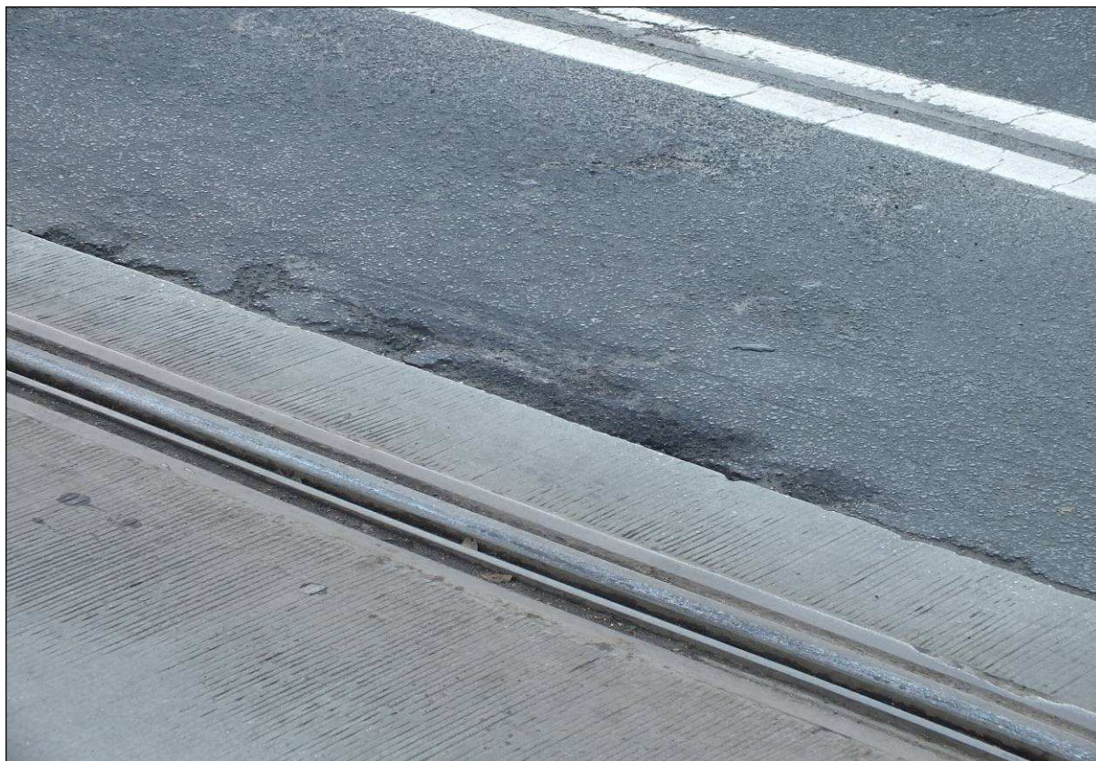
Rys. 5.112 Na zdjęciu powyżej widoczne ubytki bitumicznej nawierzchni na połączeniu z betonowymi płytami torowiska tramwajowego
