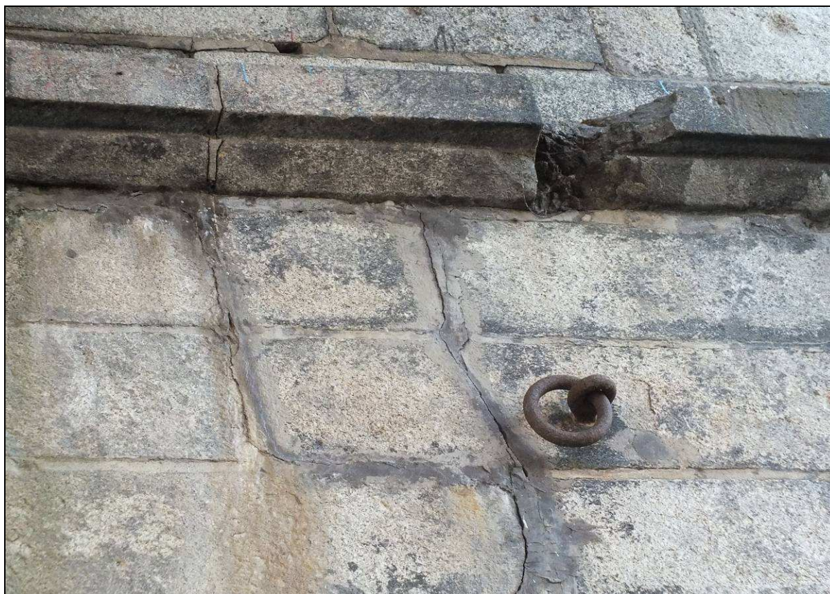
Rys. 5.73 Na zdjęciu powyżej widoczne spękania i ubytki spoinowania, ubytek materiału kamiennego gzymsu oraz spękania kamiennej okładziny przyczółka
