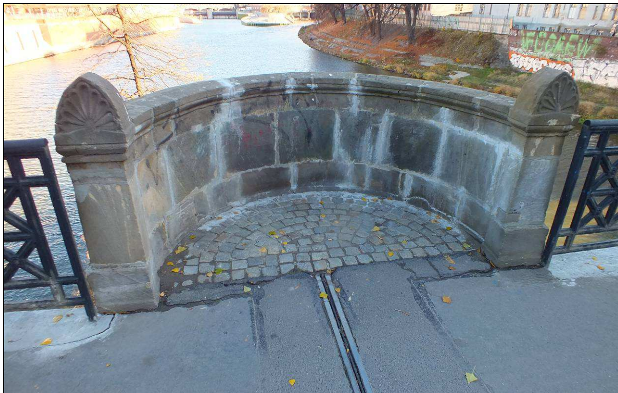
Rys. 5.145 Na zdjęciu powyżej widoczne ślady po wcześniejszych naprawach spoinowania kamiennych balustrad galerii widokowej nad podporą pośrednią od strony wody górnej
