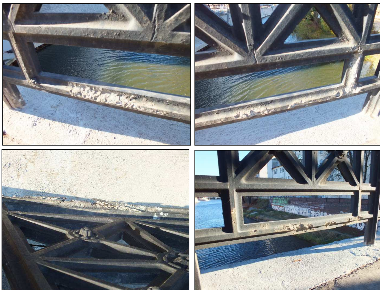
Rys. 5.134 Na zdjęciach powyżej widoczne liczne przykłady miejscowych zarysowań oraz rozległe wykruszeń i ubytków na powierzchni elementów wypełnienia stalowych balustrad na obiekcie
