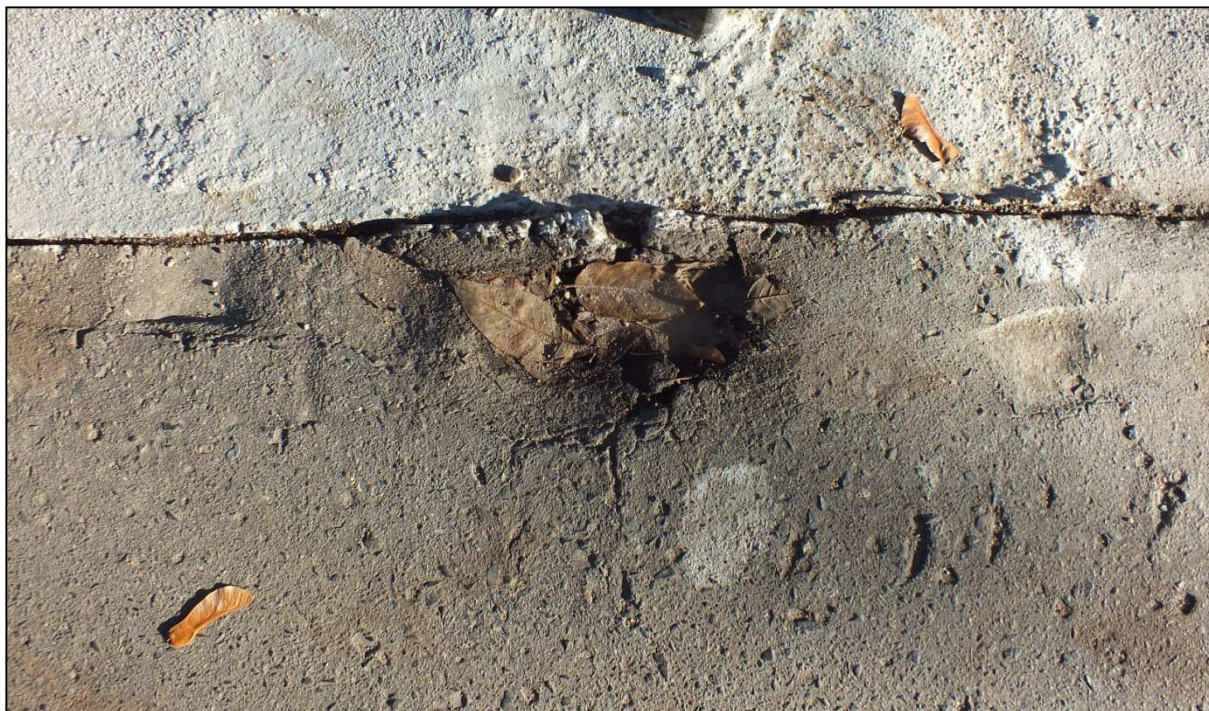
Rys. 5.118 Na zdjęciu powyżej widoczna miejscowa deformacja bitumicznej nawierzchni chodnika w obrębie połączenia z betonowym gzymsem od strony wody górnej
