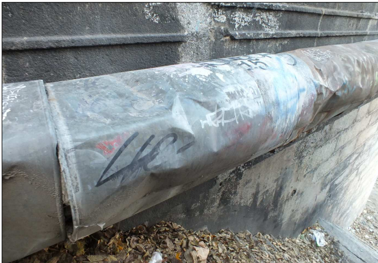
Rys. 5.177 Na zdjęciu powyżej widoczne zanieczyszczenia w postaci graffiti na powierzchni blach osłonowych instalacji obcych od strony wody górnej, widoczne również deformacje na powierzchni blach osłonowych
