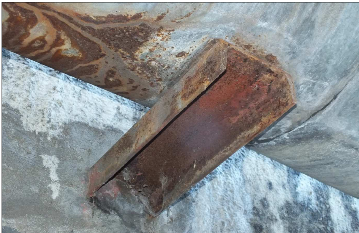
Rys. 5.179 Na zdjęciu powyżej widoczna intensywna korozja powierzchniowa i wżerowa stalowego elementu wspornikowego mocującego instalację obcą do przyczółka od strony ul. Podwale
