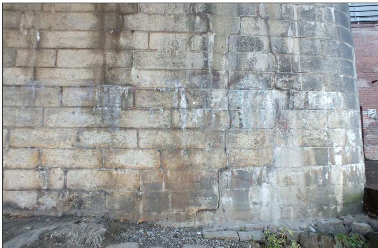
Rys. 5.71 Na zdjęciu powyżej widoczne pionowe spękania ściany czołowej przyczółka od strony ul. Podwale od strony wody dolnej (na zdjęciu dolna część przyczółka)
