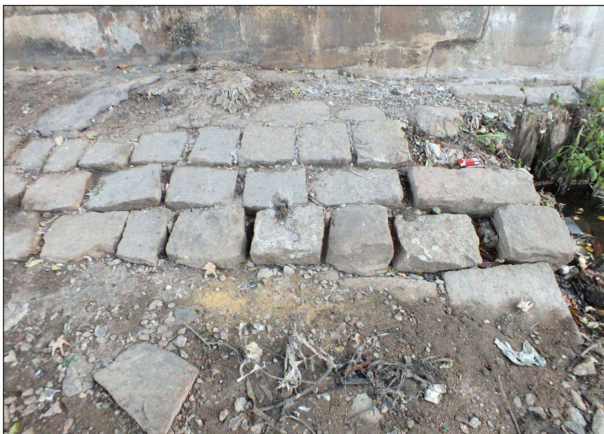
Rys. 5.174 Na zdjęciu powyżej widoczny brak spoinowania oraz przemieszczenia i deformacje elementów kamiennego umocnienia brzegu w obrębie przyczółka od strony ul. Podwale od strony wody dolnej (w obrębie wypadu z kanałów ściekowych)
