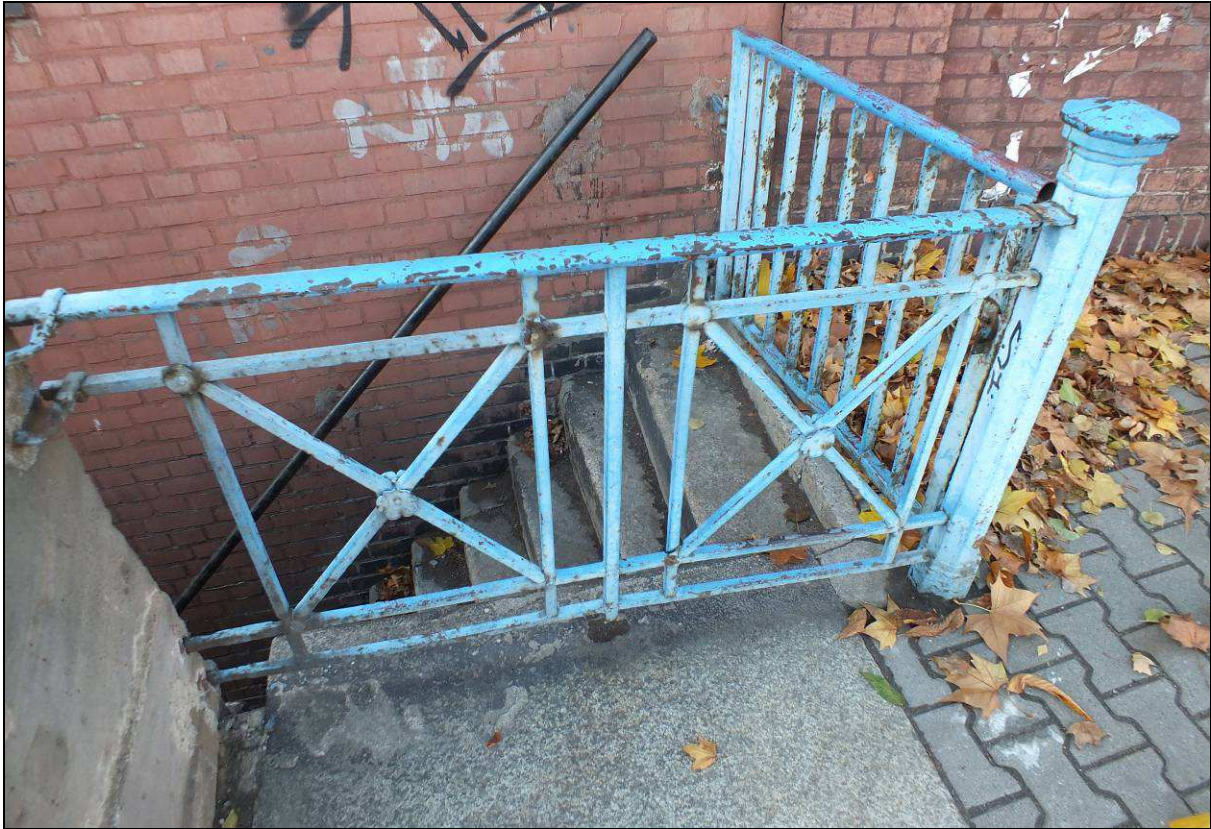
Rys. 5.139 Na zdjęciu powyżej widoczne rozległe uszkodzenia powłoki antykorozyjnej oraz liczne towarzyszące ogniska korozji na powierzchni stalowej balustrady w obrębie schodów skarpowych od strony wody dolnej od strony ul. Mostowej
