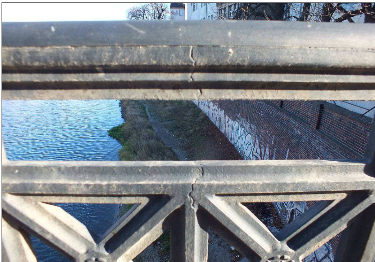
Rys. 5.138 Na zdjęciu powyżej widoczne pionowe pęknięcia elementów stalowej balustrady na obiekcie od strony wody górnej
