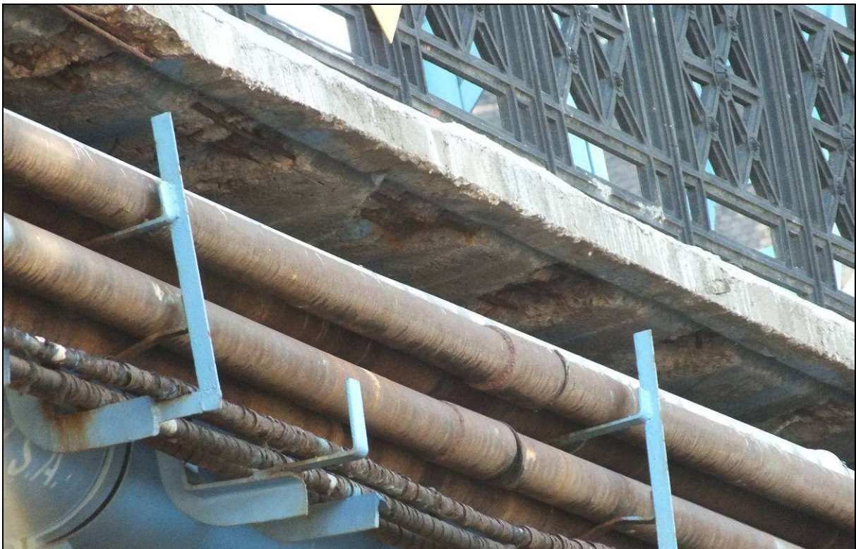
Rys. 5.52 Na zdjęciu powyżej widoczne rozległe ubytki betonu na spodzie płyty chodnikowej wraz z towarzyszącymi odsłoniętymi prętami zbrojeniowymi w dwóch warstwach, widoczne jest zniszczenie struktury materiału
