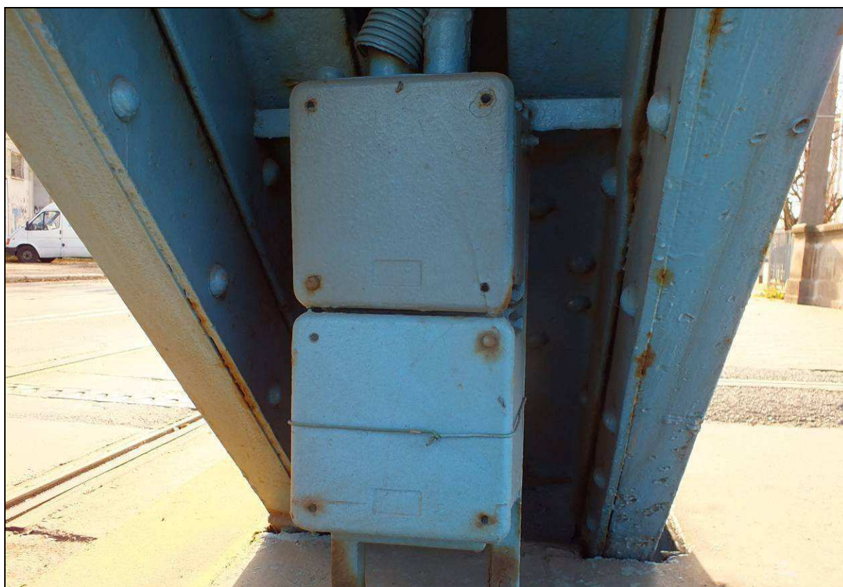
Rys. 5.162 Na zdjęciu powyżej widoczne ogniska korozji na powierzchni stalowych skrzynek rozdzielczych instalacji oświetleniowej na obiekcie
