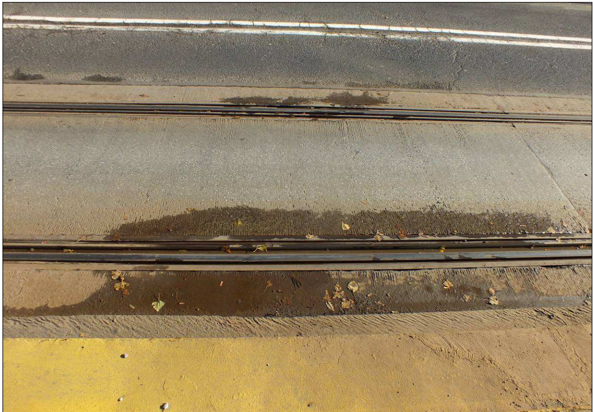
Rys. 5.100 Na zdjęciu powyżej widoczne zastoiska wód opadowych na powierzchni betonowych płyt torowiska tramwajowego
