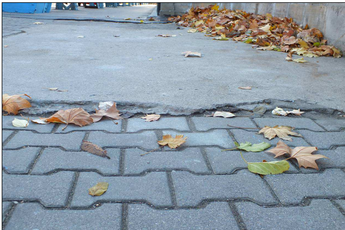
Rys. 5.12 Na zdjęciu powyżej widoczny uskok w obrębie nawierzchni na dojściu do obiektu od strony ul. Mostowej od strony wody dolnej
