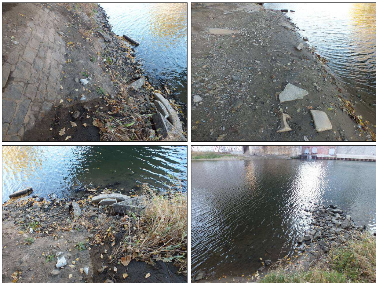
Rys. 5.171 Na zdjęciach powyżej widoczne liczne przykłady zanieczyszczeń terenu pod obiektem gruzem budowlanym i elementami zniszczonego umocnienia brzegowego, zanieczyszczenia występują głównie w obrębie podpór
