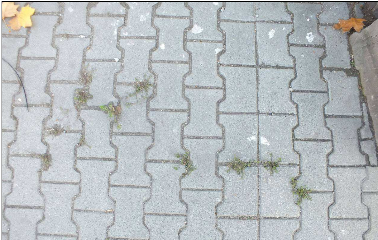
Rys. 5.10 Na zdjęciu powyżej widoczne zanieczyszczenia oraz towarzysząca wegetacja roślinności w spoinowaniu nawierzchni z betonowej kostki na dojściu do obiektu
