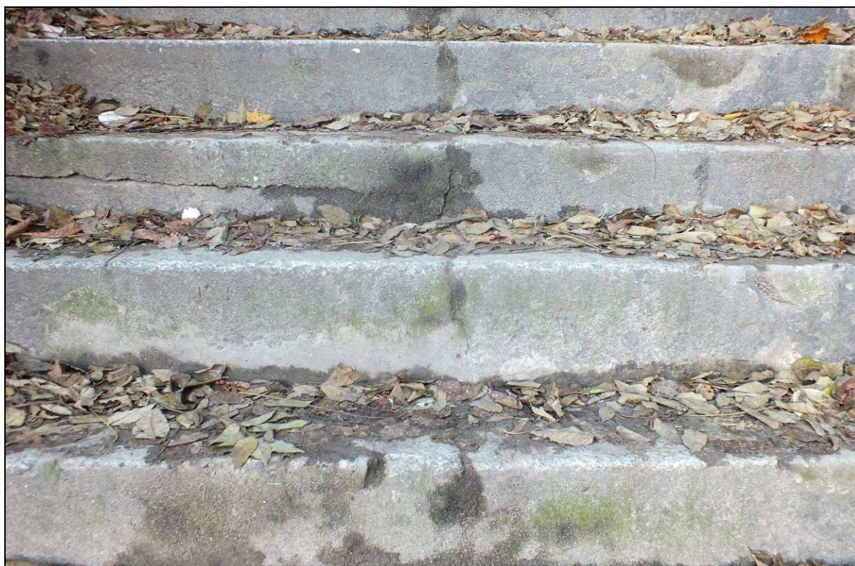
Rys. 5.169 Na zdjęciu powyżej widoczne rozległe zanieczyszczenia materiałem ziemnym i biologicznym na powierzchni oraz spękania i zawilgocenia w obrębie spękań kamiennych stopni
