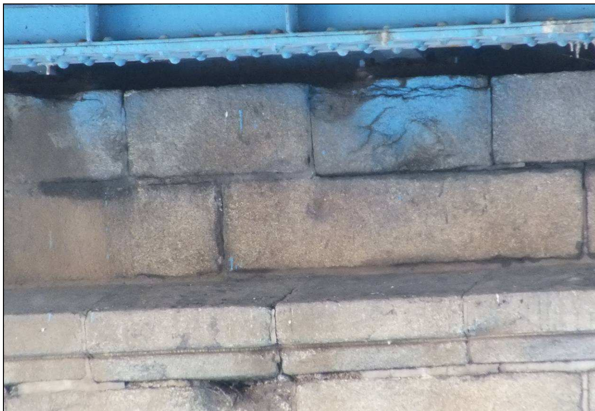
Rys. 5.64 Na zdjęciu powyżej widoczne zanieczyszczenia materiałem ziemnym, ubytki w spoinowaniu, spękania i wykruszenia na powierzchni kamiennych elementów oraz zawilgocenia w obrębie niszy podłożyskowej i ścianki zapleczonej przyczółka
