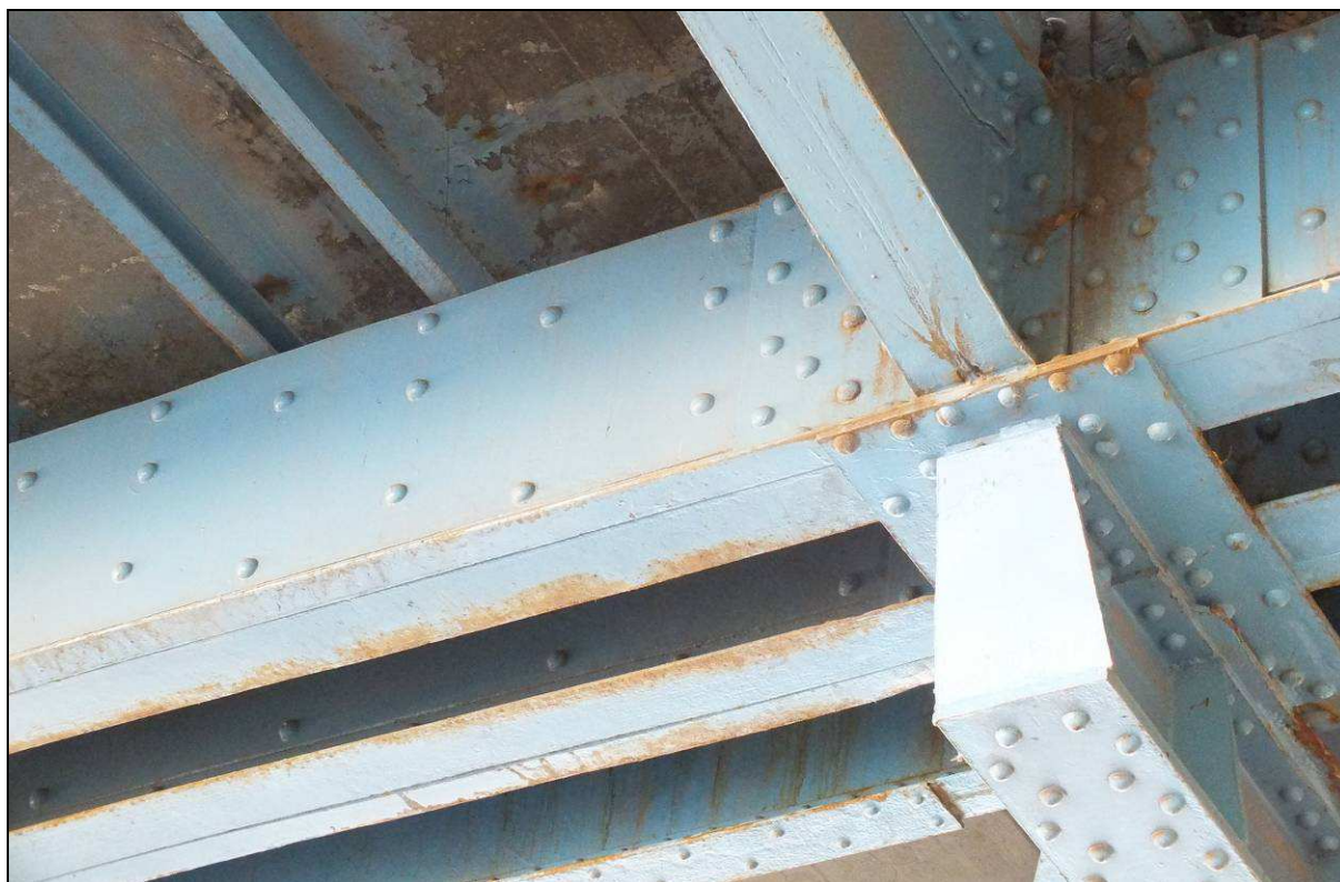
Rys. 5.30 Na zdjęciu powyżej widoczne liczne rozległe ogniska korozji powierzchniowej w obrębie pasa dolnego, podłużnicy i poprzecznicy
