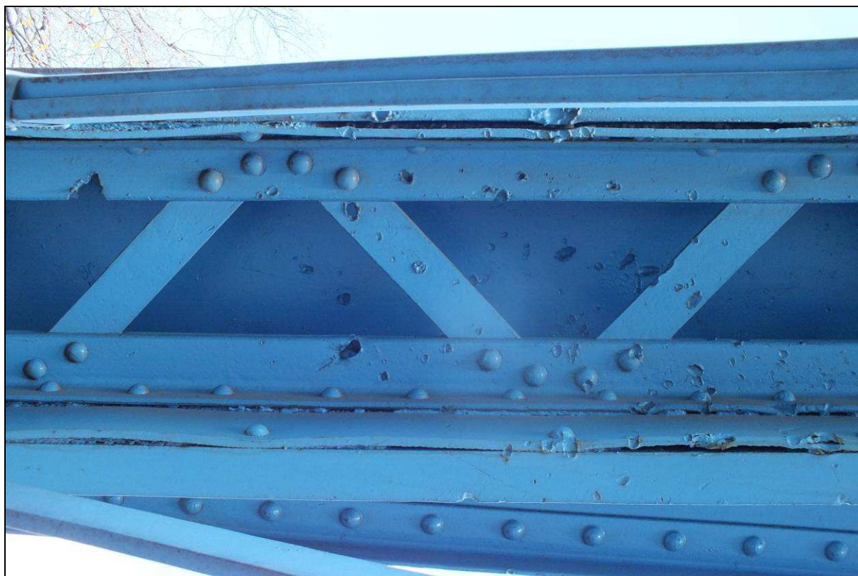
Rys. 5.20 Na zdjęciu powyżej widoczne miejscowe uszkodzenia górnego pasa dźwigara kratownicowego od strony wody dolnej w postaci przestrzelin z czasów wojny
