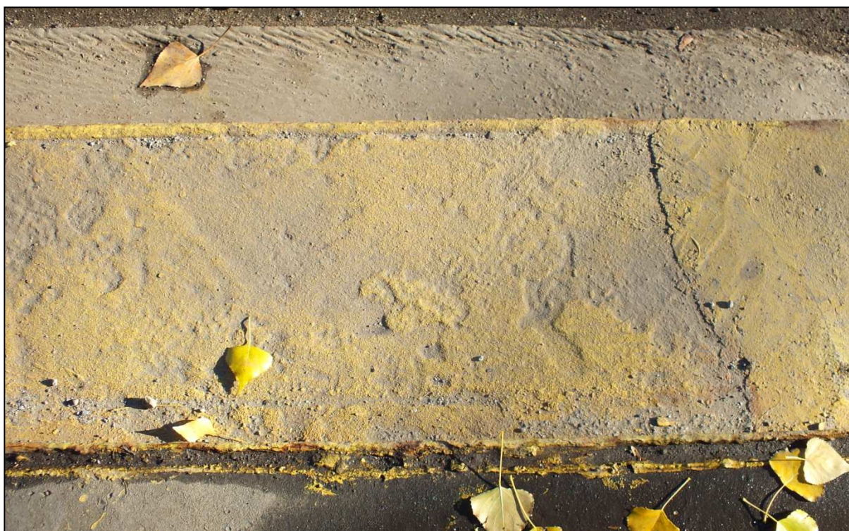
Rys. 5.123 Na zdjęciu powyżej widoczne rozległe wykruszenia na górnej powierzchni betonu krawężnika na obiekcie, widoczne również zanieczyszczenia materiałem ziemnym w szczelinie pomiędzy betonem krawężnika a bitumiczną nawierzchnią chodnika
