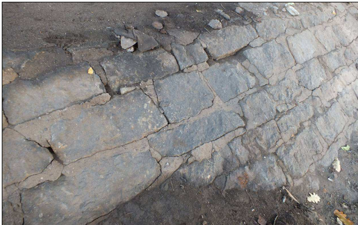
Rys. 5.173 Na zdjęciu powyżej widoczne spękania, wykruszenia i ubytki spoinowania kamiennego umocnienia brzegu w obrębie podpory pośredniej
