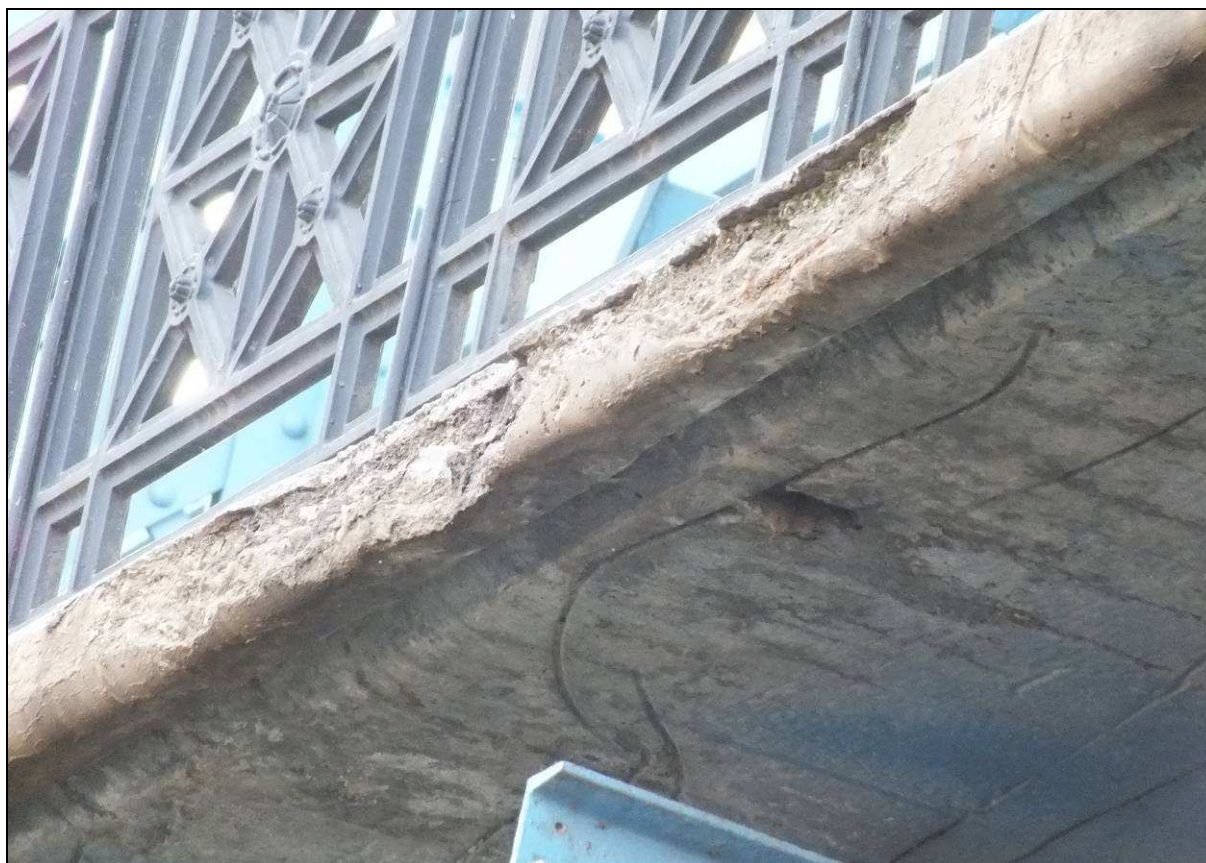
Rys. 5.47 Na zdjęciu powyżej widoczne rozległe ubytki betonu na powierzchni gzymsu od strony wody górnej wraz z towarzyszącymi odsłoniętymi korodującymi prętami zbrojeniowymi
