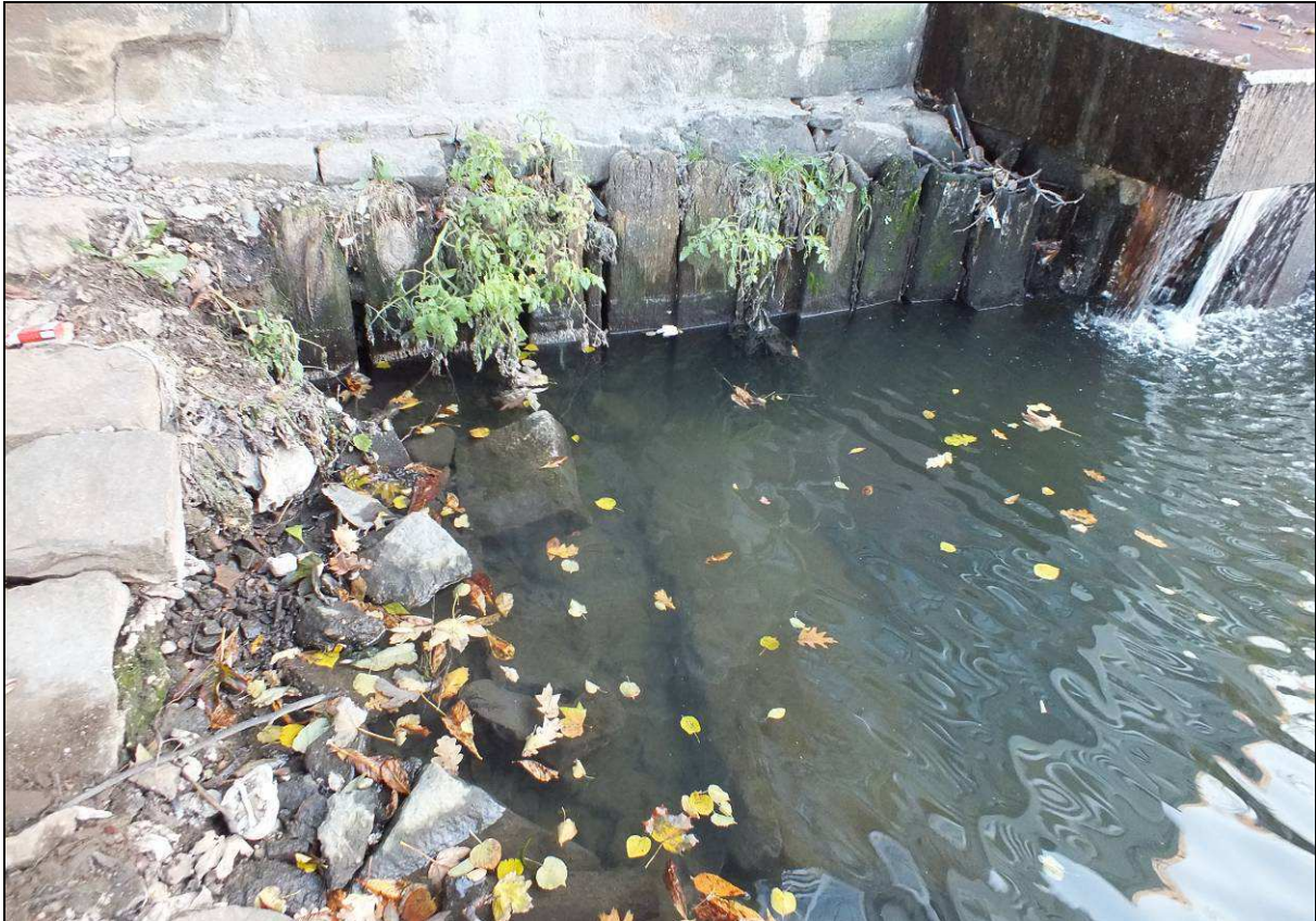
Rys. 5.175 Na zdjęciu powyżej widoczny rozległy ubytek umocnienia fundamentów przyczółka i kamiennego umocnienia brzegu rzeki od strony ul. Podwale od strony wody dolnej (w obrębie wypadu z kanałów ściekowych)
