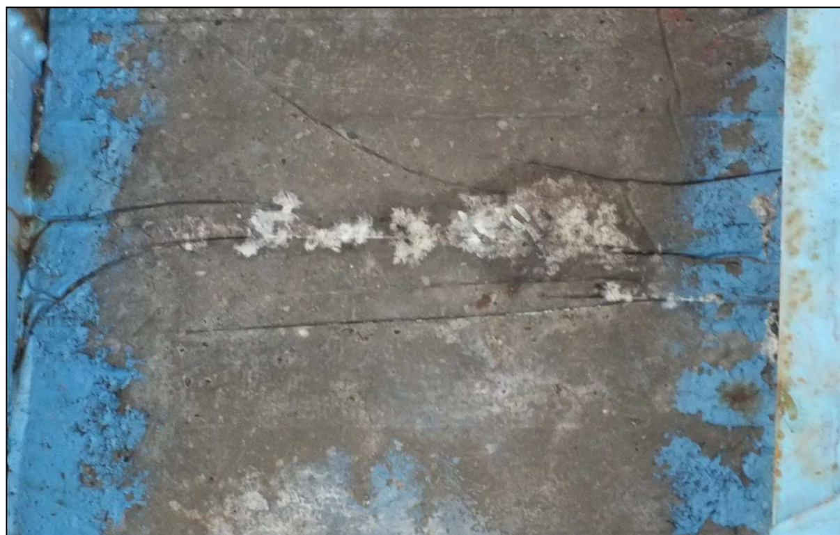
Rys. 5.36 Na zdjęciu powyżej widoczne miejscowe zawilgocenie oraz towarzyszące wykwyty i wyługowania wapienne na powierzchni żelbetowej płyty pomostowej pod jezdnią
