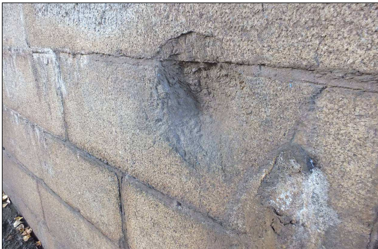
Rys. 5.91 Na zdjęciu powyżej widoczne głębokie ubytki materiału na powierzchni kamiennej okładziny filara, uszkodzenia prawdopodobnie pochodzą z czasów wojny
