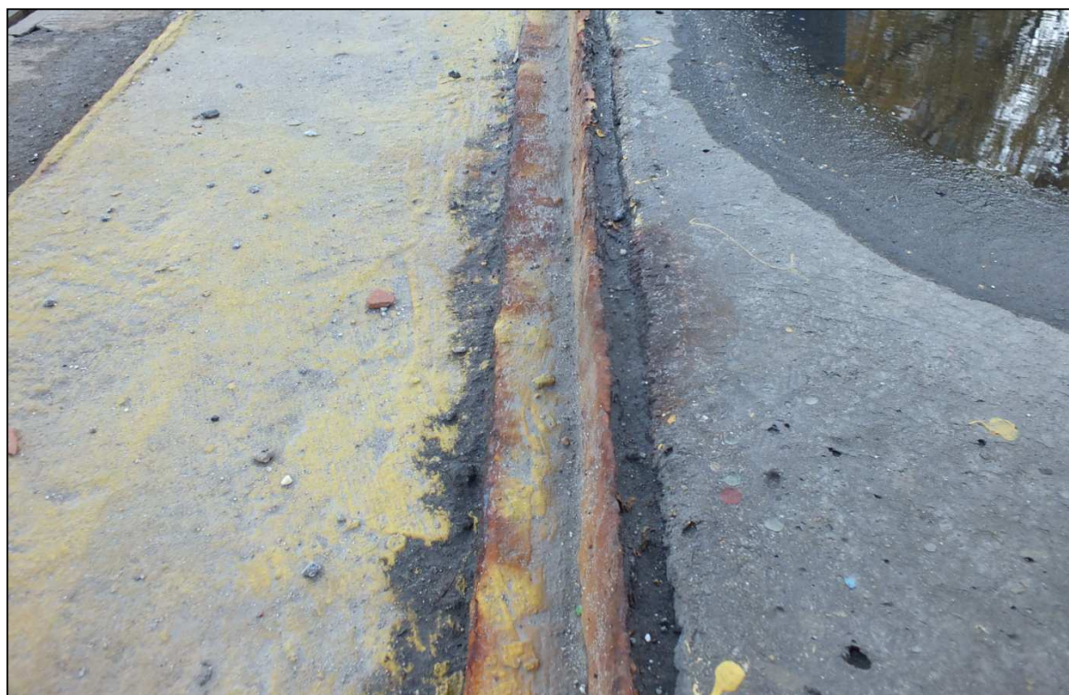
Rys. 5.125 Na zdjęciu powyżej widoczne uszkodzenia powłok ochronnych oraz rozległa korozja powierzchniowa stalowego okucia ograniczającego bitumiczną nawierzchnię chodnika na obiekcie od krawężnika, widoczne również zanieczyszczenia materiałem ziemnym szczeliny pomiędzy okuciem a nawierzchnią
