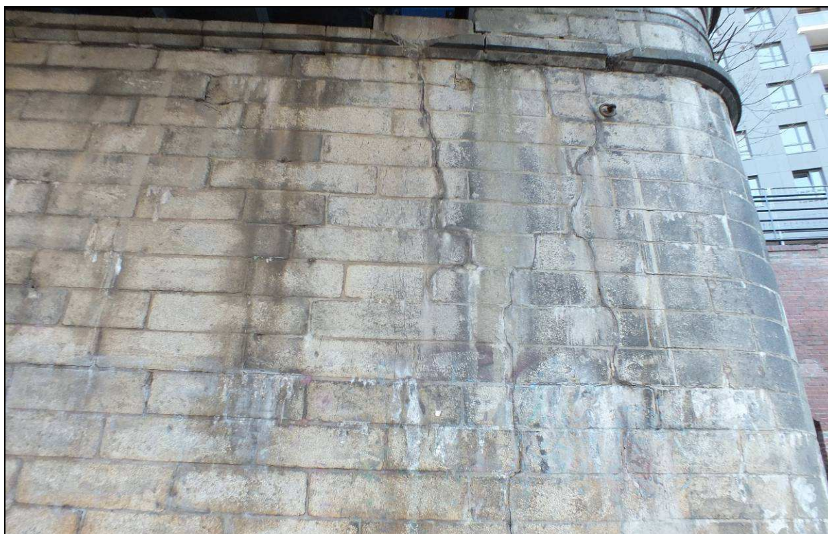
Rys. 5.70 Na zdjęciu powyżej widoczne pionowe spękania ściany czołowej przyczółka od strony ul. Podwale od strony wody dolnej (na zdjęciu górna część przyczółka)
