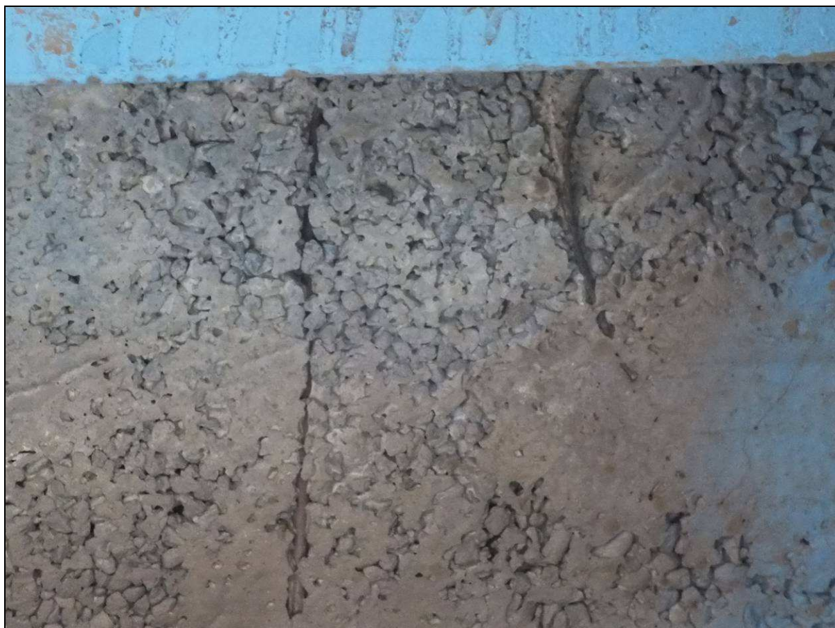
Rys. 5.58 Na zdjęciu powyżej widoczne odsłonięte pręty zbrojeniowe w wyniku braku odpowiedniej otuliny, widoczny jest również brak odpowiedniego zagęszczenia i rozsegregowanie mieszanki betonowej
