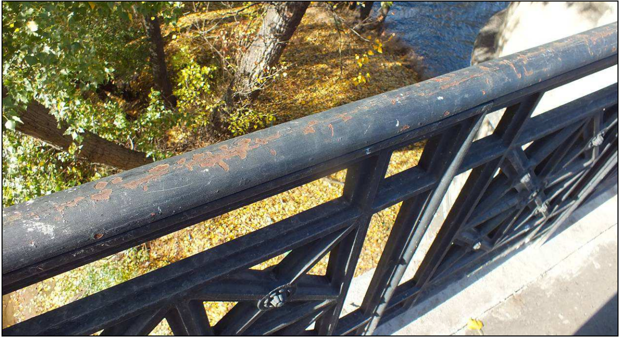
Rys. 5.131 Na zdjęciu powyżej widoczna rozległa destrukcja powłoki antykorozyjnej oraz liczne towarzyszące ogniska korozji na górnej powierzchni stalowego pochwytu balustrady na obiekcie od strony wody dolnej
