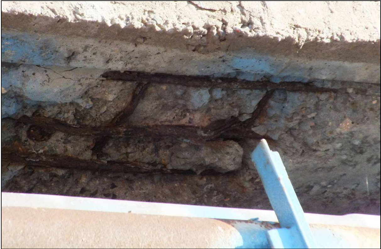
Rys. 5.51 Na zdjęciu powyżej widoczne rozległe ubytki betonu na spodzie płyty chodnikowej wraz z towarzyszącymi odsłoniętymi prętami zbrojeniowymi w dwóch warstwach, widoczne jest zniszczenie struktury materiału oraz ubytki przekrojów prętów zbrojeniowych w wyniku korozji
