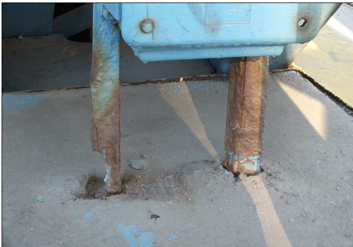
Rys. 5.163 Na zdjęciu powyżej widoczna intensywna korozja wżerowa wraz z towarzyszącymi ubytkami przekrojów stalowych „nózek” skrzynek rozdzielczych instalacji oświetleniowej na obiekcie
