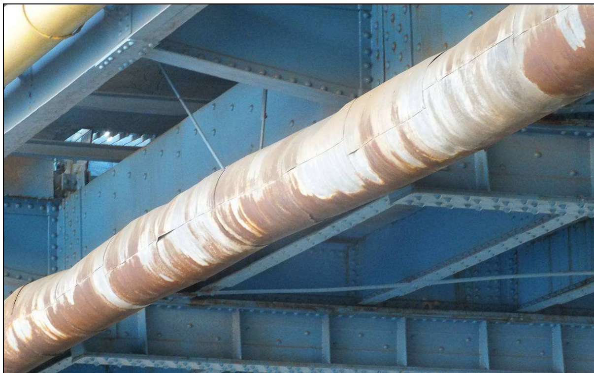
Rys. 5.178 Na zdjęciu powyżej widoczna rozległa korozja powierzchniowa i miejscowa korozja wżerowa na powierzchni blach osłonowych instalacji obcej pod obiektem od strony wody górnej
