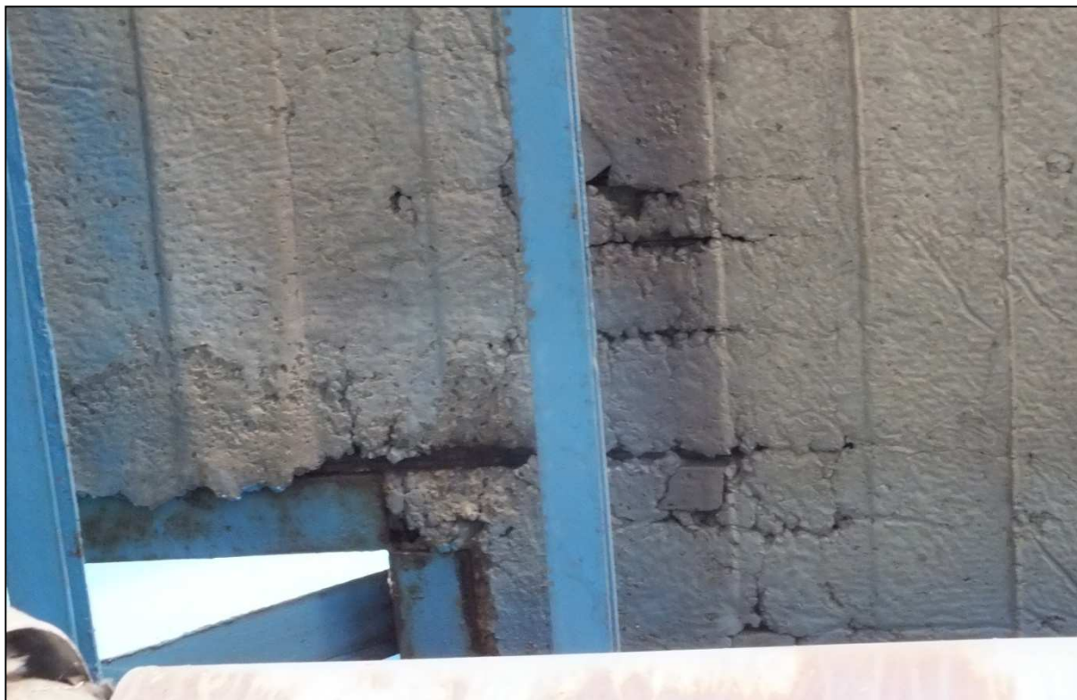
Rys. 5.49 Na zdjęciu powyżej widoczne odsłonięte korodujące pręty zbrojeniowe na spodzie płyty chodnikowej, prawdopodobną przyczyną jest zbyt mała otulina i błędy wykonawcze
