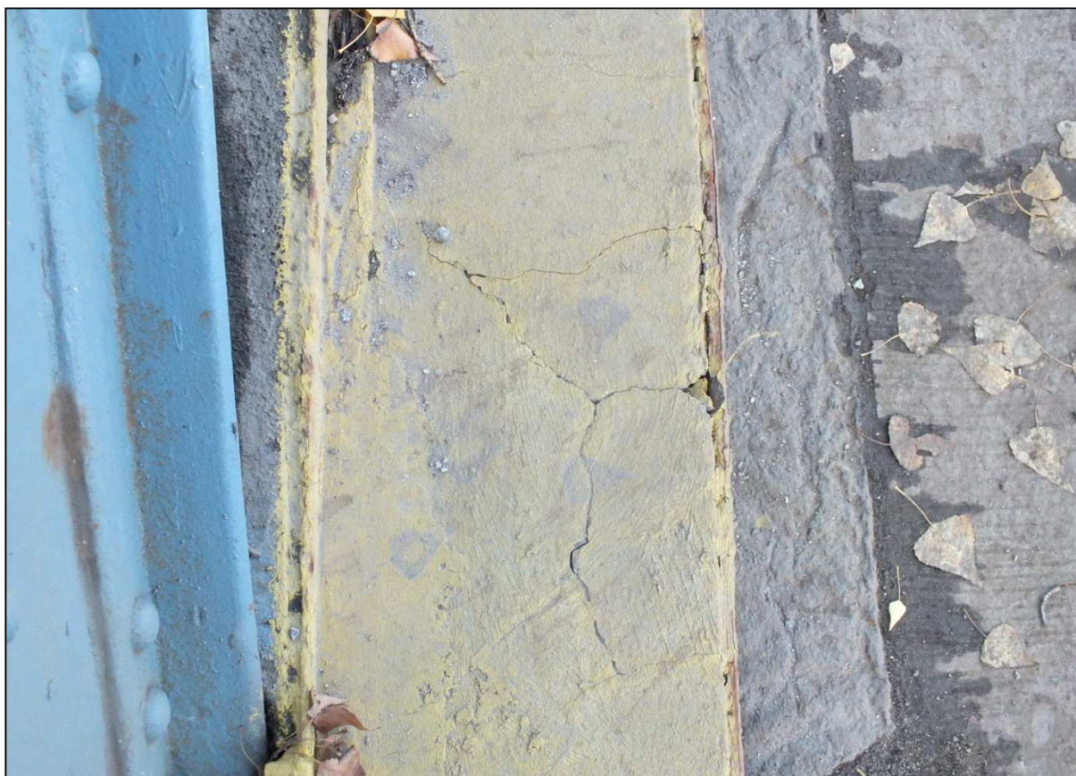
Rys. 5.122 Na zdjęciu powyżej widoczne spękania i wykruszenia na górnej powierzchni betonu krawężnika na obiekcie
