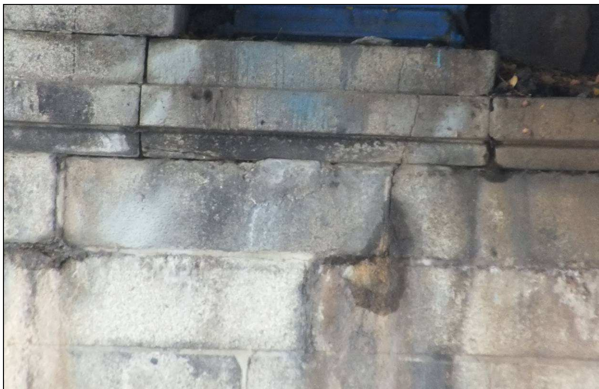
Rys. 5.93 Na zdjęciu powyżej widoczne ubytki spoinowania kamiennych elementów, liczne wapienne wyługowania i zawilgocenia w obrębie spoinowania oraz pionowe pęknięcie ciosu podłożyskowego od strony ul. Mostowej od strony wody górnej
