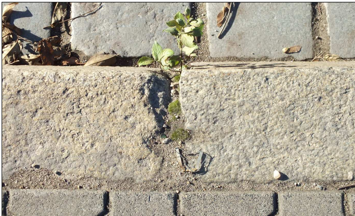
Rys. 5.129 Na zdjęciu powyżej widoczny brak spoinowania pomiędzy segmentami kamiennego krawężnika na dojeździe oraz towarzyszące zanieczyszczenia i wegetacja roślinności w obrębie spoinowania, widoczne również wykruszenia materiału kamiennego krawężnika głównie w obrębie naroży i przerwy pomiędzy poszczególnymi segmentami
