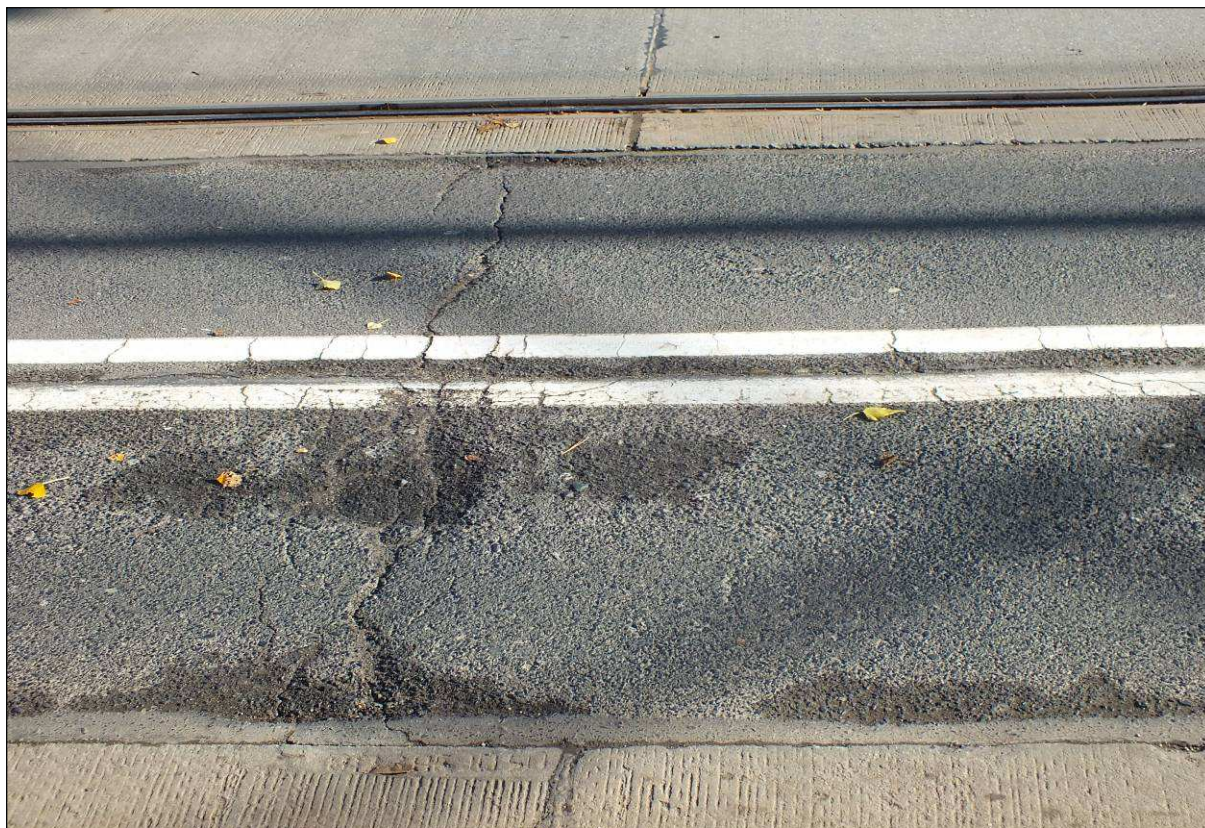
Rys. 5.110 Na zdjęciu powyżej widoczne poprzeczne pęknięcie oraz drobniejsze zarysowania i powierzchniowe wykruszenia bitumicznej nawierzchni jezdni pomiędzy torowiskami tramwajowymi na obiekcie
