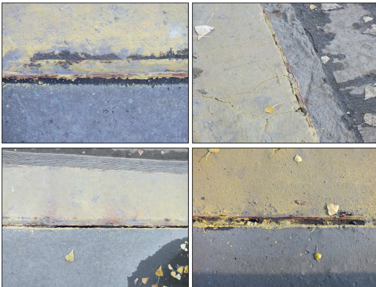
Rys. 5.127 Na zdjęciach powyżej widoczne liczne przykłady korozji powierzchniowej stalowych okuc ograniczających bitumiczną nawierzchnię na obiekcie od krawężników oraz zanieczyszczenia materiałem ziemnym szczelin pomiędzy okuciem a nawierzchnią
