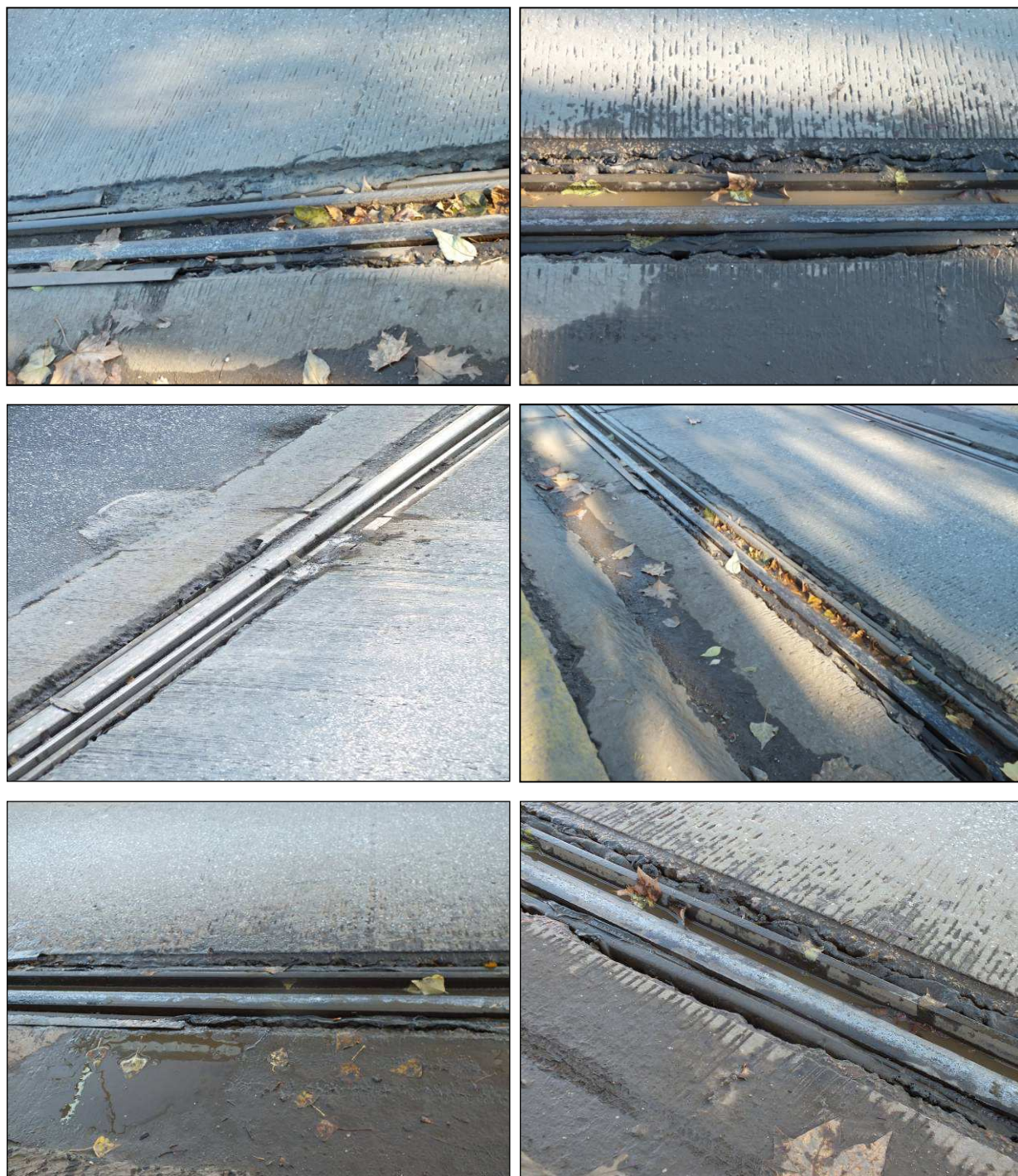
Rys. 5.106 Na zdjęciach powyżej widoczne liczne przykłady ubytków stalowych okuć wnek w betonowych płytach na szyny jezdne torowiska tramwajowego
