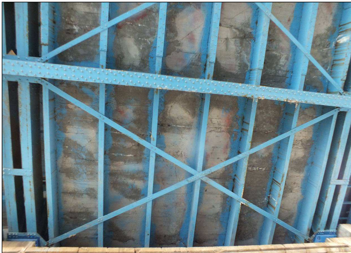
Rys. 5.35 Na zdjęciu powyżej widoczne rozległe zawilgocenia oraz wapienne wyługowania i zacieki na spodzie żelbetowej płyty pomostowej pod jezdnią, uszkodzenia świadczą o nieszczelnej izolacji
