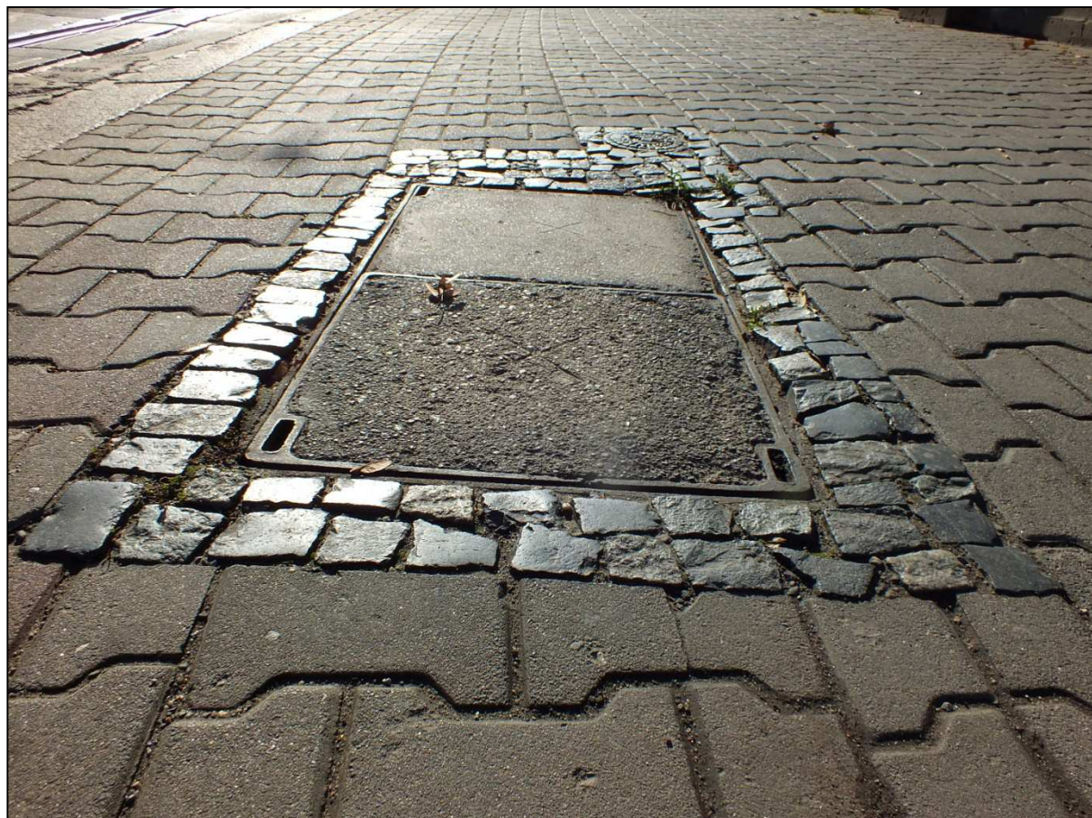
Rys. 5.11 Na zdjęciu powyżej widoczne przemieszczenie w obrębie betonowego wjazdu studzienki rewizyjnej na dojściu do obiektu od strony ul. Podwale
