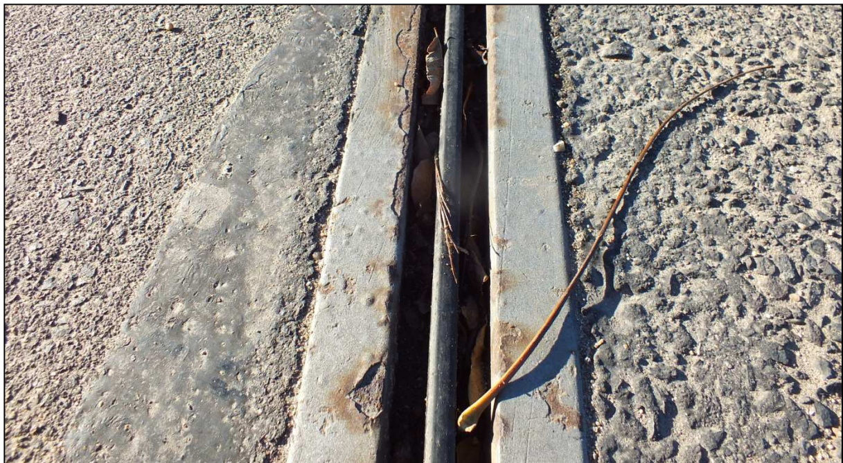
Rys. 5.156 Na zdjęciu powyżej widoczne rozległe uszkodzenia powłok antykorozyjnych oraz towarzyszące ogniska korozji powierzchniowej i wżerowej w obrębie stalowych elementów modułowego urządzenia dylatacyjnego w ciągu chodnika na obiekcie
