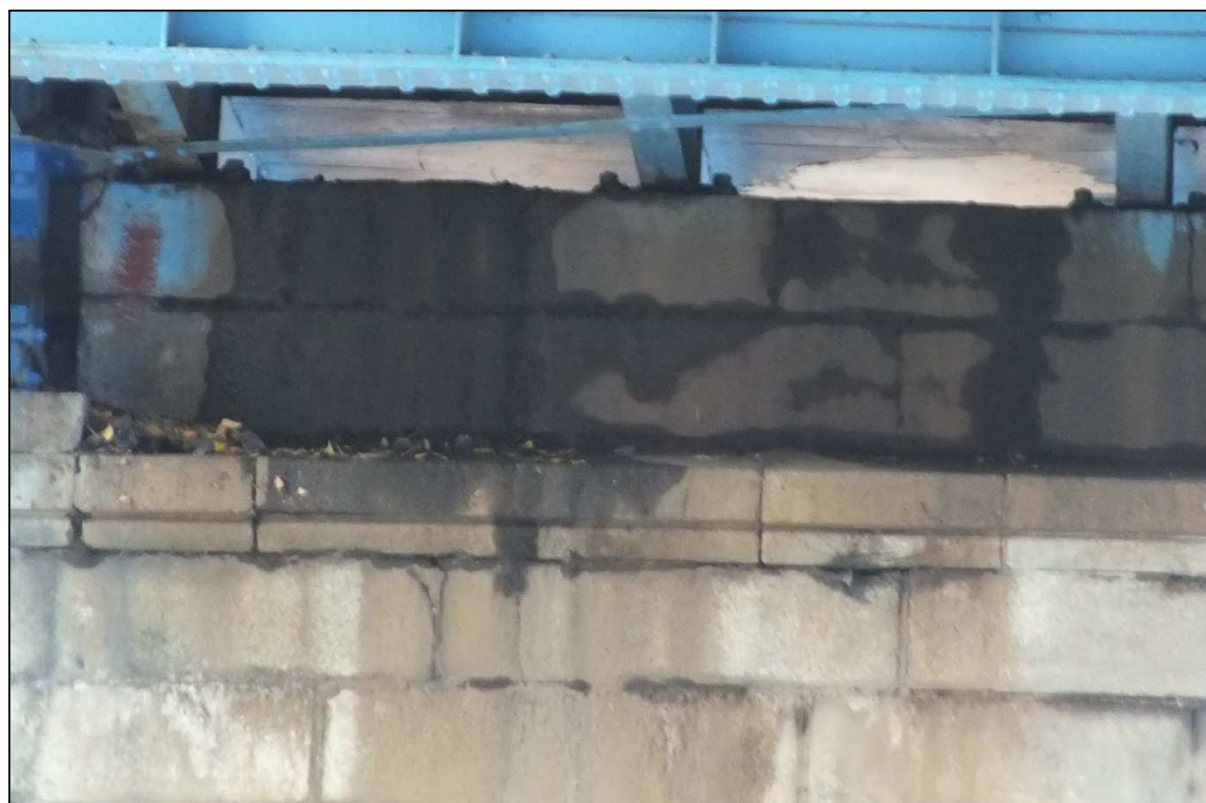
Rys. 5.94 Na zdjęciu powyżej widoczne zanieczyszczenia materiałem ziemnym i organicznym, ubytki w spoinowaniu, spękania i wykruszenia na powierzchni kamiennych elementów oraz zawilgocenia w obrębie niszy podłożyskowej filara
