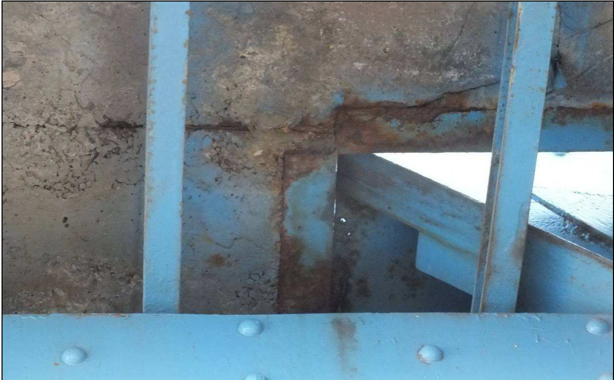
Rys. 5.56 Na zdjęciu powyżej widoczne miejscowo odsłonięte, korodujące pręty zbrojeniowe, widoczny jest brak odpowiedniej otuliny i brak odpowiedniego zagęszczenia mieszanki betonowej na etapie budowy, widoczne są również korodujące elementy stalowe okucia
