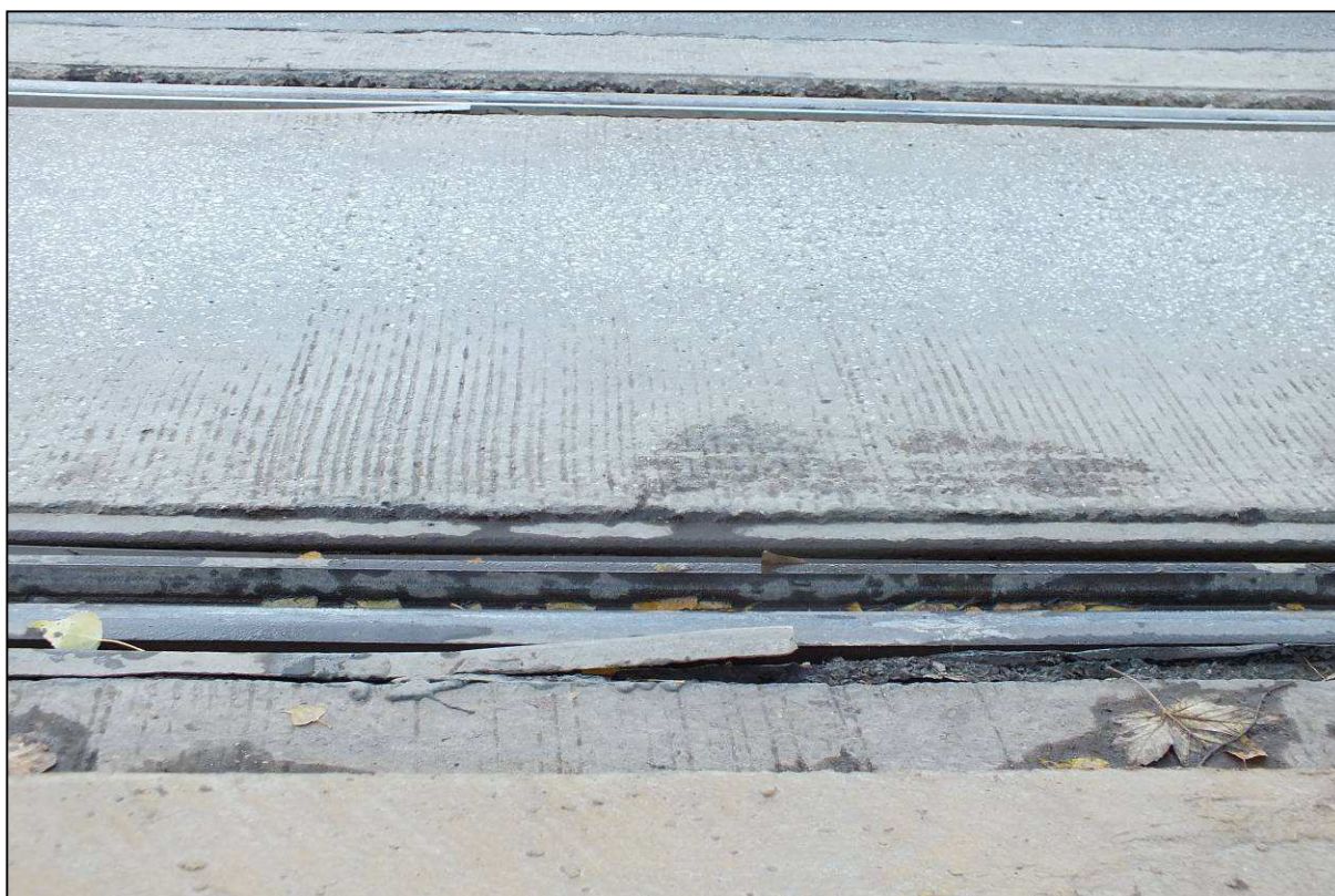
Rys. 5.105 Na zdjęciu powyżej widoczna deformacja oraz ubytki stalowego okucia wewnątrz w betonowych płytach na szynę jezdnią torowiska tramwajowego
