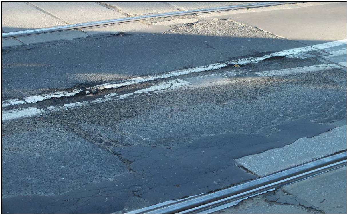
Rys. 5.8 Na zdjęciu powyżej widoczne powierzchniowe wykruszenia oraz miejscowe ubytki bitumicznej nawierzchni jezdni pomiędzy torowiskami tramwajowymi na dojeździe do obiektu
