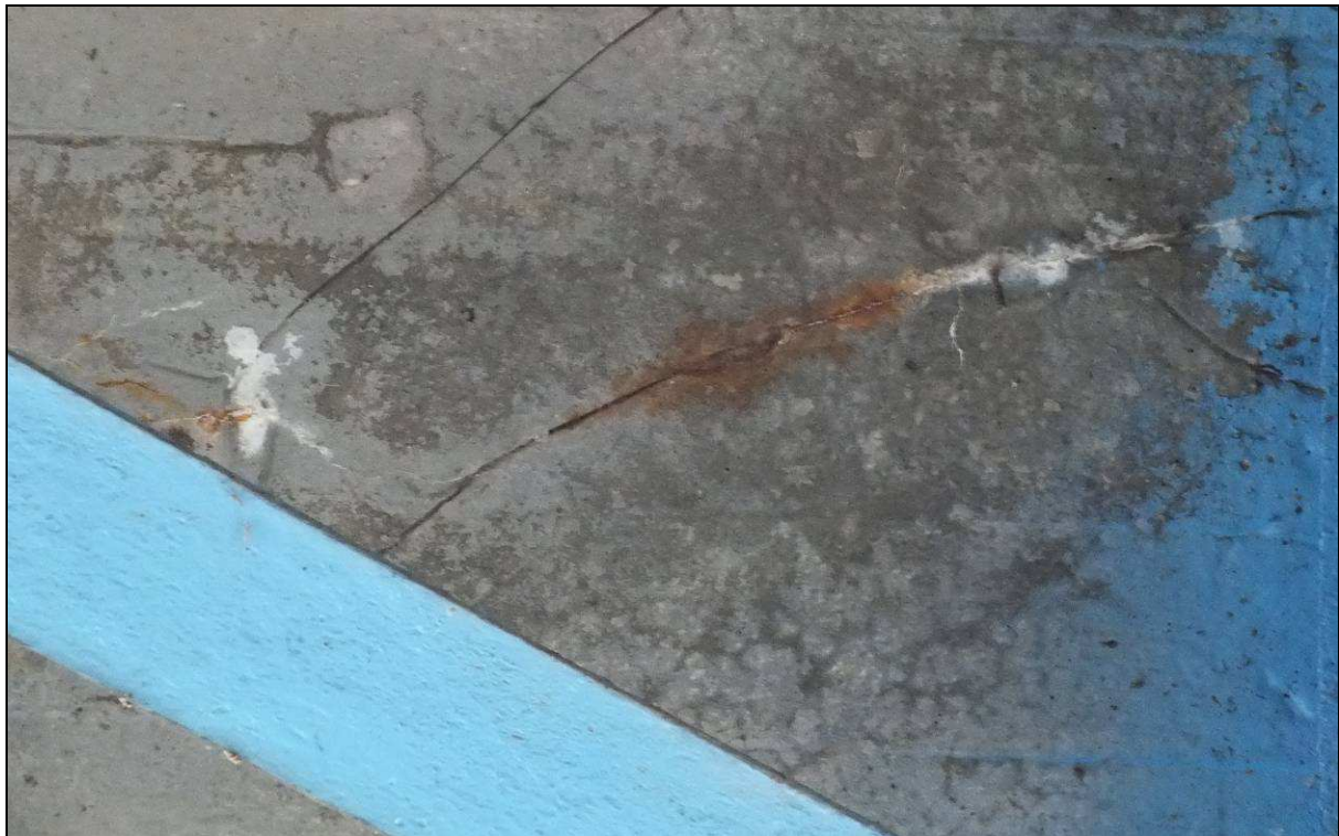
Rys. 5.37 Na zdjęciu powyżej widoczne miejscowe korozyjne wykwyty na powierzchni żelbetowej płyty pomostowej pod jezdnią świadczące o postępującej korozji zbrojenia
