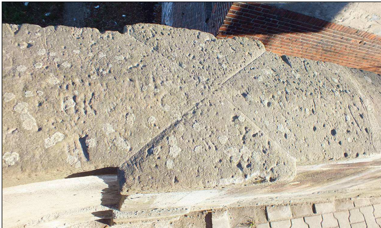
Rys. 5.143 Na zdjęciu powyżej widoczne liczne powierzchniowe wykruszenia materiału oraz rozległe zanieczyszczenia zielonymi nalotami organicznymi na górnej powierzchni kamiennych elementów zwieńczających balustradę w obrębie przyczółka od strony wody górnej od strony ul. Podwale
