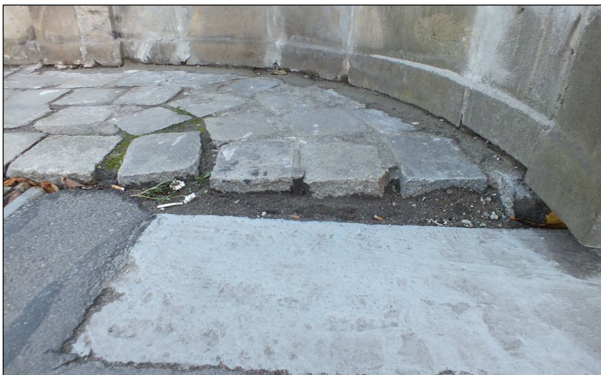
Rys. 5.121 Na zdjęciu powyżej widoczny uskok pomiędzy kamienną nawierzchnią galerii widokowej nad podporą oraz betonowym gzymsem
