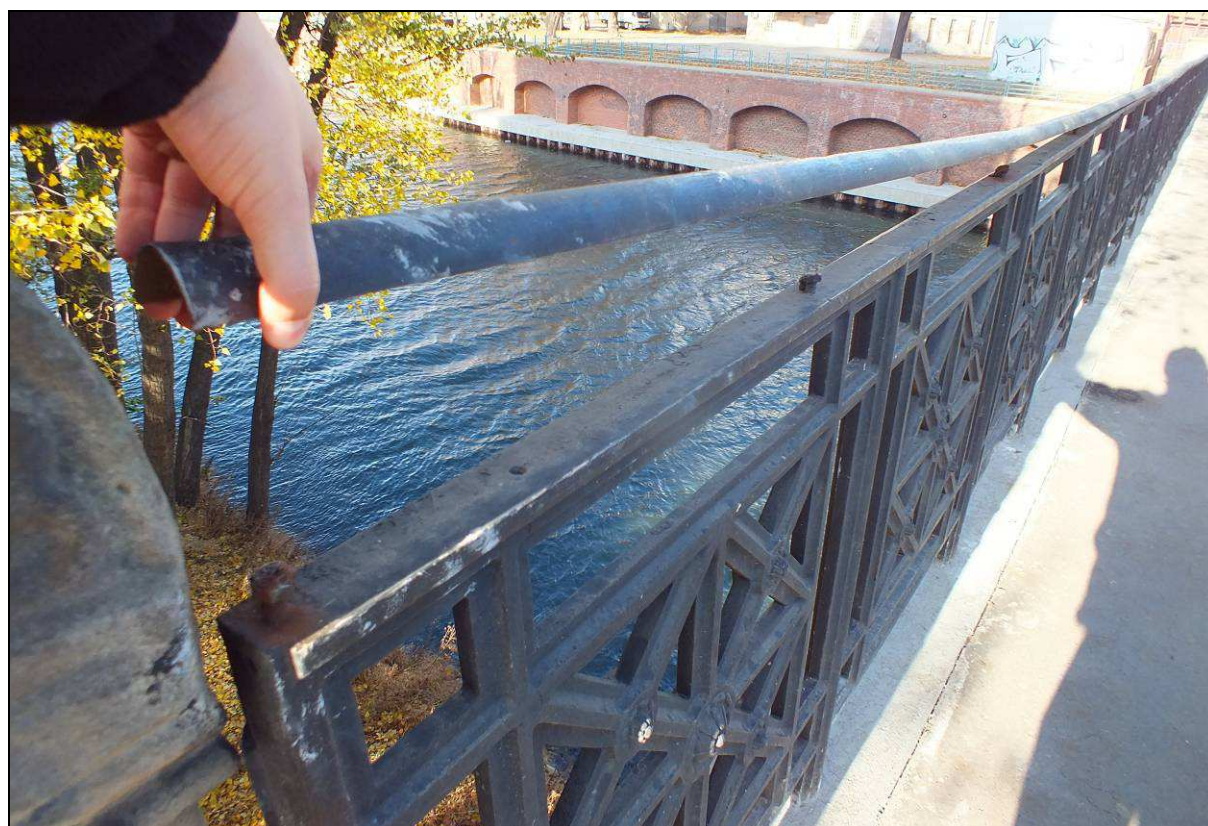
Rys. 5.136 Na zdjęciu powyżej widoczny brak zamocowania pochwytu w wyniku uszkodzenia łączników stalowej balustrady na obiekcie od strony wody dolnej w obrębie podpory pośredniej
