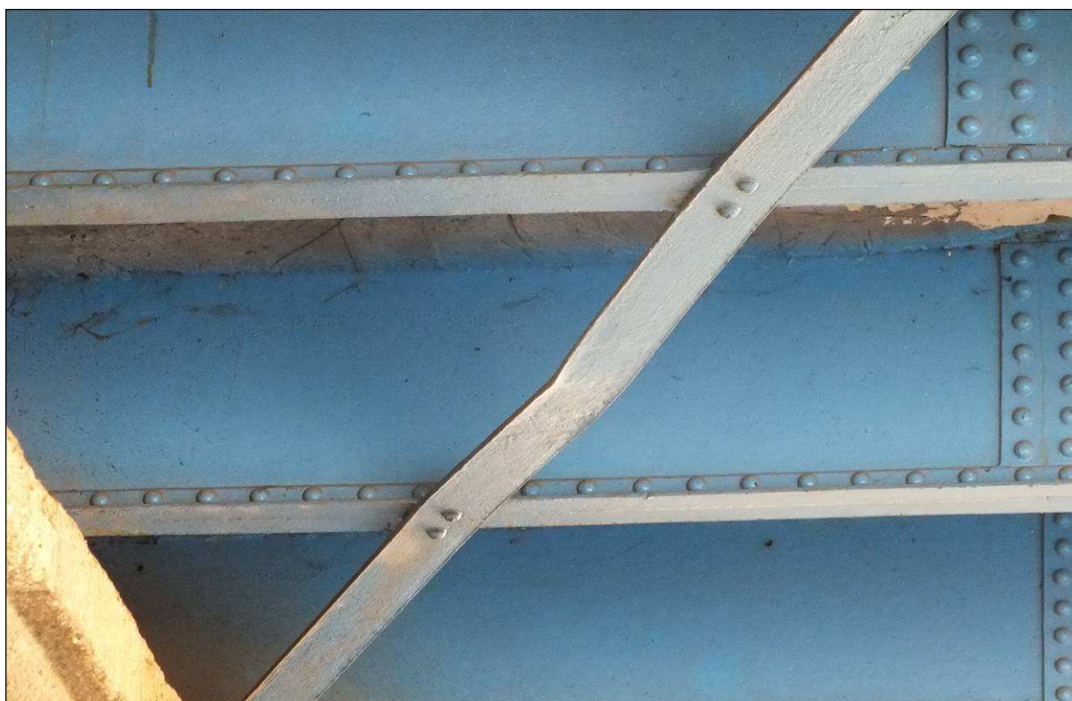
Rys. 5.33 Na zdjęciu powyżej widoczna lokalna deformacja stalowego stężenia przeciwwiatrowego
