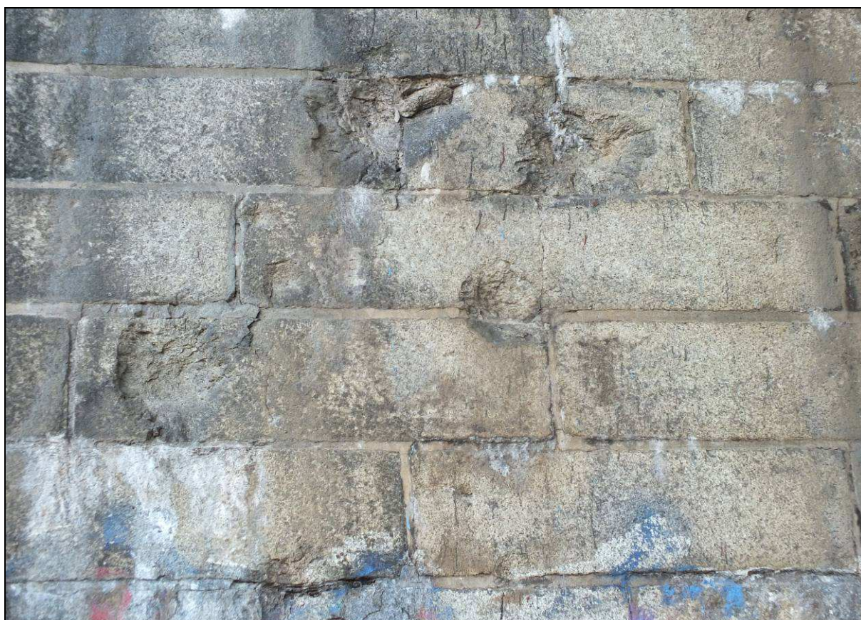
Rys. 5.68 Na zdjęciu powyżej widoczne liczne wykruszenia i powierzchniowe ubytki materiału kamiennej okładziny ściany czołowej przyczółka od strony ul. Podwale, uszkodzenia prawdopodobnie pochodzą z czasów wojny
