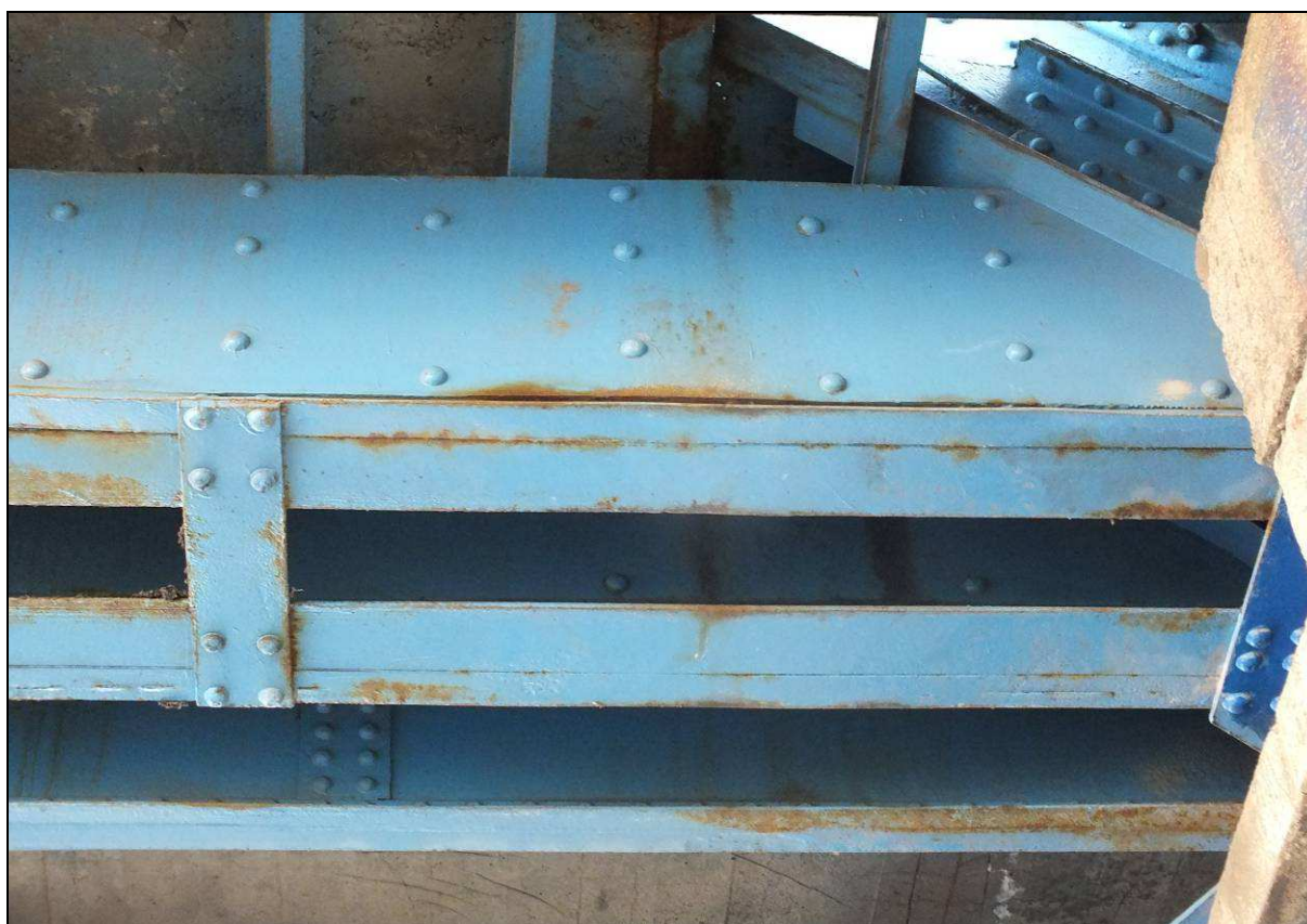
Rys. 5.31 Na zdjęciu powyżej widoczne liczne rozległe ogniska korozji powierzchniowej w obrębie pasa dolnego, podłużnicy i poprzecznicy
