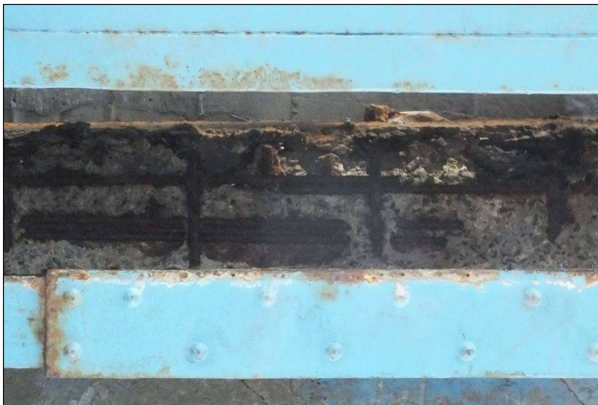
Rys. 5.45 Na zdjęciu powyżej widoczne zniszczenie struktury materiału wzdłuż krawędzi żelbetowej płyty pomostowej pod jezdnią
