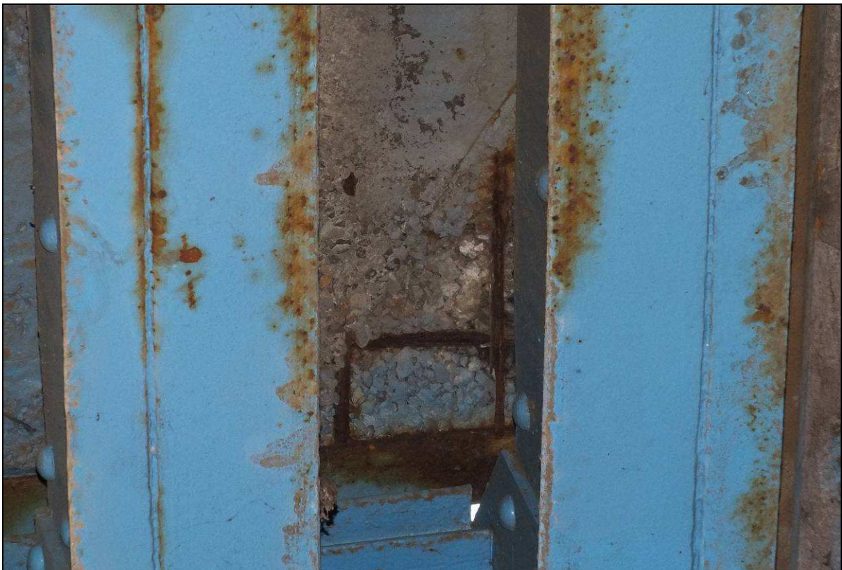
Rys. 5.57 Na zdjęciu powyżej widoczne miejscowo odsłonięte, korodujące pręty zbrojeniowe, widoczny jest brak odpowiedniej otuliny i brak odpowiedniego zagęszczenia mieszanki betonowej na etapie wykonawstwa, widoczna jest również korozja na powierzchni pasów dolnych dźwigarów kratownicowych
