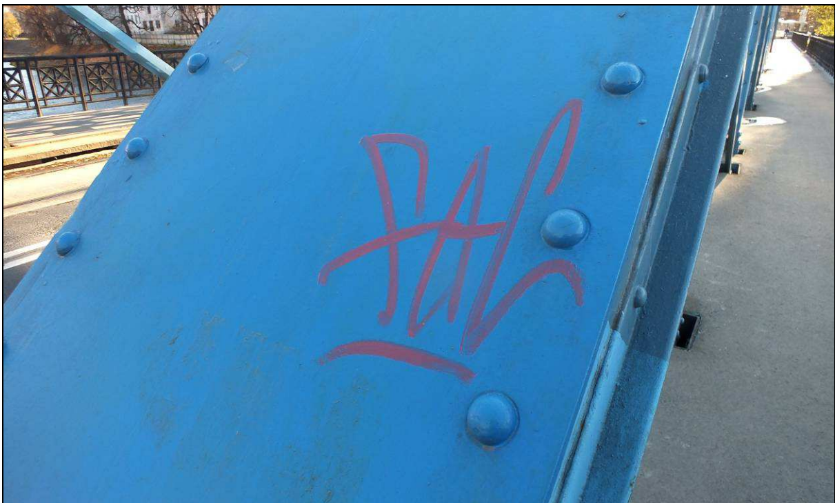
Rys. 5.14 Na zdjęciu powyżej widoczne miejscowe zanieczyszczenia w postaci graffiti na powierzchni pasa górnego dźwigara kratownicowego na wysokości wzroku w miejscu dostępnym z poziomu chodnika
