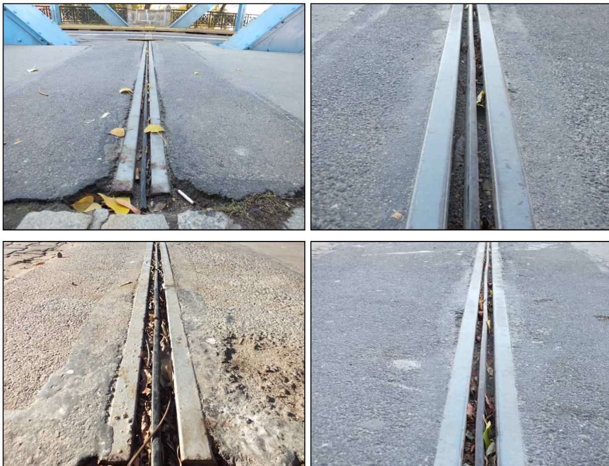
Rys. 5.153 Na zdjęciach powyżej widoczne liczne przykłady zanieczyszczeń materiałem ziemnym i biologicznym w obrębie modułowych urządzeń dylatacyjnych w ciągu chodników na obiekcie
