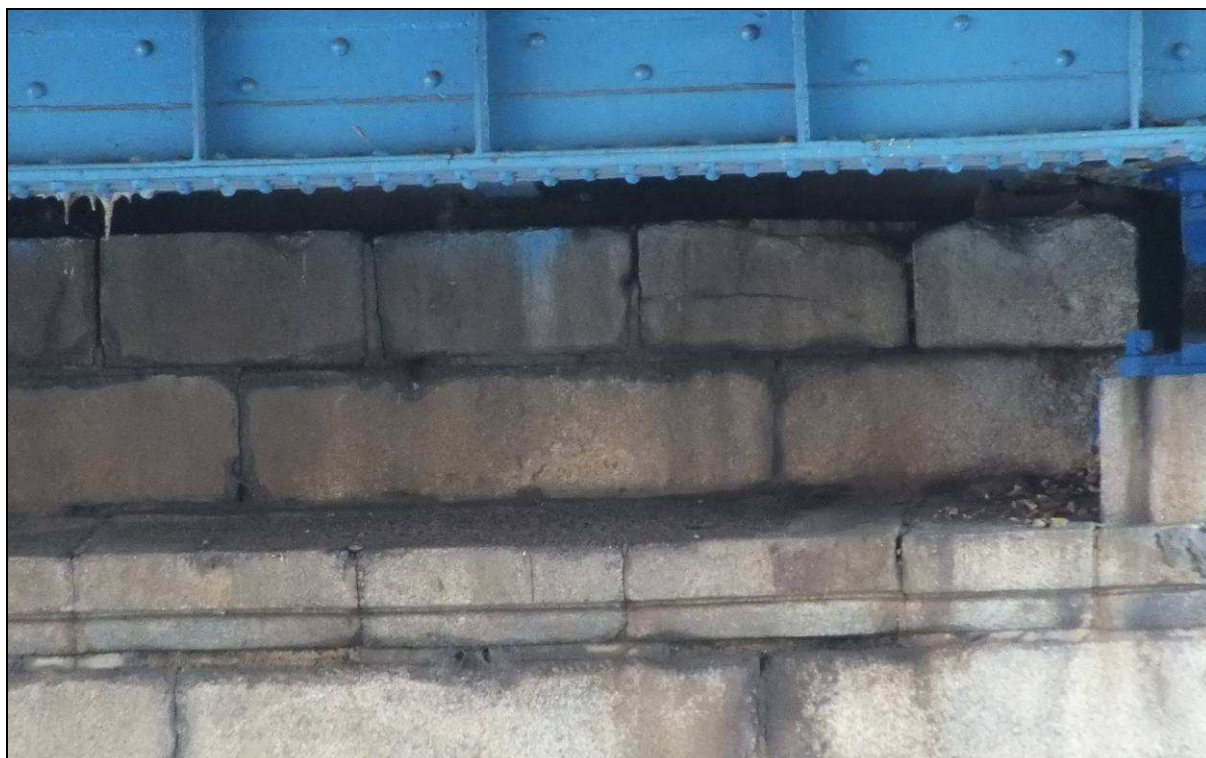
Rys. 5.63 Na zdjęciu powyżej widoczne zanieczyszczenia materiałem ziemnym, ubytki w spoinowaniu, spękania i wykruszenia na powierzchni kamiennych elementów oraz zawilgocenia w obrębie niszy podłożyskowej i ścianki zapleczonej przyczółka
