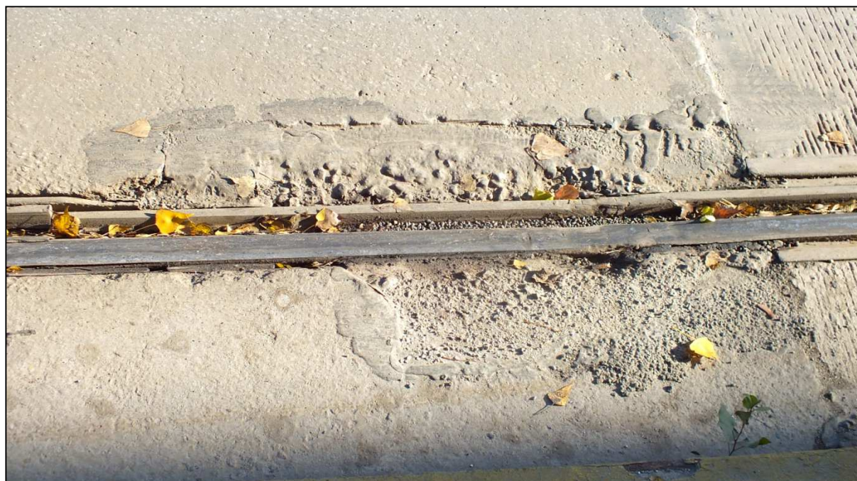
Rys. 5.102 Na zdjęciu powyżej widoczne ubytki betonowej płyty torowiska tramwajowego oraz ślady po wcześniejszych naprawach płyt w obrębie szyny jezdnej
