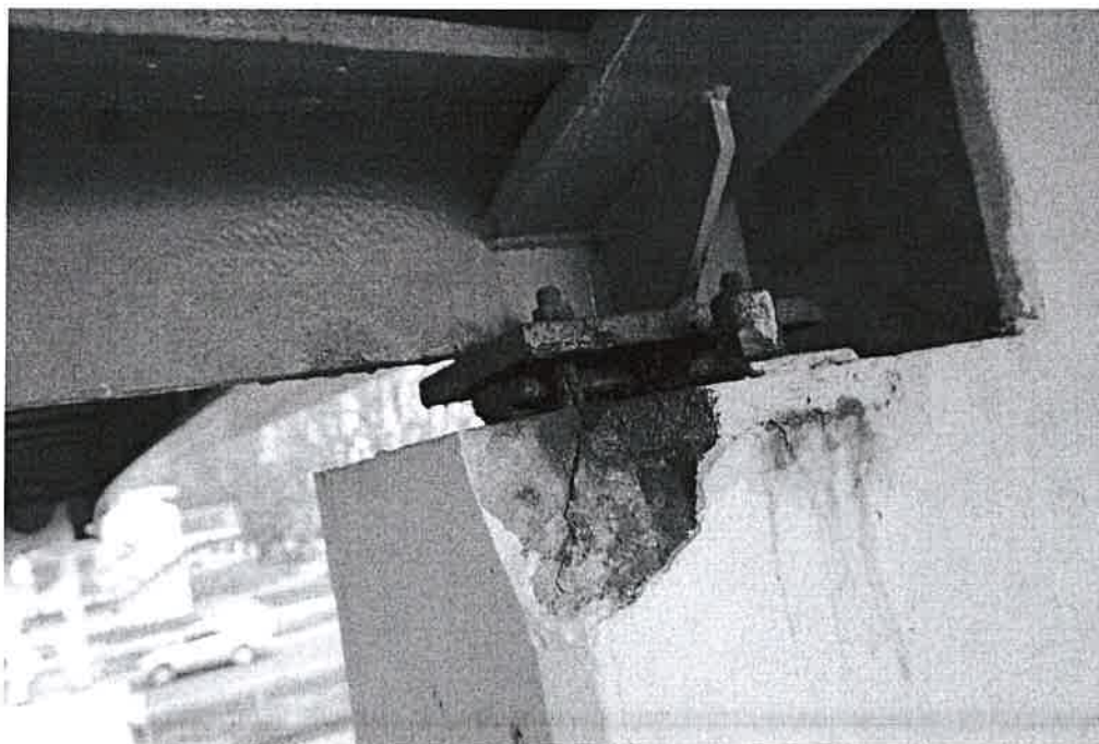
Fot 18. Znaczny ubytek betonu niszy podłożyskowej od strony południowej świadczący o słabej jakości betonu, braku zbrojenia lub nieprawidłowej pracy łożyska. Zaleca się wykonanie konserwacji łożysk oraz naprawę uszkodzonej niszy podłożyskowej poprzedzonej opracowaniem ekspertyzy diagnozującej przyczyny uszkodzeń
