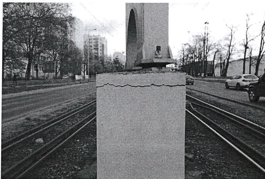
Fot.19. Pęknięcie stopy betonowej bezpośrednio pod oparciem słupa pośredniego (wahacza) spowodowane słabą jakością betonu, brakiem zbrojenia lub nieprawidłową pracą podpory.
