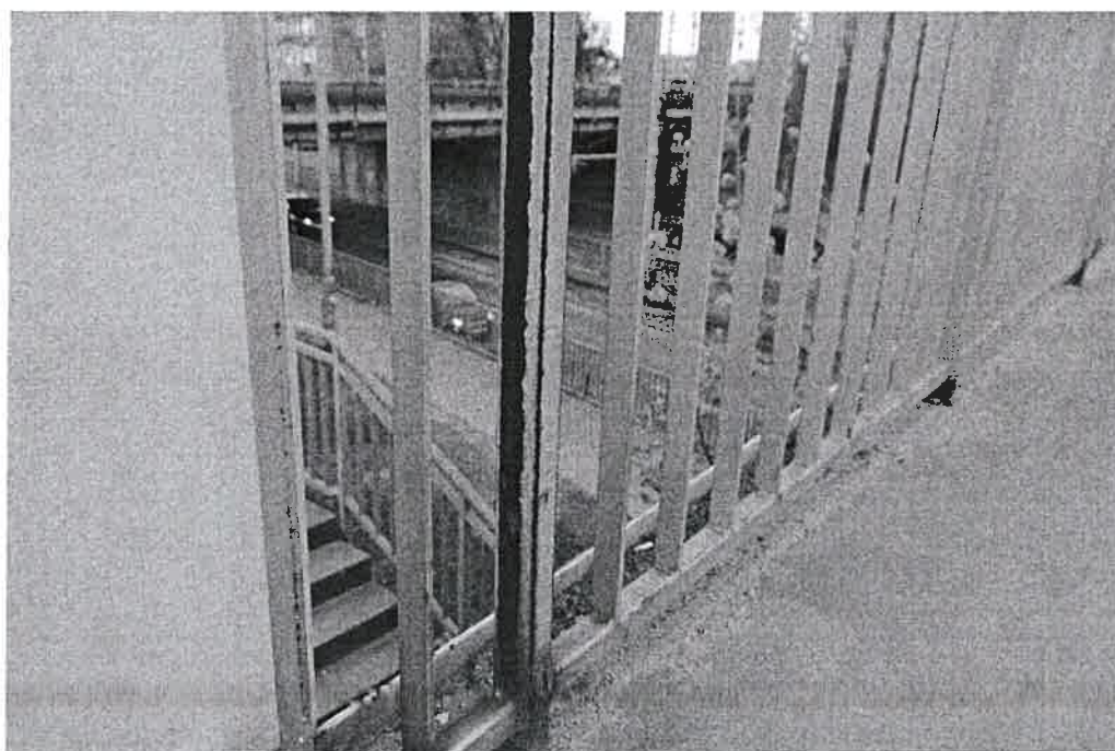
Fot.14. Zanieczyszczenia w linii balustrad, uszkodzenia powłok antykorozyjnych i oznaki korozji słupków balustrad stalowych – uszkodzenia spowodowane niedostateczną grubością powłok antykorozyjnych i brakiem prac renowacyjnych w zakresie zabezpieczeń antykorozyjnych.
