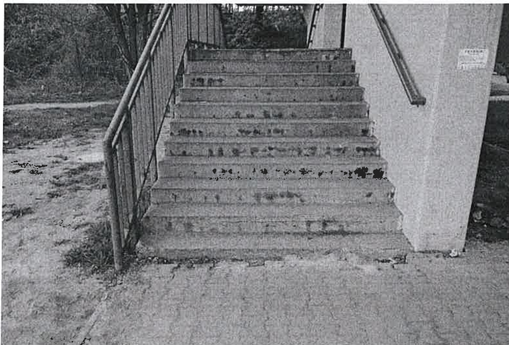
Fot.23. Wykwity korozyjne na powierzchni schodów świadczące o korozji zbrojenia, ubytki powłoki malarskiej, deformacje kostki betonowej przy dojściu do schodów. Zaleca się oczyszczenie biegów schodowych i odtworzenie powłok malarskich.
