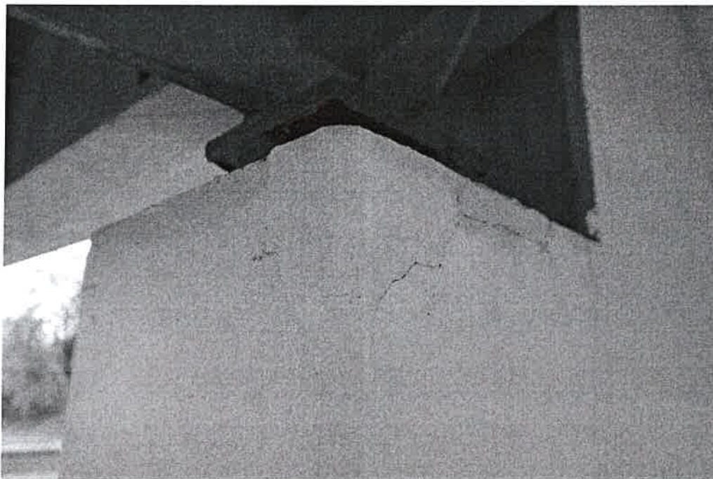
Fot.17. Spękania głowicy konstrukcji wsporczej pod łożyskiem od strony północnej świadczący o słabej jakości betonu, braku zbrojenia lub nieprawidłowej pracy łożyska. Zaleca się wykonanie konserwacji łożysk oraz naprawę uszkodzonej niszy podłożyskowej poprzedzonej opracowaniem ekspertyzy diagnozującej przyczyny uszkodzeń
