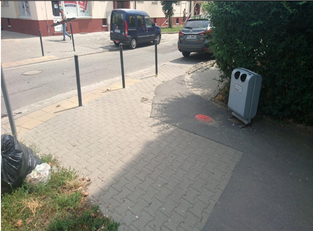
Fot. 2. Istniejąca nawierzchnia przy skrzyżowaniu z ul. Mochneckiego
