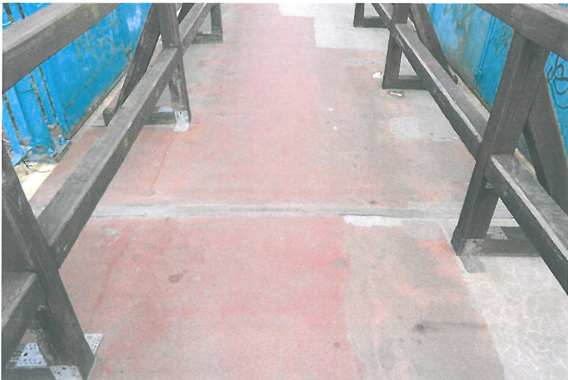
Fot. 20. Ubytki nawierzchni kładki i zanieczyszczenia w strefie dylatacji przęsła, ubytki materiału wypełniającego szczeliny dylatacyjne – górny poziom kładki.
