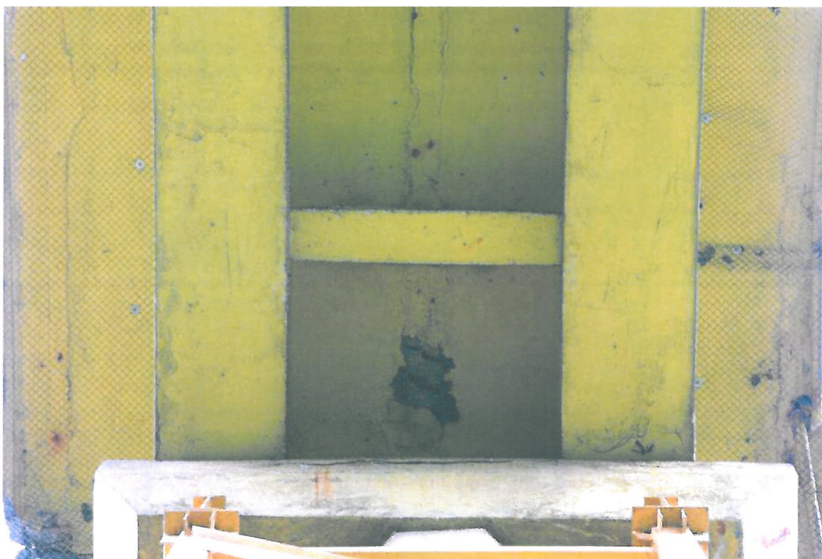
Fot. 52. Zarysowania podłużne od spodu konstrukcji na styku belek prefabrykowanych, miejscowe odspojenia otuliny betonowej odsłaniające skorodowane pręty zbrojeniowe.
