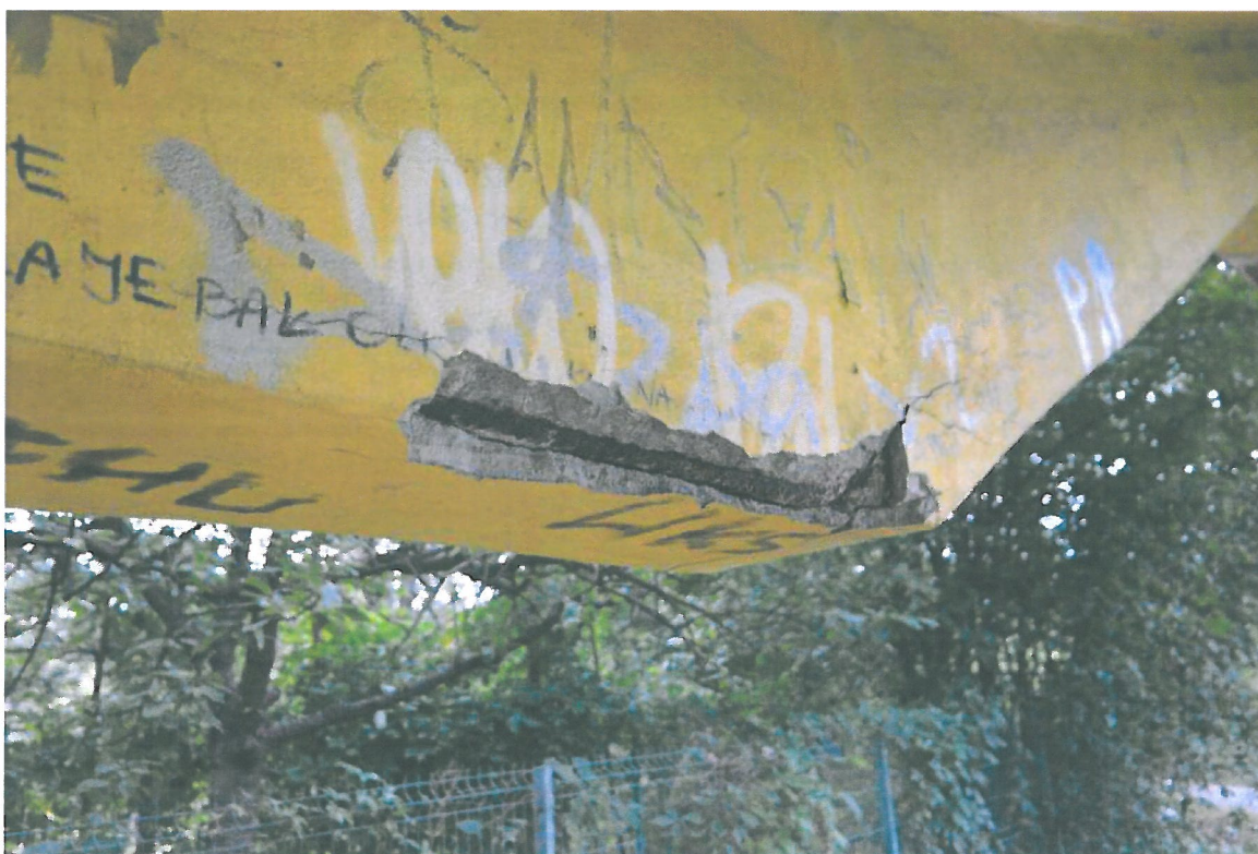
Fot. 50. Ubytki i spękania betonu w dźwigarze na załamaniu biegu schodowego od strony ul. Piwnika Ponurego (przęsło 8-9), odsłaniające skorodowane pręty zbrojeniowe.
