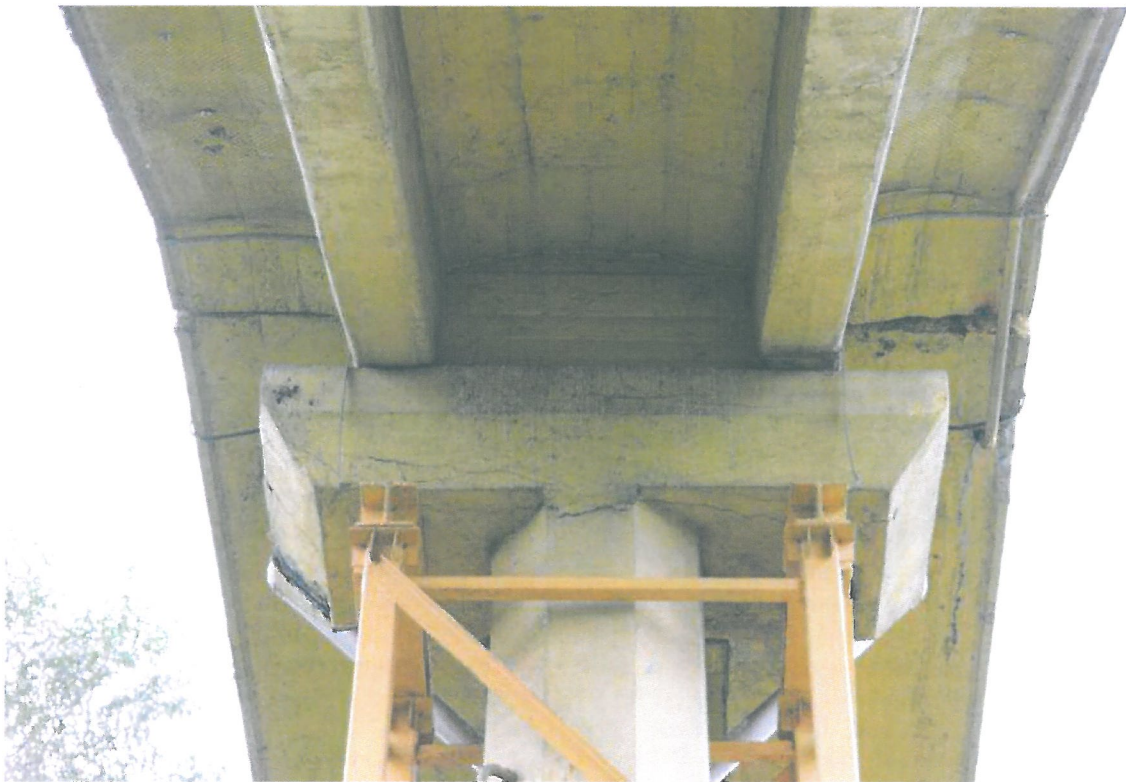
Fot. 44. Betonowy oczep podpory nr 7 – widoczne zarysowania na styku z słupem, konstrukcja stalowa pełniąca funkcję wygradzenia słupa i dodatkowego podparcia oczepu.
