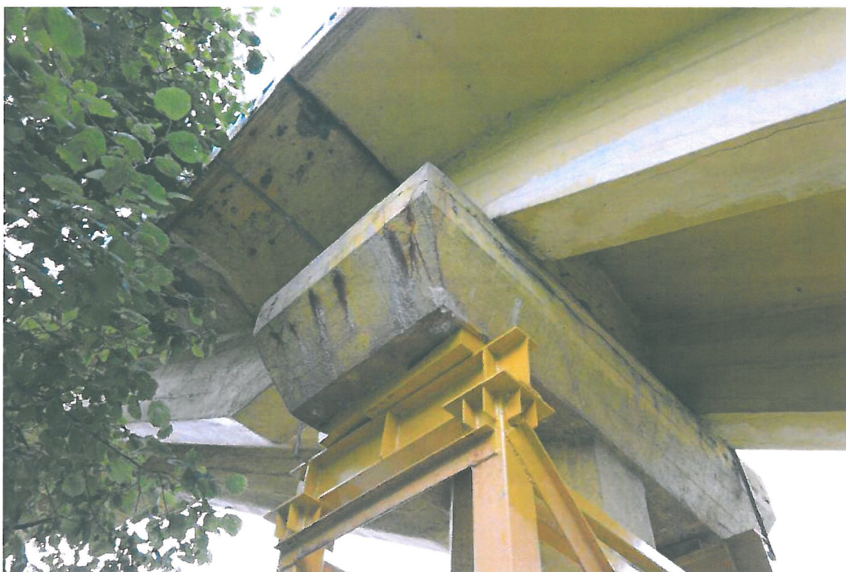
Fot. 48. Oczep podpory nr 8 – przerwanie ciągłości materiału w postaci poziomego pęknięcia oczepu, spękania, zarysowania, rdzawe zacieki i wykwyty korozyjne.
