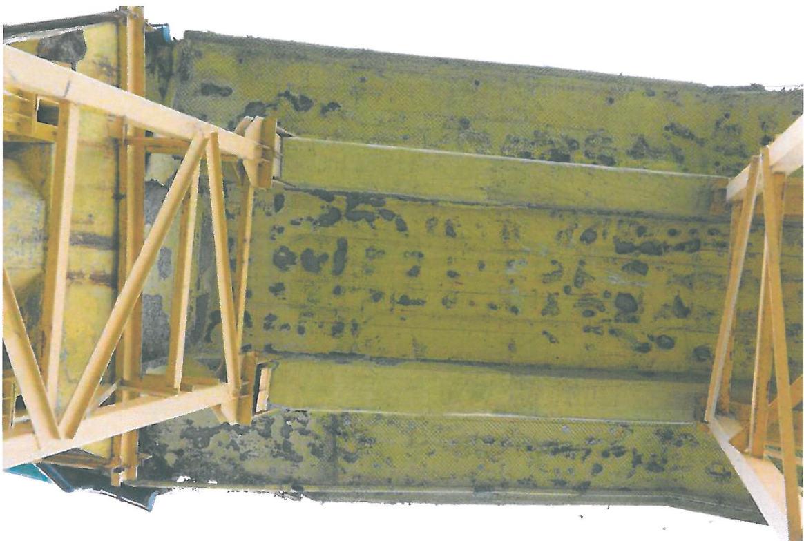
Fot. 40. Uszkodzenia powłok antykorozyjnych i ubytki betonu na spodzie ustroju nośnego – przeszło 4-5 w strefie tymczasowo podpartego biegu schodowego.
