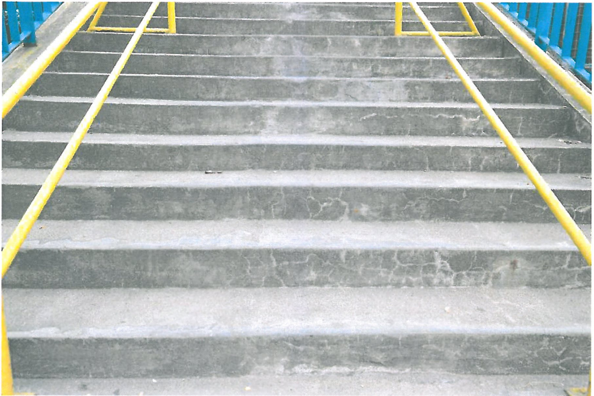
Fot. 9. Rysy, zacieki korozyjne, wykwity i ubytki betonu, zawężenie szerokości użytkowej – bieg schodowy od strony ul. Sycowskiej.
