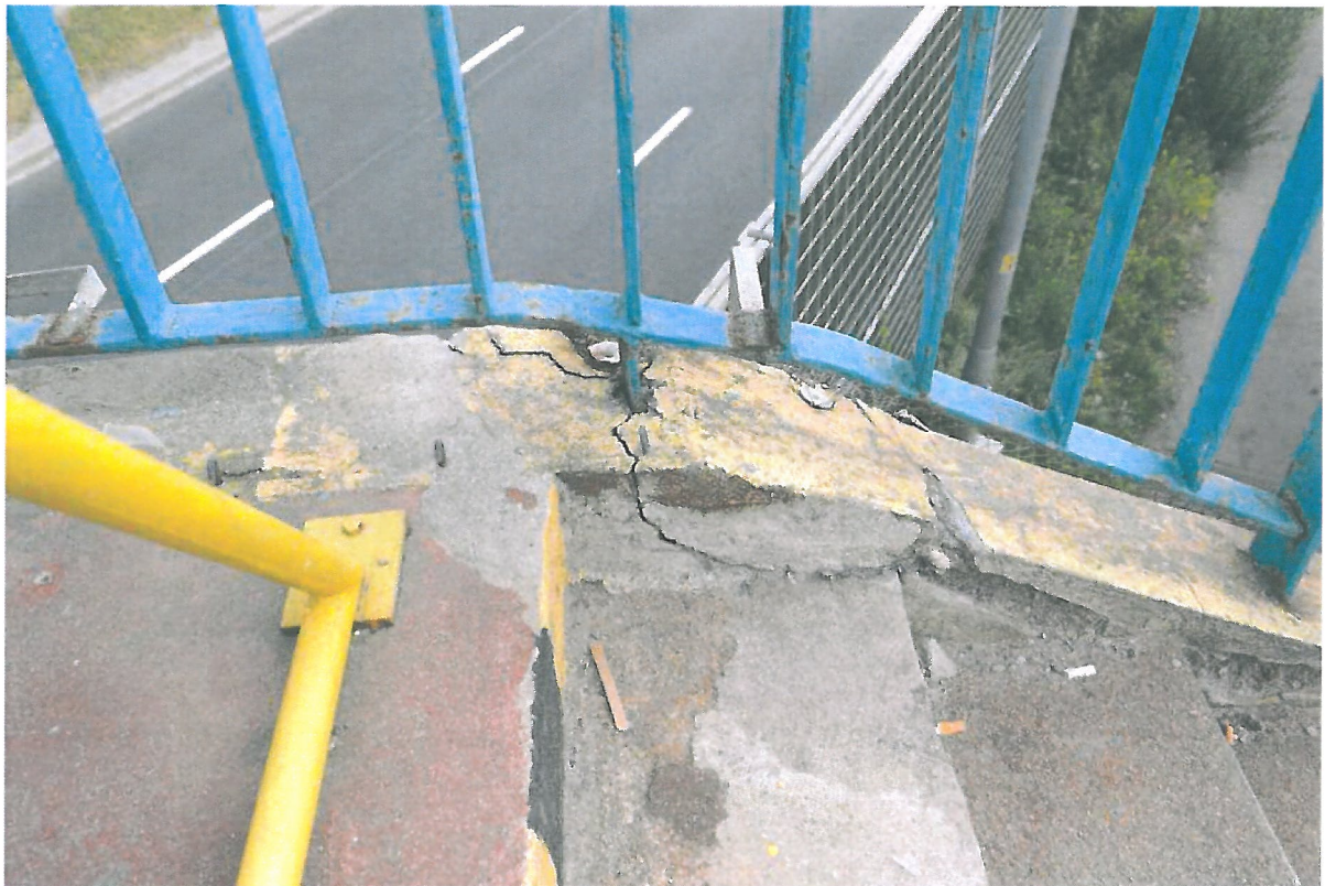
Fot. 12. Ubytki betonu wsporników płytowych, zanieczyszczenia w postaci graffiti – widok od spodu na bieg schodowy od strony ul. Sycowskiej.
