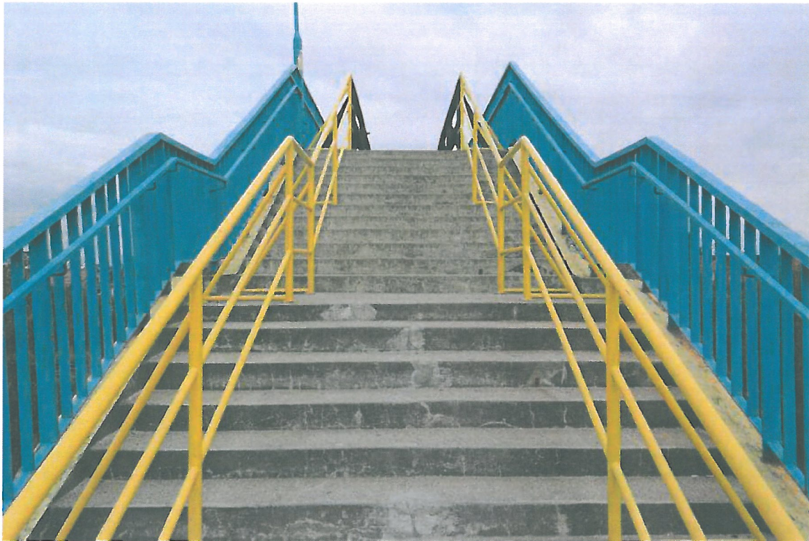
Fot. 17. Bieg prowadzący na górny poziom kładki od strony ul. Sycowskiej – zawężenie szerokości użytkowej, zarysowania i wykwyty korozyjne na powierzchni schodów.
