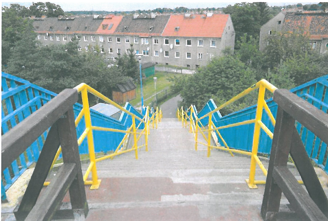
Fot. 23. Ubytki w nawierzchni górnego poziomu kładki w rejonie dylatacji, zawężona szerokość użytkowa – bieg schodowy od strony ul. Piwnika Ponurego.
