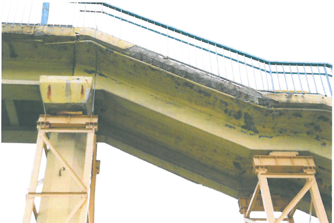
Fot. 38. Ubytki betonu wspornika płytowego i gzymsu pomiędzy podporą nr 5 (z lewej) a podporą tymczasową biegu schodowego (przęsło 4-5) prowadzącego na górny poziom kładki.
