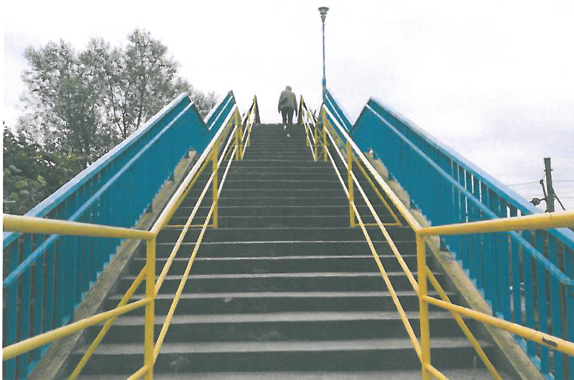
Fot. 26. Widok od strony ul. Piwnika Ponurego na bieg schodowy prowadzący na górny poziom kładki (nad torami PKP) – spękania, ubytki betonu i zacieki na schodach.
