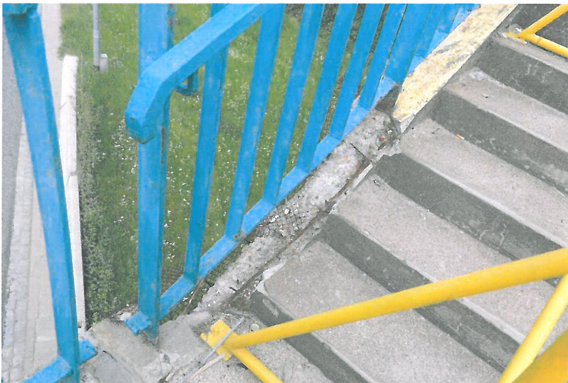
Fot. 18. Znaczący ubytek betonu belki podporęczowej, spękania stopni schodowych – bieg schodowy prowadzący na górny poziom kładki od strony ul. Sycowskiej
