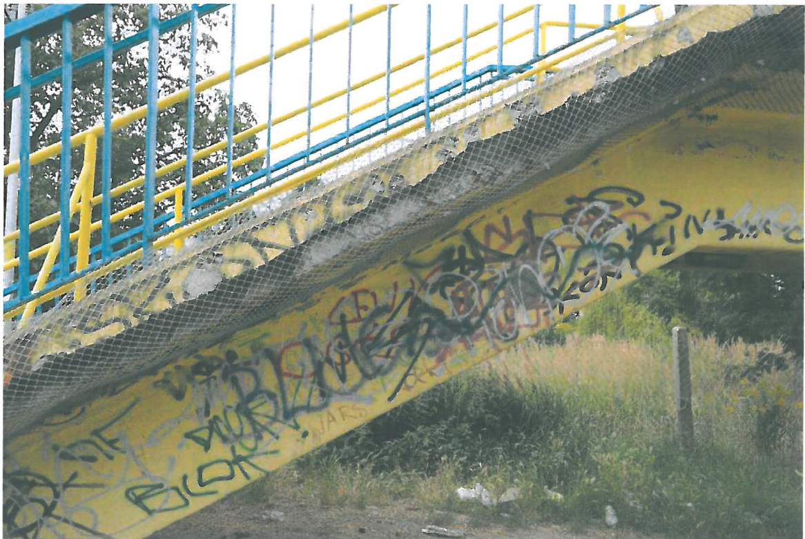
Fot. 10. Duże ubytki betonu odsłaniające skorodowane pręty zbrojeniowe gzymsu, widoczne osiatkowanie ochronne – bieg schodowy od strony ul. Sycowskiej.
