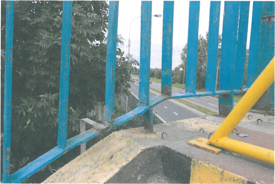
Fot. 15. Uszkodzenie powłok antykorozyjnych elementów stalowych balustrad, ubytki nawierzchni kładki i zanieczyszczenia w strefie gzymsów.
