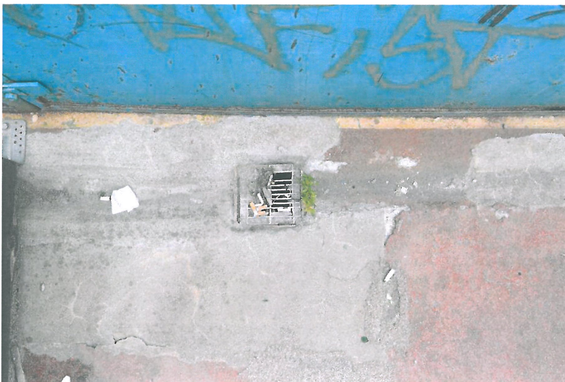
Fot. 22. Zanieczyszczone, niedrożne wpusty odwadniające, uszkodzenia i braki w nawierzchni żywicznej kładki, odsłaniające spękaną konstrukcją płyty pomostu.
