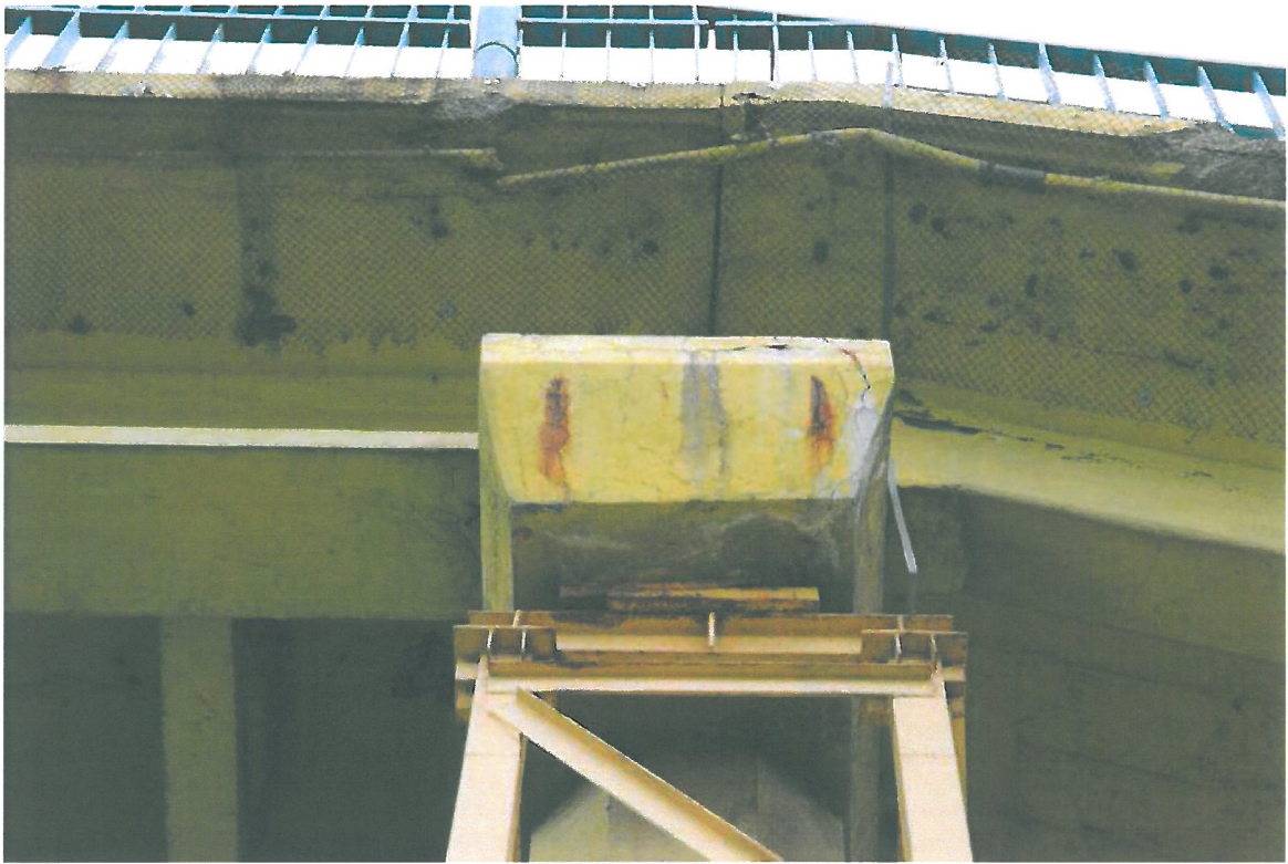
Fot. 39. Podpora nr 5 – spękania oczepu, zacieki korozyjne, korozja podpory stalowej, uszkodzenia powłok ochronnych betonu na spodzie wspornika, ubytki betonu gzymsów.
