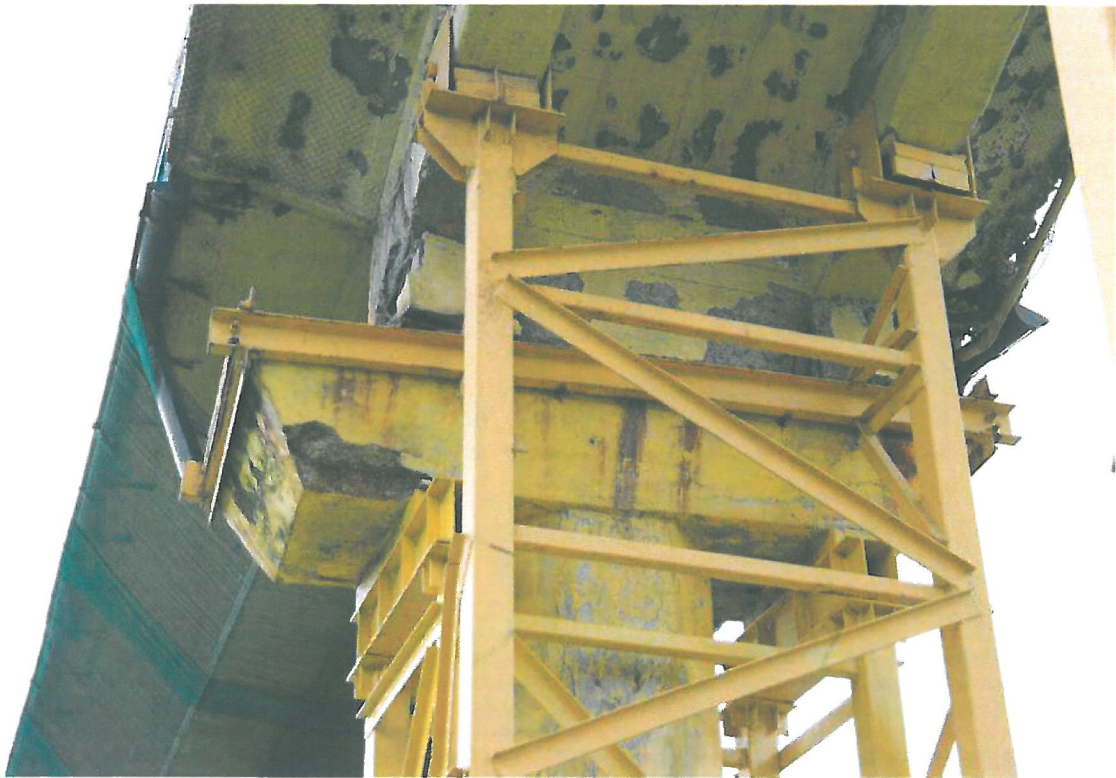
Fot. 35. Podpora nr 4 – duże ubytki betonu oczepu , rdzawe zacieki i zarysowania świadczące o znacznym stopniu degradacji tego elementu.
