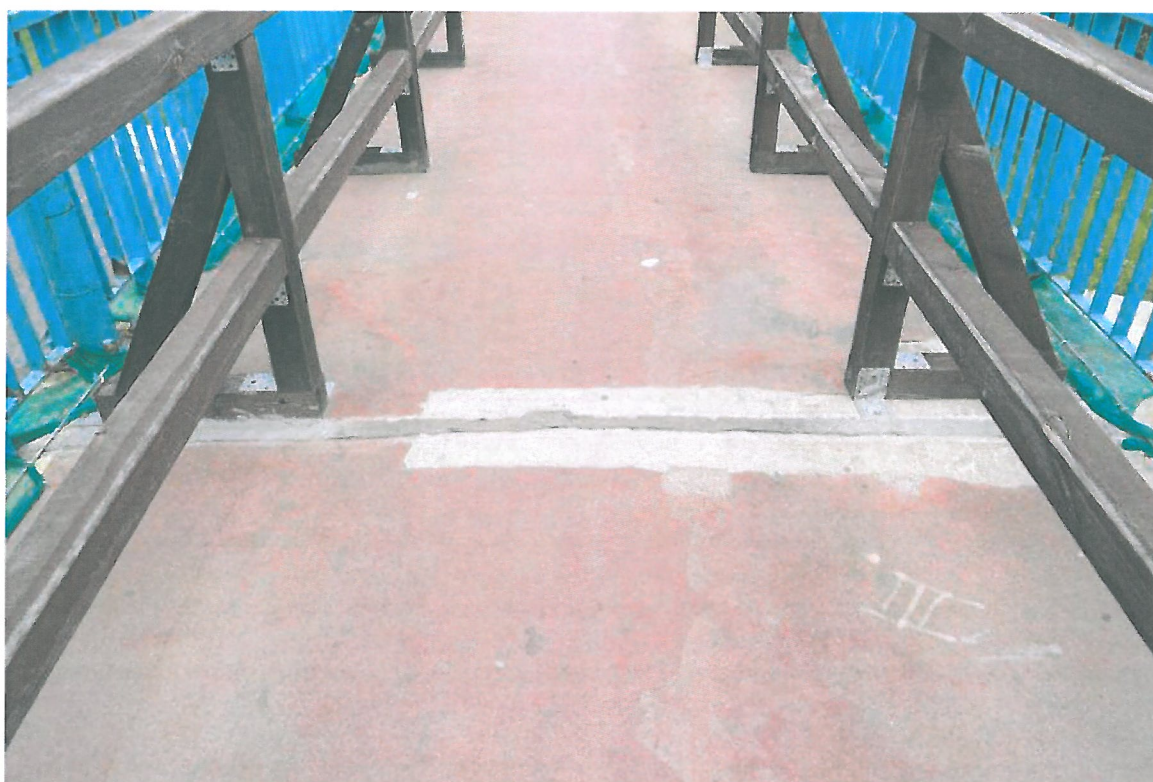
Fot. 14. Zanieczyszczenia i ubytki materiału wypełniającego szczeliny dylatacyjne, ubytki w nawierzchni żywicznej w strefie dylatacji – dolny poziom kładki.
