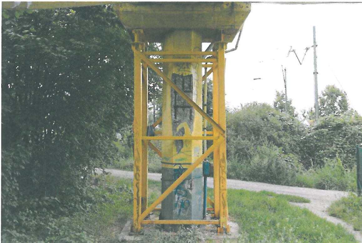
Fot. 45. Podpora nr 8 – ubytki betonu odsłaniające skorodowane pręty zbrojeniowe słupa, widoczna konstrukcja wzmacniająca podporę i stanowiąca dodatkowe podparcie oczepu.
