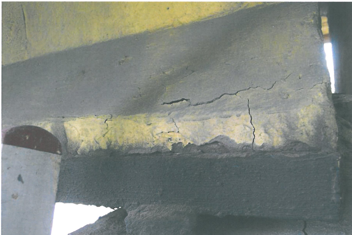
Fot. 54. Zarysowania strefy podporowej belek prefabrykowanych i zanieczyszczenia łożysk świadczące o braku ich bieżącej konserwacji.
