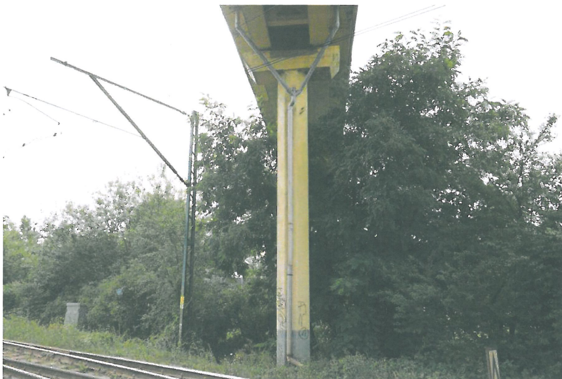
Fot. 41. Podpora nr 6 przy terenie kolejowym – widoczne zanieczyszczenia w postaci graffiti, ponadto występują spękania i lokalne odspojenia betonu.
