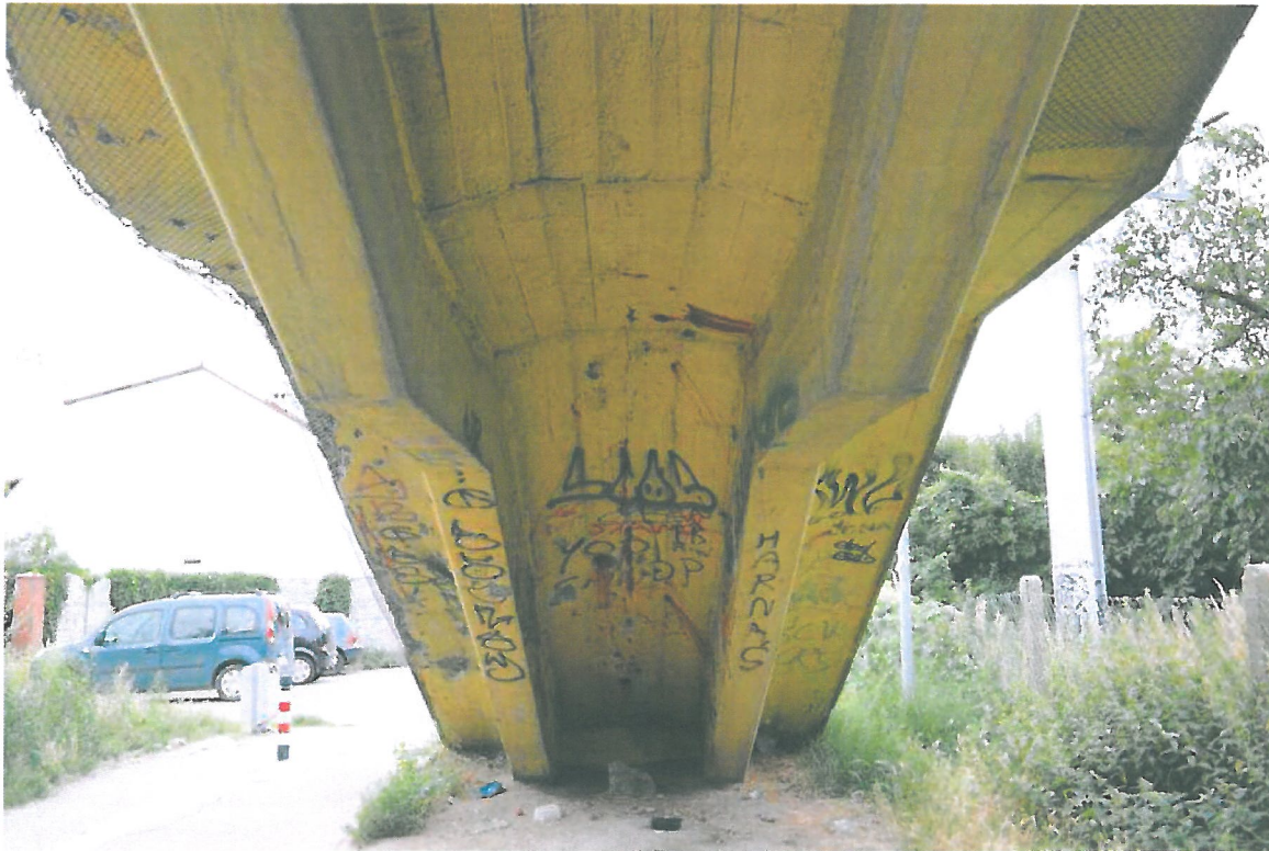
Fot. 29. Ubytki betonu wsporników płytowych, zanieczyszczenia w postaci graffiti – widok od spodu na podporę nr 1 i bieg schodowy od strony ul. Sycowskiej.
