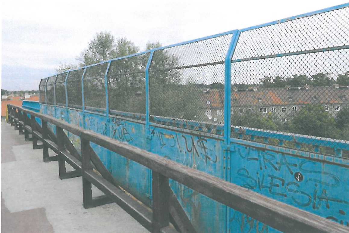
Fot. 21. Ubytki nawierzchni kładki, zanieczyszczenie w postaci graffiti i zniszczenia powłok antykorozyjnych na osłonach przeciwporażeniowych.
