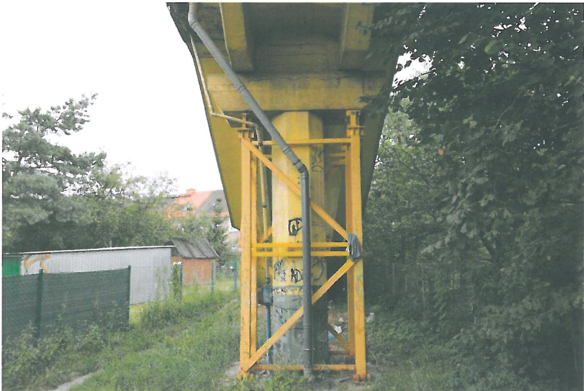
Fot. 31. Podpora pośrednia nr 2 – żelbetowy słup wzmocniony dodatkową konstrukcją stalową stanowiącą dodatkowe podparcie oczepu podpory i biegu schodowego.
