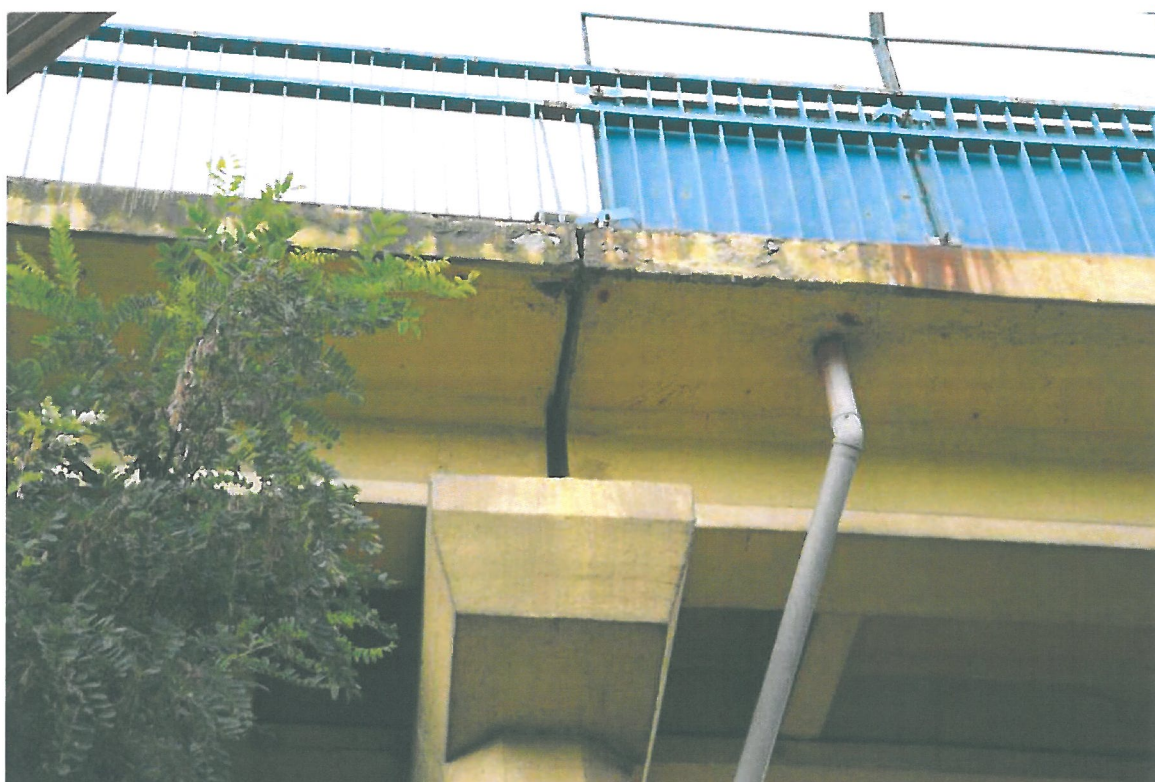
Fot. 42. Zacieki i wykwyty korozyjne na bocznej powierzchni gzymsu w strefie podpory nr 6, zacieki korozyjne w strefie osadzenia wpustów i rur spustowych.
