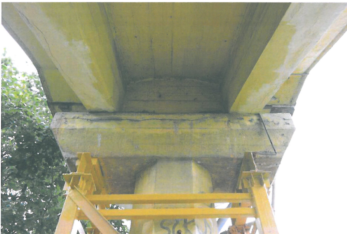
Fot. 46. Podpora nr 8 – widoczne spękania, zarysowania, ubytki betonu, wykwity korozyjne i zanieczyszczenia powierzchni betonowej słupa i oczepu.
