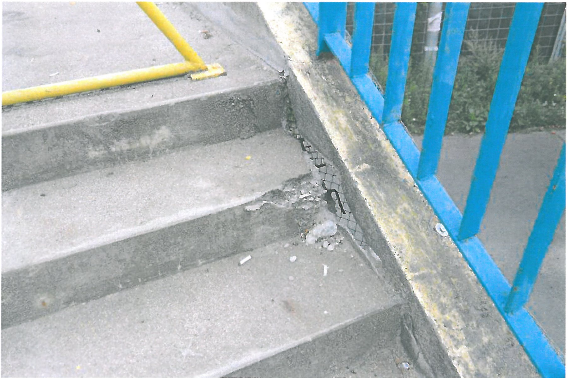
Fot. 11. Znaczny ubytek betonu na styku wspornika płytowego i gzymsu – bieg schodowy od strony ul. Sycowskiej.
