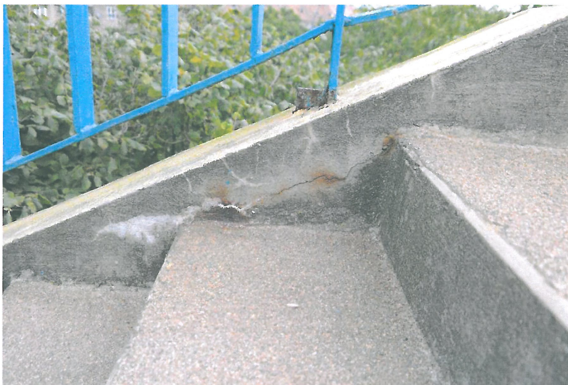
Fot. 24. Spękania i zacieki korozyjne na wewnętrznej powierzchni belki gzymsowej, brak odpowiedniego zabezpieczenia antykorozyjnego betonu gzymsów.
