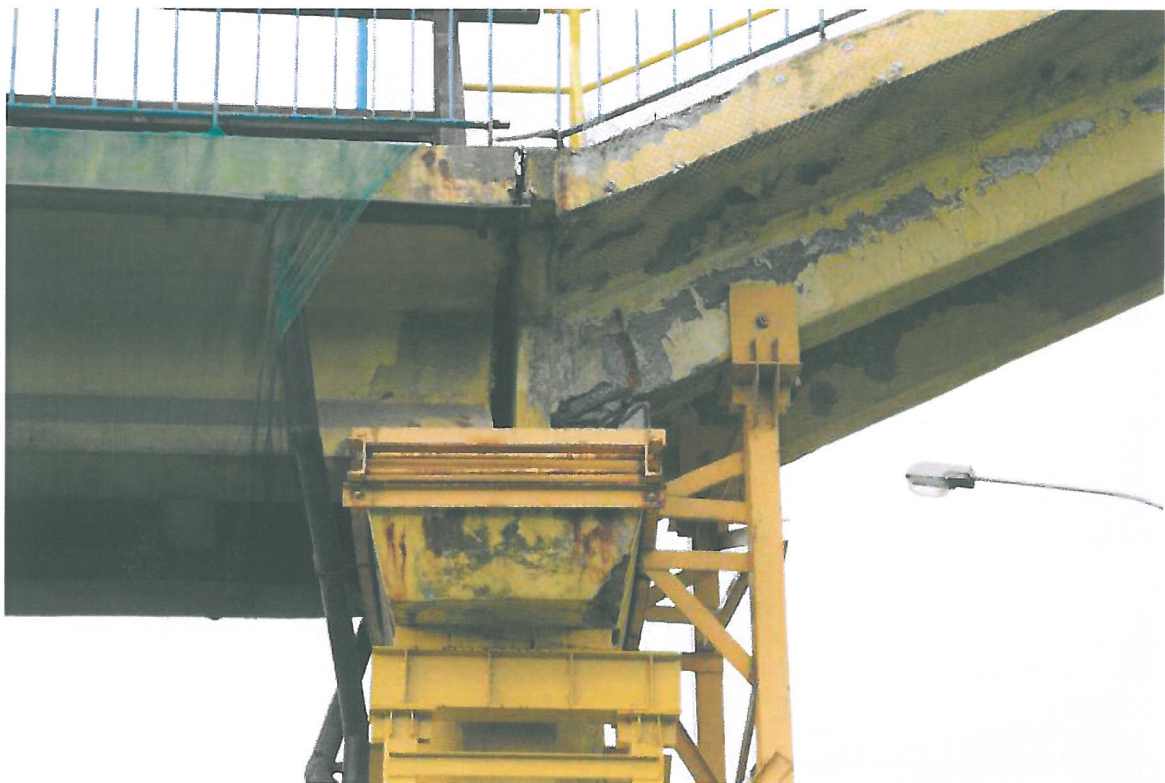
Fot. 36. Podpora nr 4 jak wyżej – nad podporą widoczne ubytki betonu odsłaniające zbrojenie w strefie podporowej belki biegu schodowego prowadzącego na górny poziom kładki.
