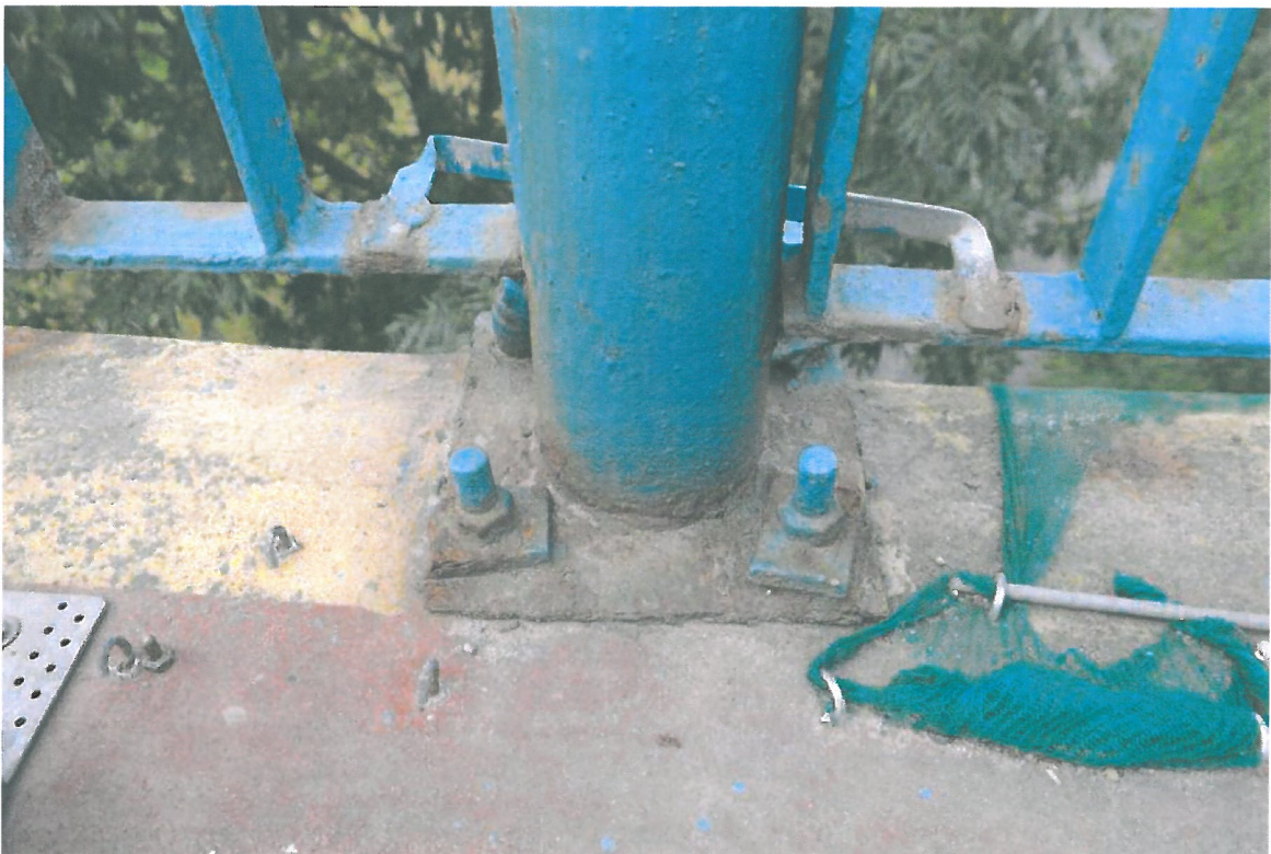
Fot. 16. Uszkodzone powłoki antykorozyjne i korozja wżerowa elementów stalowych balustrad, korozja elementów stalowych zamocowania słupów latarni, korozja łączników.
