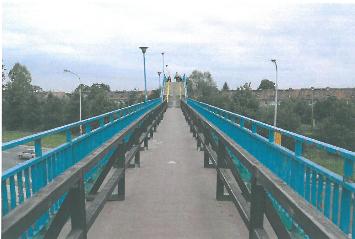
Fot. 13. Zanieczyszczenia nawierzchni żywicznej kładki, widoczna konstrukcja zawężająca szerokość użytkową – widok od ul. Sycowskiej, w tle bieg prowadzący na górny poziom kładki.
