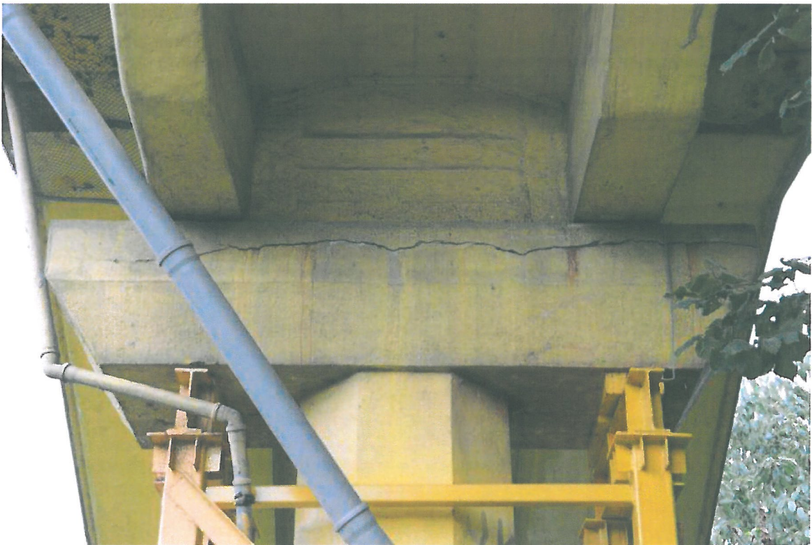
Fot. 32. Zarysowania oczepu podpory nr 2 świadczące o słabej jakości betonu oczepu, widoczne rdzawe zacieki korozyjne spowodowane penetracją wody.
