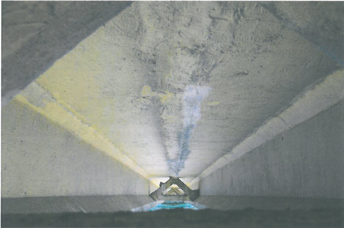
Fot. 53. Zacieki i wykwyty oraz podłużne zarysowania na spodzie pomostu w strefie połączenia górnych półek belek prefabrykowanych.
