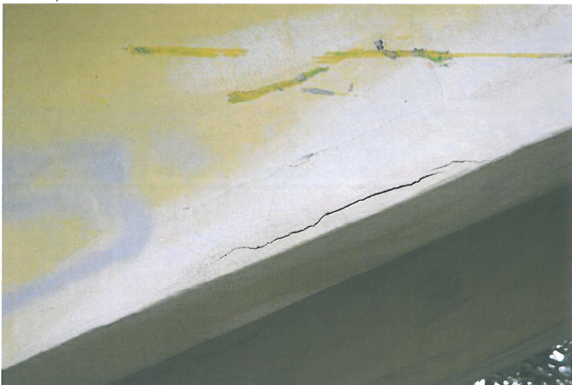
Fot. 30. Pęknięcie belki głównej biegu schodowego, możliwość odspojenia otuliny betonowej – bieg schodowy pomiędzy podporami 1 i 2 od strony ul. Sycowskiej.
