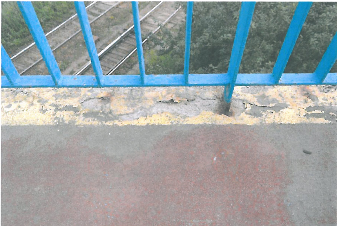
Fot. 28. Uszkodzone powłoki antykorozyjne gzymsów i brak odpowiedniego zakończenia nawierzchni kładki na ich górnej powierzchni, korozja zamocowania słupków balustrad.
