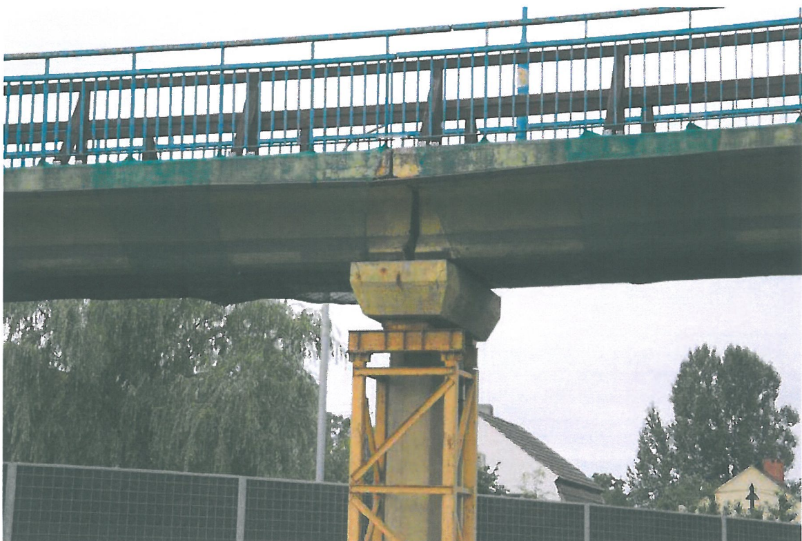
Fot. 34. Podpora nr 3 – widoczne spękania i rdzawe zacieki korozyjne na powierzchni oczepek, powyżej widać zdegradowany oczep (ubytki, zarysowania, zacieki, korozja zbrojenia).
