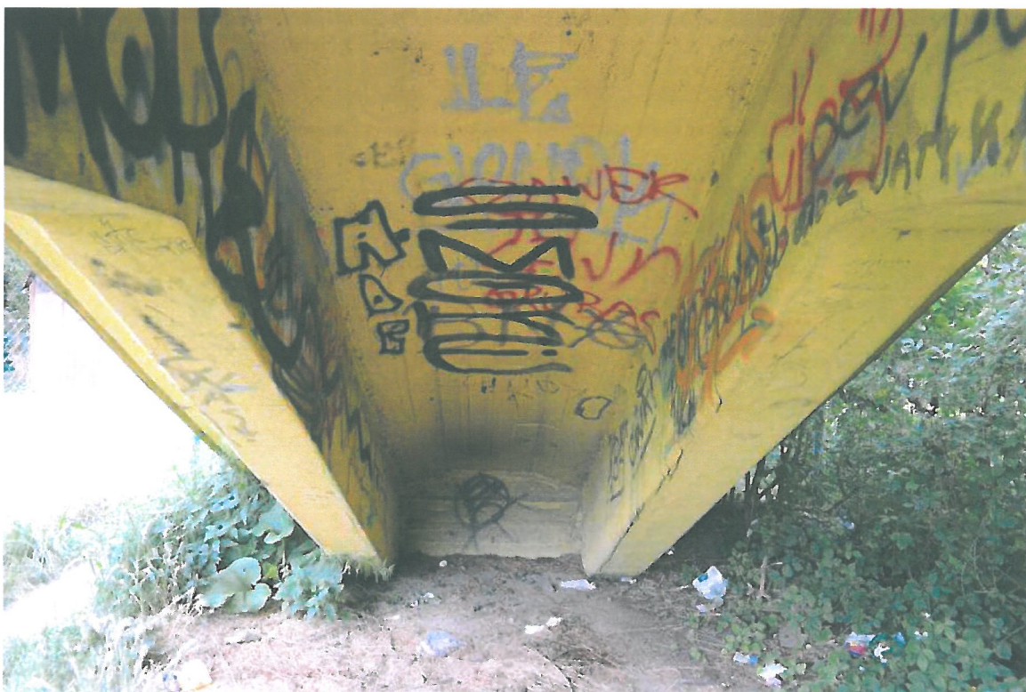
Fot. 49. Zanieczyszczenia w postaci graffiti widoczne na powierzchni dźwigarów i spodzie płyty pomostu – bieg schodowy od strony ul. Piwnika Ponurego (podpora nr 9).
