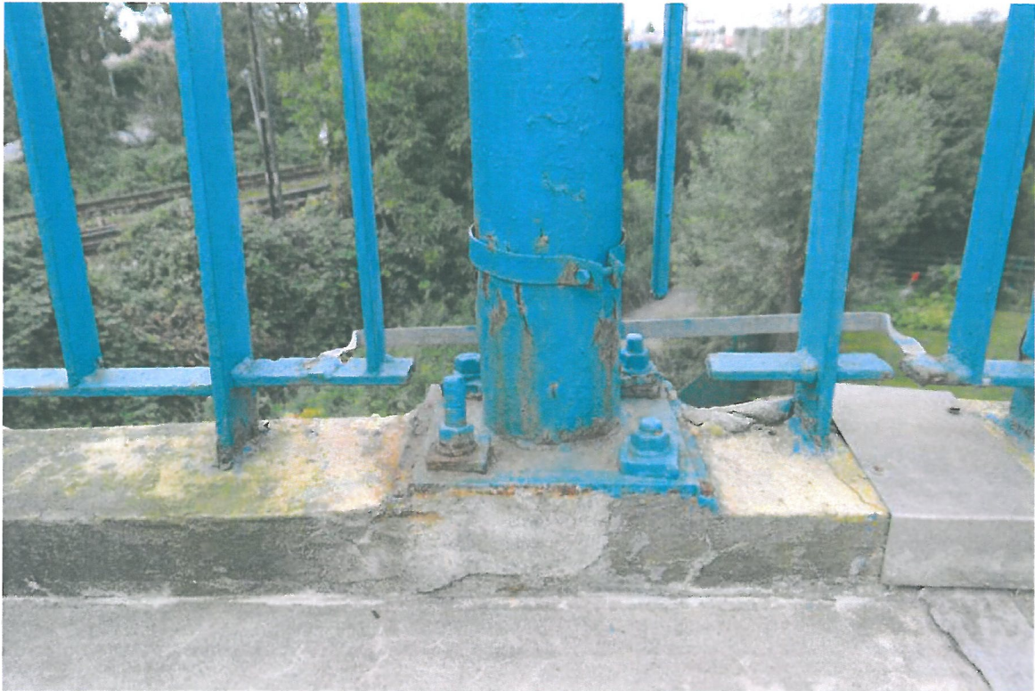
Fot. 27. Korozja elementów stalowych balustrad i ich zakotwień, ubytki materiałowe w przeciągu balustrady i szczelinkach, korozja słupa latarni i jego zamocowania.
