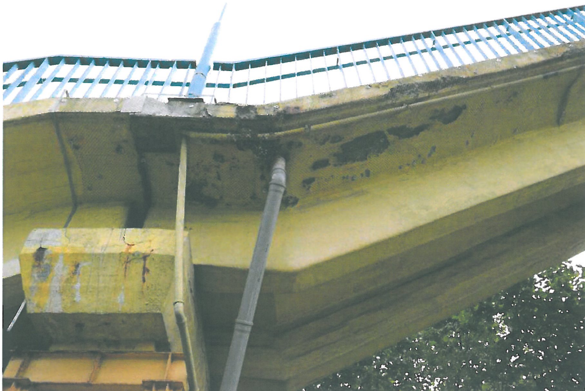
Fot. 47. Wspornik płytowy biegu schodowego w strefie oparcia na podporze nr 8 – ubytki i zarysowania świadczące o postępującej degradacji betonu pomostu i gzymsów.
