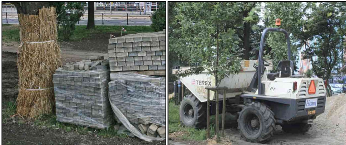
Rysunek: możliwe uszkodzenia spowodowane przez ruch pojazdów i maszyn budowlanych.
