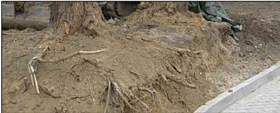
Rys. Efekt złego wykonywania robót budowlanych – odcięcie i odstonienie korzeni
