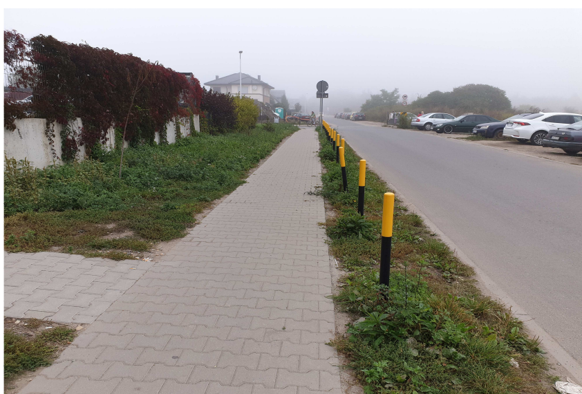
Zdjęcie nr 3. Chodnik z kostki betonowej wzdłuż ul. Schuberta.
