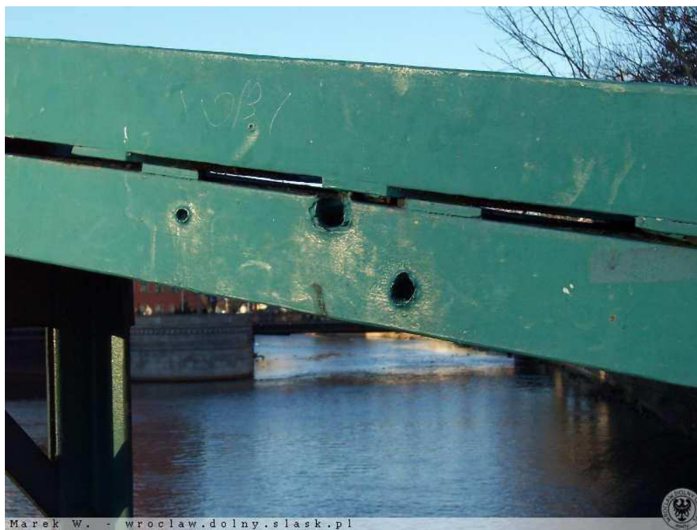
Fot. 24. Fragment czoła uszkodzonej kratownicy, widok od strony jezdni.
