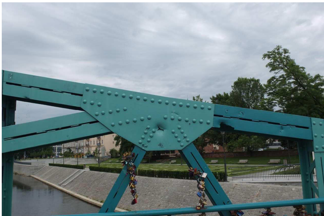
Fot. 23. Fragment uszkodzonego wiązara, widok od strony jezdni.
