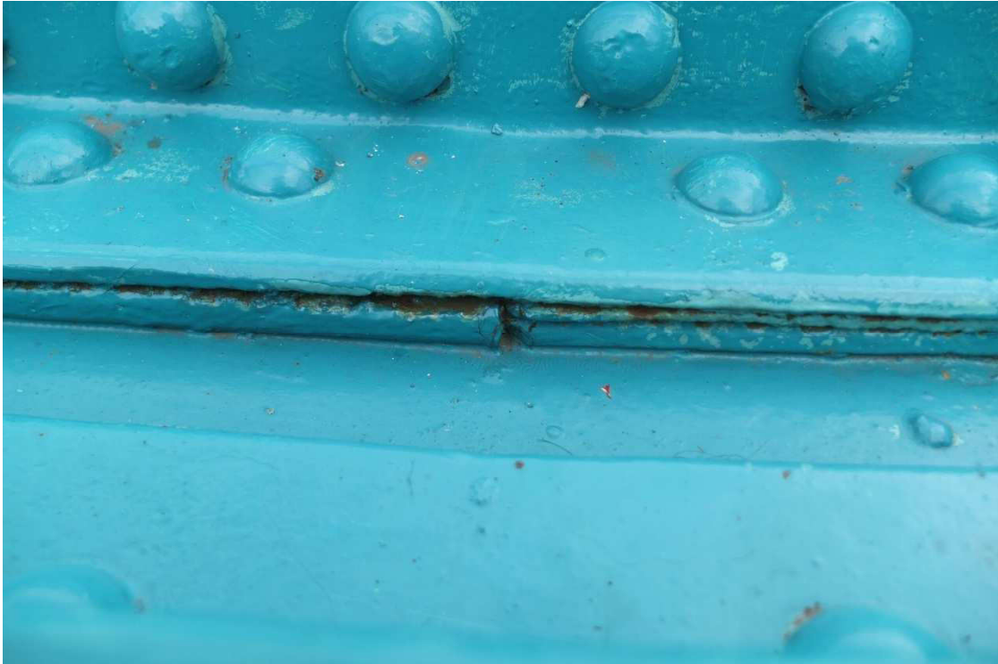
Fot. 27. Fragment uszkodzonej i skorodowanej kratownicy.
