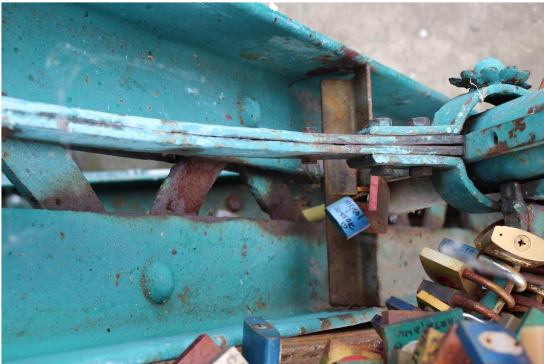
Fot. 28. Uszkodzenia kratownicy w rejonie osadzenia słupa oświetlenia gazowego.
