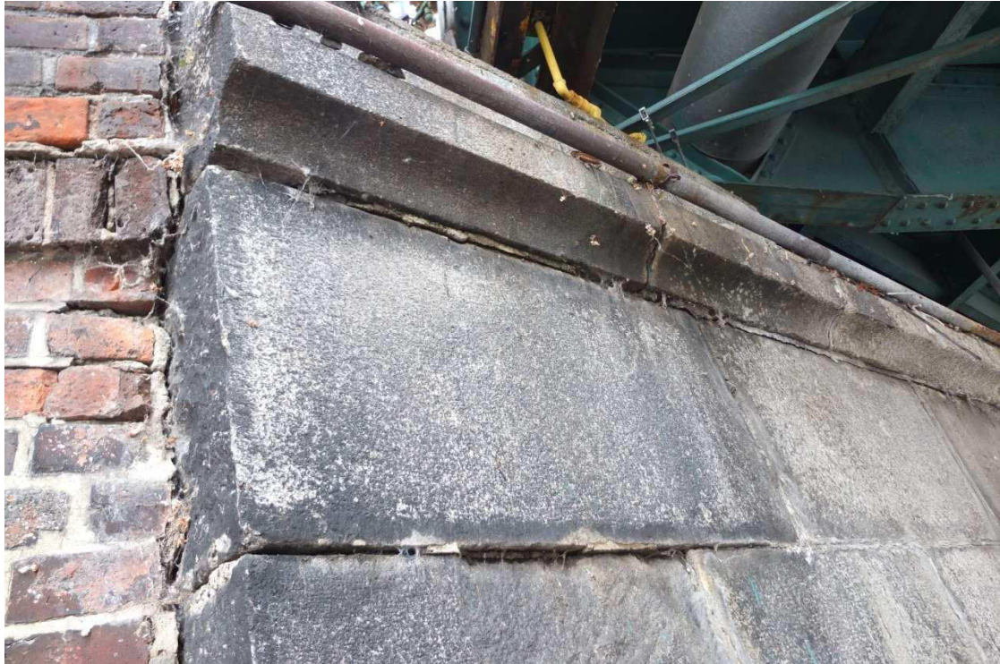
Fot. 19. Fragment przyczółka zachodniego z widocznymi wypłukanymi spoinami.
