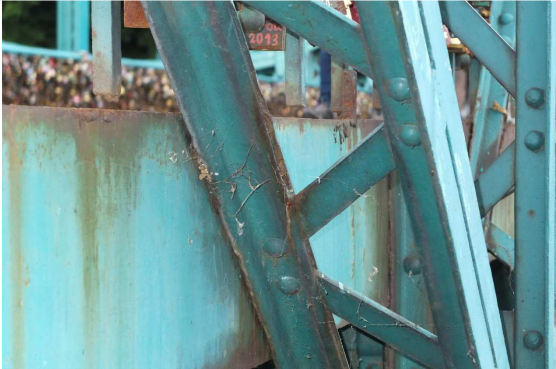
Fot. 25. Fragment skorodowanej kratownicy, widok od strony jezdni.
