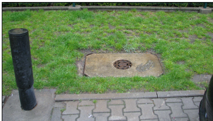
Widok na urządzenia operatora Netia S.A.: studnię WR077414S oraz słupek WR077:53;271
