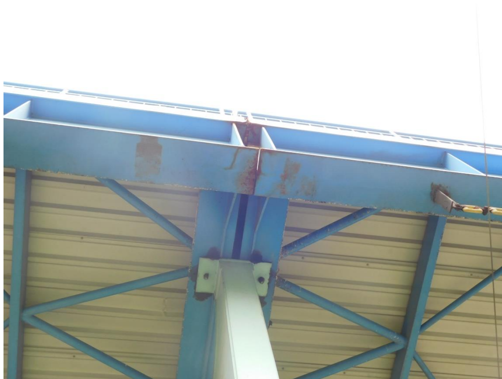
Fot. 9 Miejskowe zniszczenia powłok ochronnych stalowych dźwigarów wraz z ogniskami korozji powierzchniowej. Uszkodzenia wywołane zaciekami wody z pomostu.
