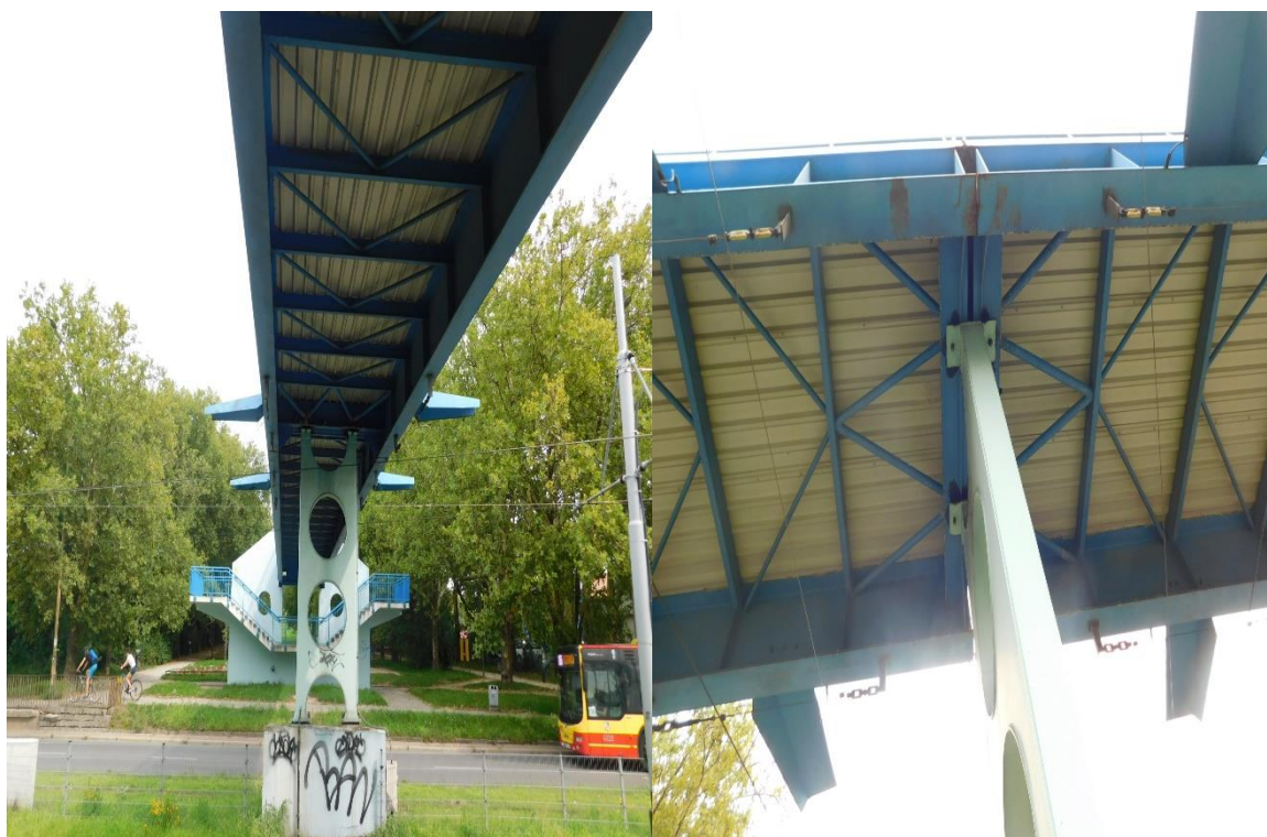
Fot. 11 Miejscowe zanieczyszczenia stalowych i betonowych elementów podpory pośredniej w postaci graffiti, powstałe na skutek aktów wandalizmu.
