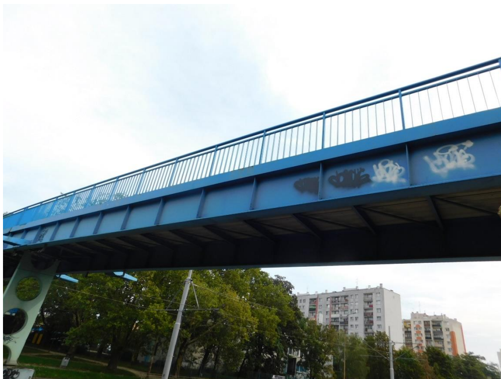
Fot. 10 Miejscowe zanieczyszczenia stalowych dźwigarów w postaci graffiti, powstałe na skutek aktów wandalizmu.
