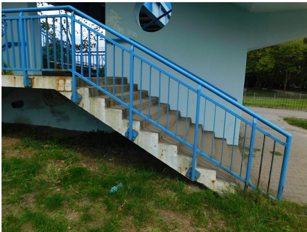
Fot. 8 Miejskowe rdzawe zacieki betonu spowodowane zaciekami wody z biegu schodowego na stalowe elementy, które uległy procesom korozyjnym.
