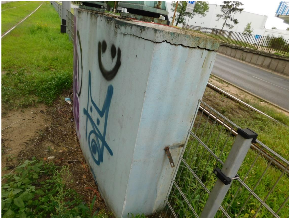
Fot. 12 Spękania oraz odspojenia przypowierzchniowych warstw betonu podpory pośredniej spowodowane zaciekami wody.
