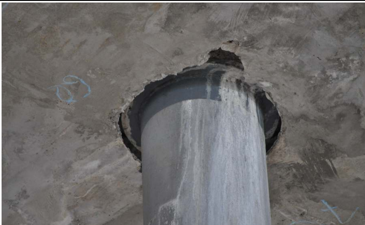
Fot. 9 Widok od posdu w strefie słupa S4. Widoczne uszkodzenie płyty zadaszenia spowodowane jej przebiciem.
