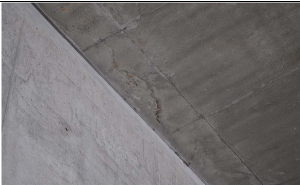
Fot. 12 Widok na strefę połączenia zadaszenia ze ścianą podpierającą. Widoczne wyraźne, rdzawe zacieki świadczące o niszczeniu lub braku odpowiedniej izolacji w strefie połączenia.
