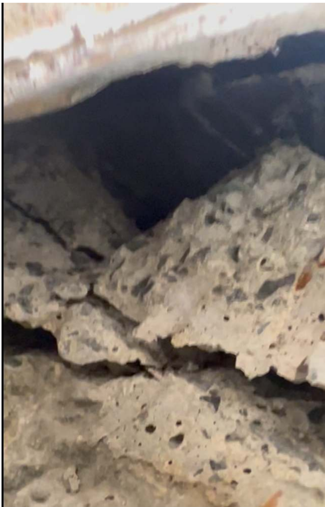
Rys. 5.6. Widok na strefę “wbicia” słupa S4 w powierzchnię płyty zadaszenia. Widoczne zniszczenie (zmiażdżenie betonu) w miejscu “przbicia”
