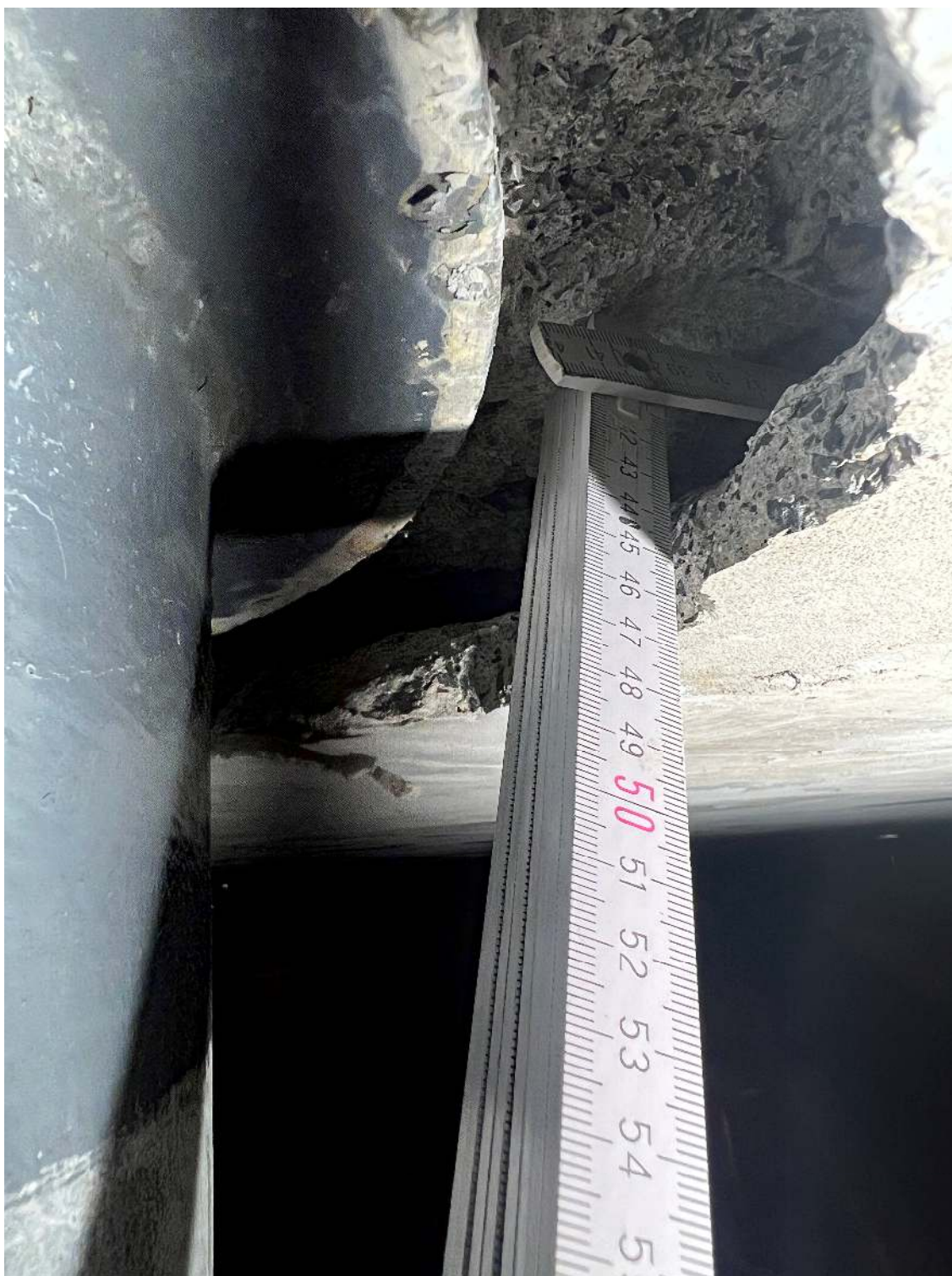
Rys. 5.4. Widok na strefę “wbicia” słupa S4 w powierzchnię płyty zadaszenia. Widoczny zakres szacowanej pustki (kieszeni) na podstawie zasięgu miary drewnianej.
