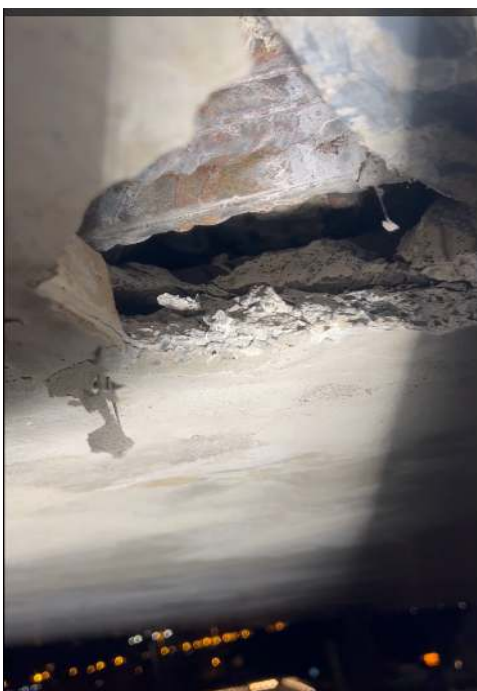
Fot. 5 Widok od spodu na zadaszenie przystanku. Widoczny wyraźny ubytek betonu w dolnej strefie płyty zadaszenia spowodowany wbiciem słupa. Jednocześnie widoczne oparcie słupa podpierającego na zbrojeniu dolnym płyty.
