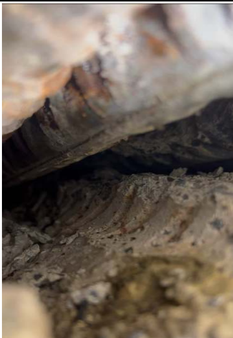
Fot. 6 Widok od spodu na zadaszenie przystanku. Widoczne odspojenie zbrojenia dolnego od otuliny oraz powstała pustka powietrzna.
