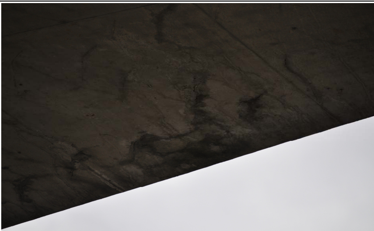
Fot. 14 Widok na płytę zdaszenia w strefie krawędzi od strony północnej. Widoczne odbarwienia, zacieki oraz zasrysowania betonu.
