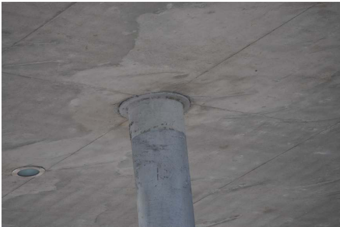
Rys. 5.1. Widok na jeden ze słupów podpierających. Widoczne uszkodzenie zabezpieczeń atykorozyjnych słupa oraz rdzawe zacieki w strefie połączenia głowicy z płytą zadaszenia.
