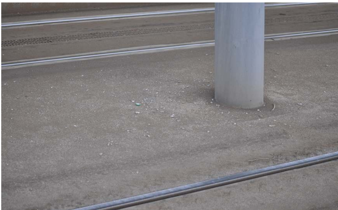
Fot. 8 Widok na peron w tsrefie słupa S4. Widoczne luźne elementy betonowe spadające z płyty zdaszzenia w miejscu przebicia, stwarzające zagrożenie dla użytkowników przystanku.
