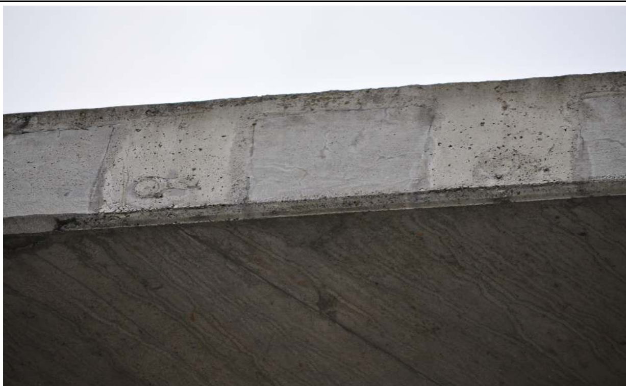
Fot. 10 Widok na zachodnią krawędź zadaszenia. Widoczna korozja oraz zarysowania betonu w strefie zakotwień cięgien sprężających.
