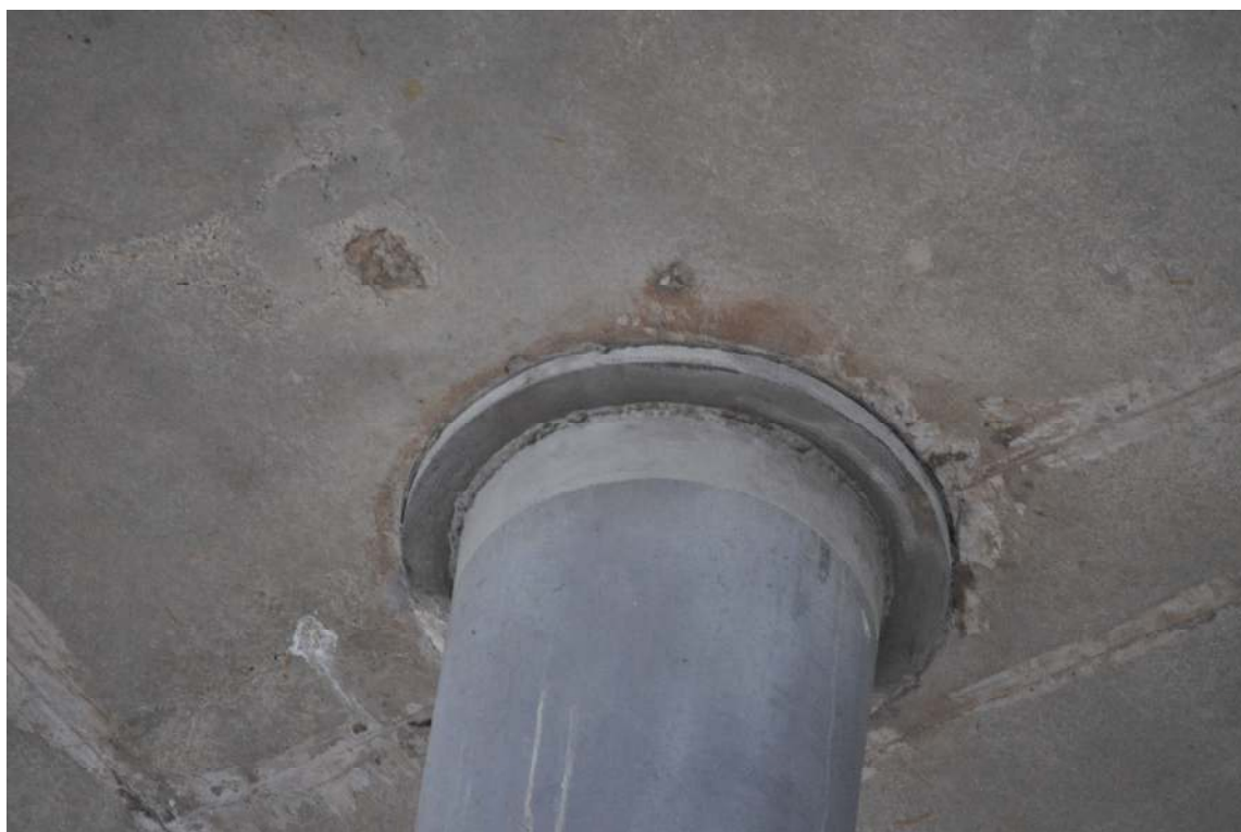
Rys. 5.2. Widok na jeden ze słupów podpierających. Widoczna korozja betonu oraz rdzawe zacieki wokół blachy zamykającej głowicę świadczące o nieszczelności lub zniszczeniu izolacji zadaszenia.
