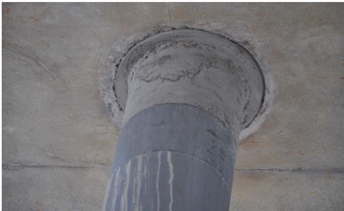
Fot. 13 Widok na strefę połączenia jednego ze słupów z płytą zadaszenia. Widoczne spekania i zniszczenia powierzchni antykorozyjnej słupa w górnej części.
