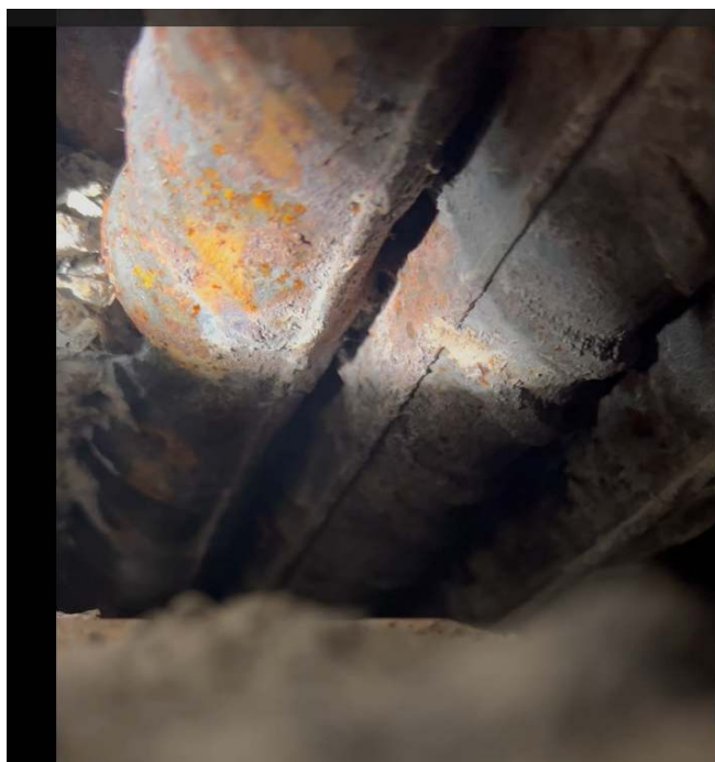
Fot. 3 Widok od spodu na zadaszenie przystanku. Widoczne zniszczenie dolnej części płyty zdaszenia skutkujące powstaniem wolnej przestrzeni pomiędzy spodem płyty a zbrojeniem dolnym.
