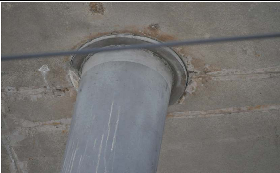
Fot. 7 Widok od spodu w strefie jednego ze słupów podpierających. Widoczne rdzawe zacieki na obwodzie blachy zamykającej głowicę, świadczące o nieszczelności lub braku izolacji płyty zadaszzenia.
