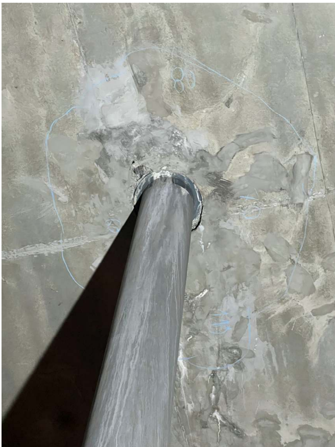
Rys. 5.3. Widok na płytę zadaszeni od spodu, w strefie słupa S4. Widoczne “wbicie” stalowego słupa w płytę zadasznia oraz zakres zinwentaryzowanej pustki powietrznej.
