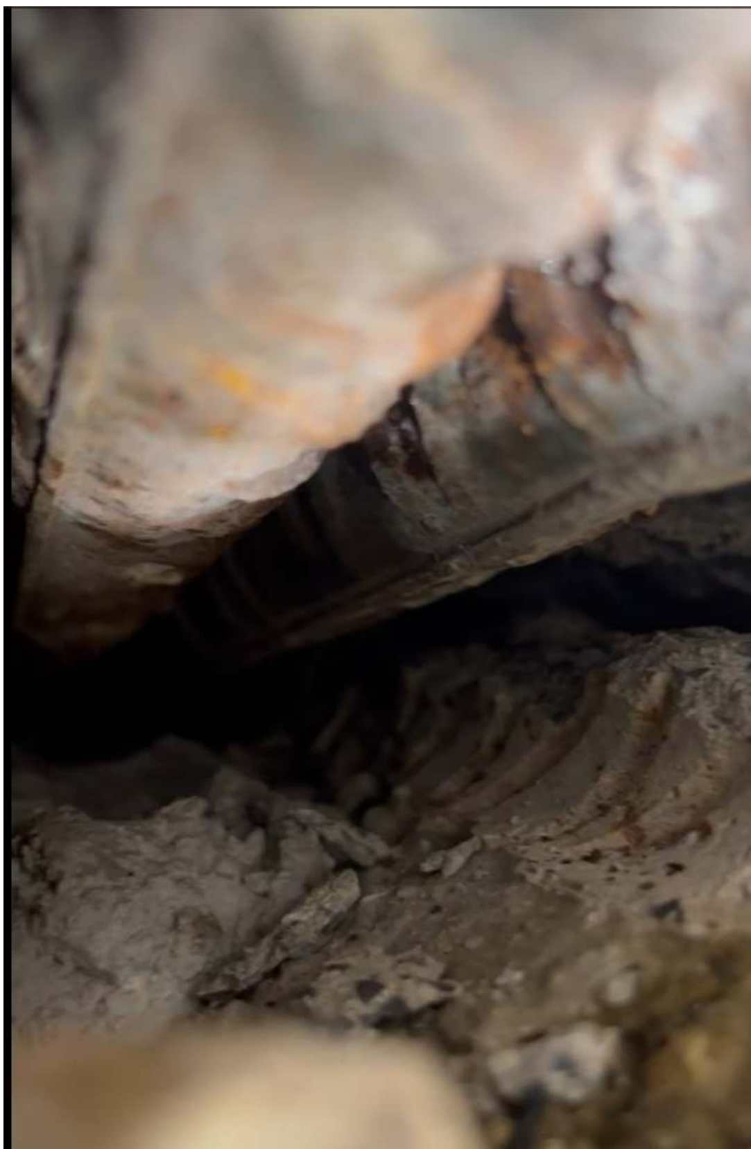
Rys. 5.5. Widok na strefę “wbicia” słupa S4 w powierzchnię płyty zadaszenia. Widoczny zakres “kieszeni” powietrznej oraz odposojenie zbrojenia dolnego płyty od otuliny.
