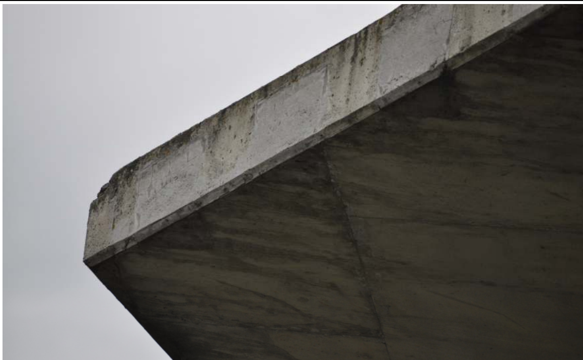
Fot. 11 Widok na krawędź zadaszenia od strony północnej. Widoczna korozja, ubytki oraz zacieki na powierzchni betonu.
